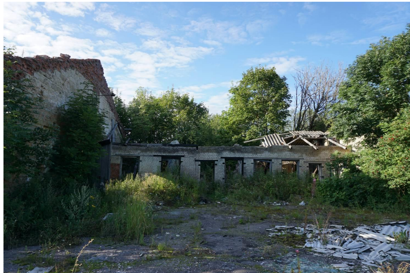
Фото 74. Объект культурного наследия регионального значения «Мыза Лапинская: господский дом, гостевой флигель, хозяйственная постройка дворового каре, фрагмент ограды дворового каре, южная ограда переднего въезда во дворовое каре, плодовый усадебный сад 5 га, природный ландшафт, оформленный при усадебном строительстве (склон ложбины и шлейф глинта, посадки декоративного кустарника, аллеи, руины мельницы на роднике 40 га)», по адресу: Ленинградская область, Ломоносовский муниципальный район, д. Вильповицы. Общий вид объекта культурного наследия «Молочный дом с коровником» в северном направлении. Оконный проем. Переход, соединяющий молочный дом с коровником. Август 2020 года. Автор фотографии: Союров И.В.
