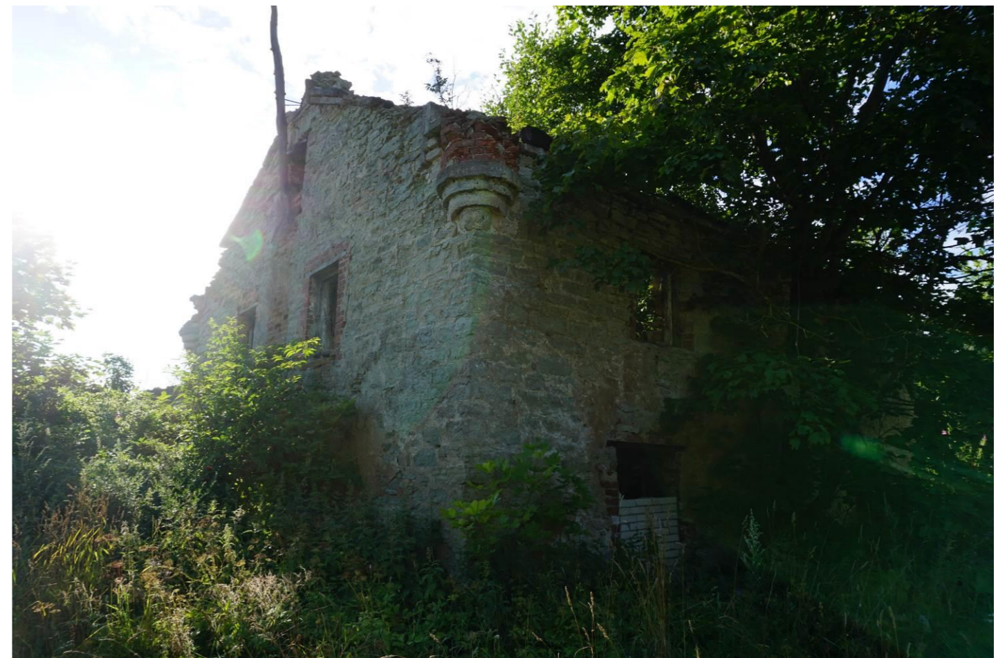
Фото 77. Объект культурного наследия регионального значения «Мыза Лапинская: господский дом, гостевой флигель, хозяйственная постройка дворового каре, фрагмент ограды дворового каре, южная ограда переднего въезда во дворовое каре, плодовый усадебный сад 5 га, природный ландшафт, оформленный при усадебном строительстве (склон ложбины и шлейф глинта, посадки декоративного кустарника, аллеи, руины мельницы на роднике 40 га)», по адресу: Ленинградская область, Ломоносовский муниципальный район, д. Вильповицы. Общий вид объекта культурного наследия «Молочный дом с коровником» в северо-западном направлении. Оконный проем. Треугольный щипец с пинаклями по углам. Август 2020 года. Автор фотографии: Союров И.В.
