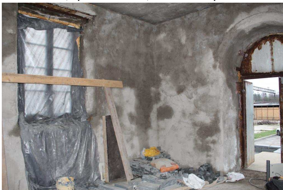
5. Объект культурного наследия регионального значения «Станционная водонапорная башня, 1917 г.» по адресу: Ленинградская область, Всеволожский район, г.п. Токсово, Привокзальная пл., д. 2Б. Внутренний вид помещения.
