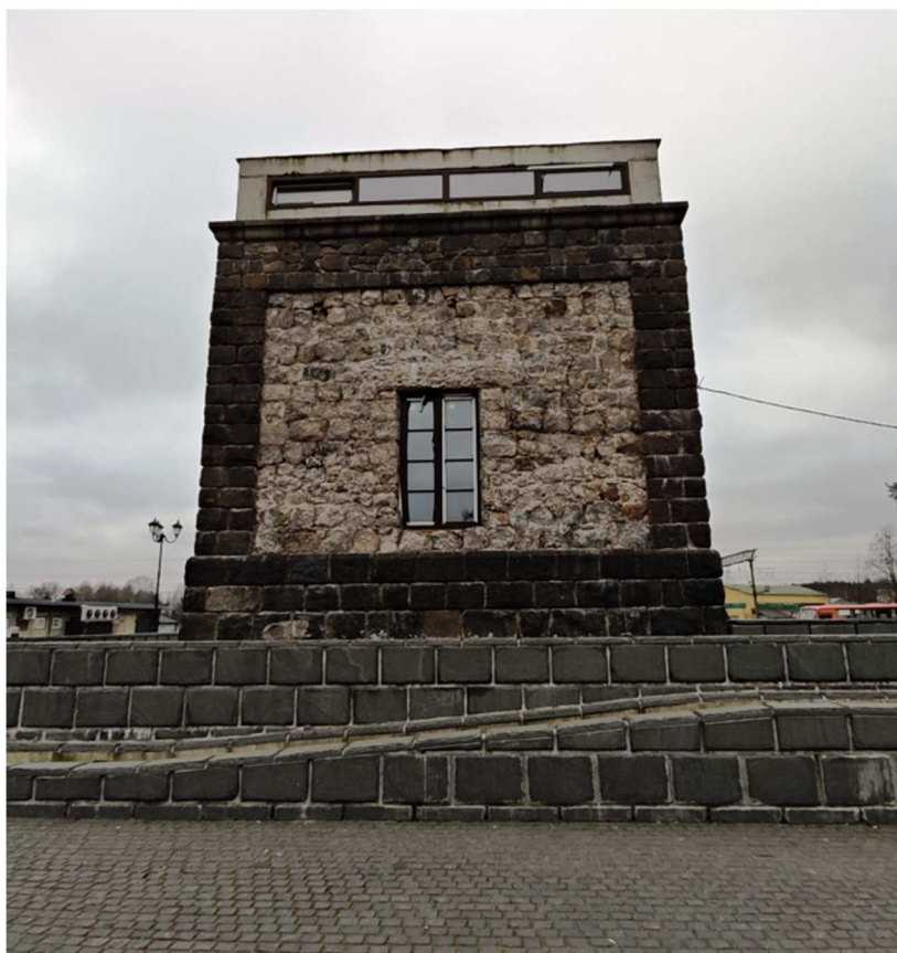
3. Объект культурного наследия регионального значения «Станционная водонапорная башня, 1917 г.» по адресу: Ленинградская область, Всеволожский район, г.п. Токсово, Привокзальная пл., д. 2Б. Восточный фасад.
