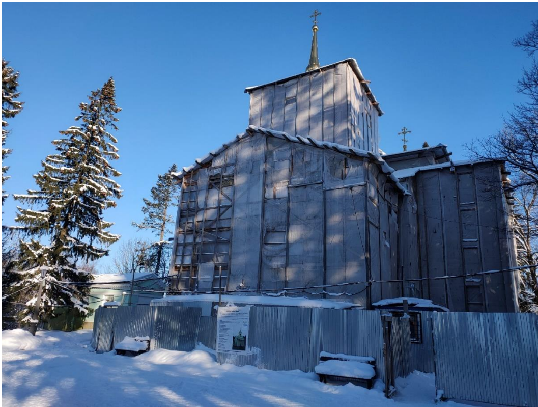
1. «Часовня над могилой графа П. П. Шувалова, 1906 г.», Ленинградская область, Всеволожский район, Агалатовское сельское поселение, д. Вартемяги, Токсовское шоссе, 5. Храм Святой мученицы Софии рядом с часовней. Общий вид с юга. Фото 18.01.2021 г.
