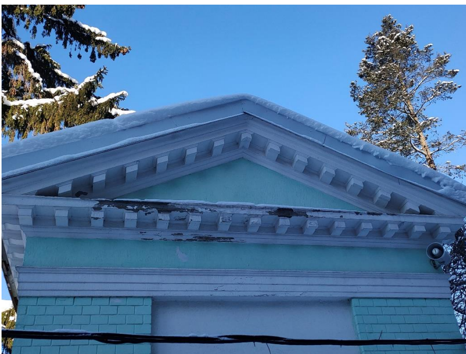
8. «Часовня над могилой графа П. П. Шувалова, 1906 г.», Ленинградская область, Всеволожский район, Агалатовское сельское поселение, д. Вартемяги, Токсовское шоссе,5. Юго-восточный фасад. Фрагмент. Фото 18.01.2021 г.
