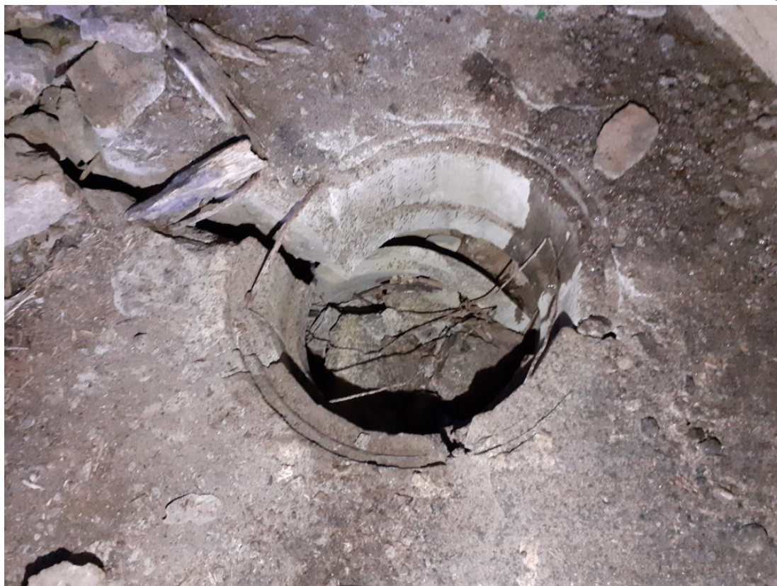
5. Дренажный колодец в главной галерее ДОТ
