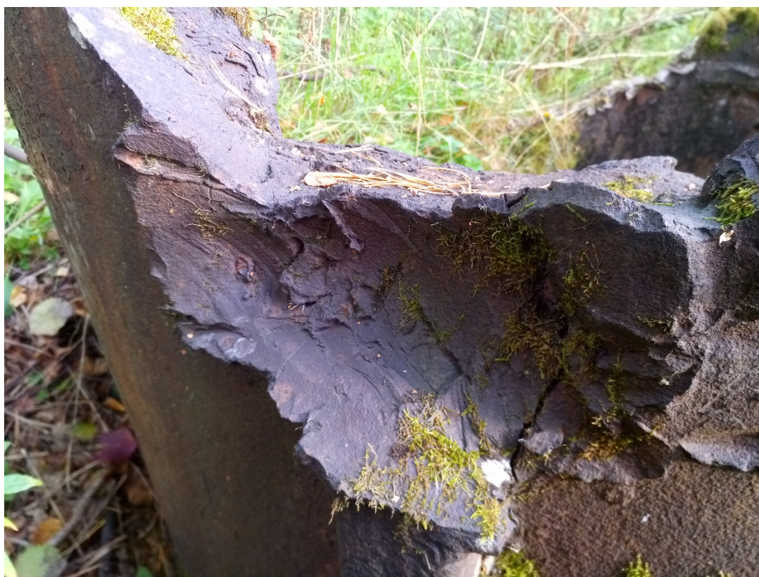
Вид на след от попадания тяжёлого снаряда в бронекупол на полукапонире на 1 пулемёт №10, укреплённый район Мялкёля.
