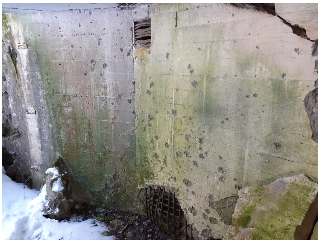
6. Повреждённая подрывом система вентиляции ДОТ.
