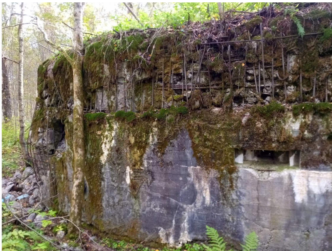
Общий вид на заднюю стену капонира №28 на два пулемёта, укреплённый район Мьякёля. Хорошо видна сохранившаяся амбразура для ручного пулемёта.
