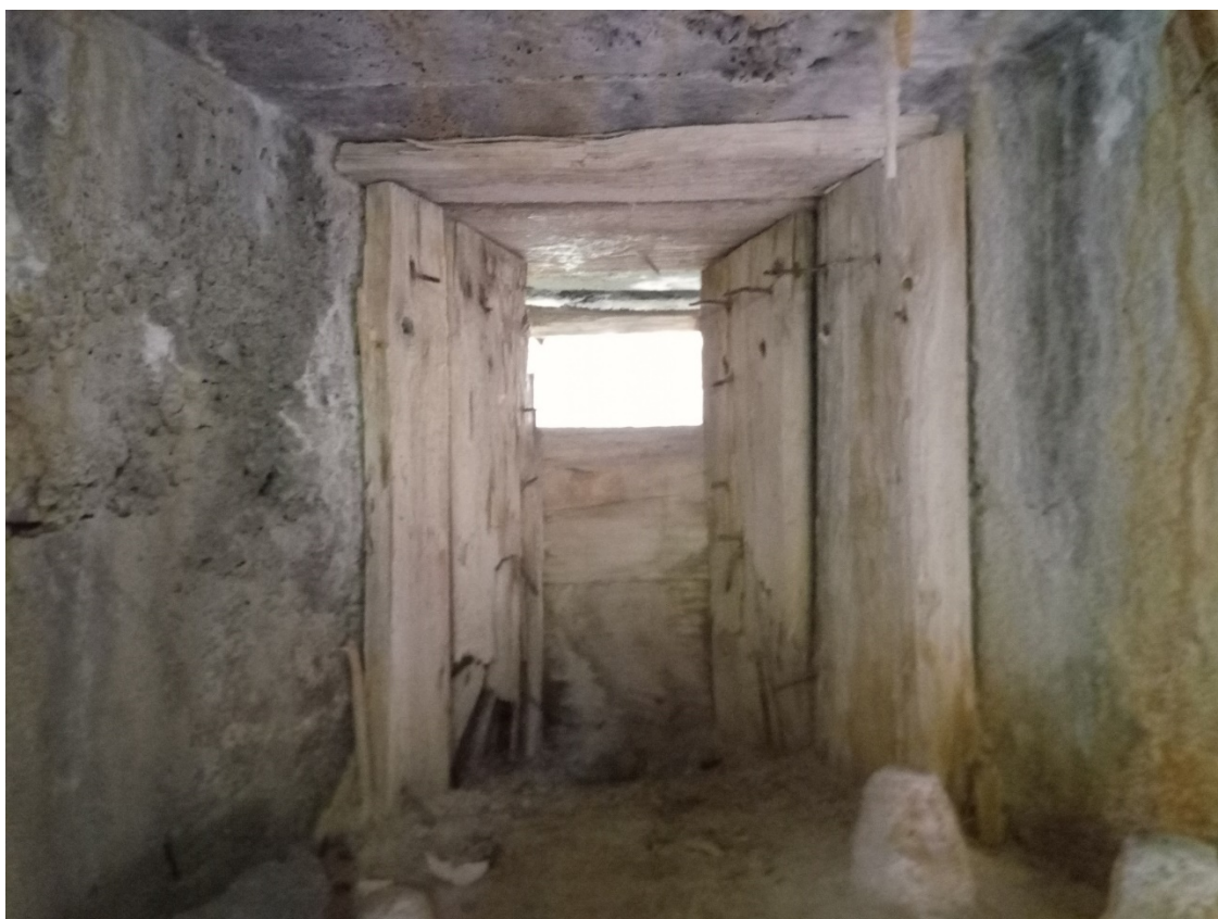
Сохранившаяся деревянная опалубка на амбразуре для ручного пулемёта капонира №28 на два пулемёта, укрепленный район Мьякёля.
