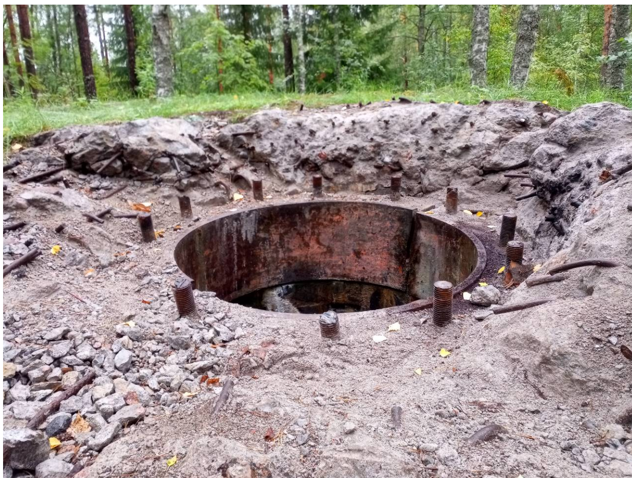
Рисунок 26. То же сооружение в конце августа 2020 года. Бронекупол демонтирован вандалами для сдачи в металлолом, арматура срезана.
