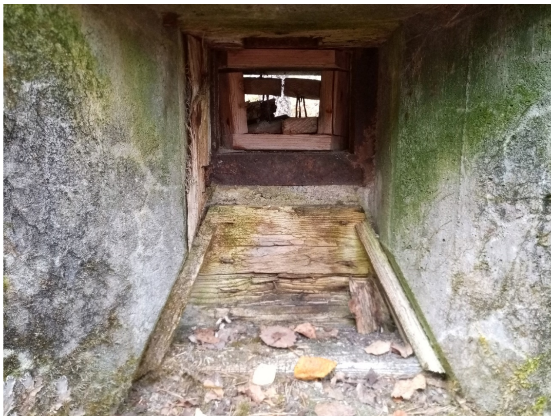
Сохранившаяся опалубка отливки амбразуры под ручной пулемет, недостроенное типовое убежище №51, укрепленный район Мялкёля. Вид изнутри.
