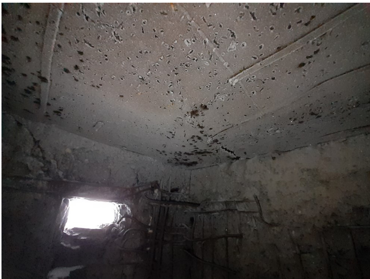
4. Вид на подорванную амбразуру изнутри
