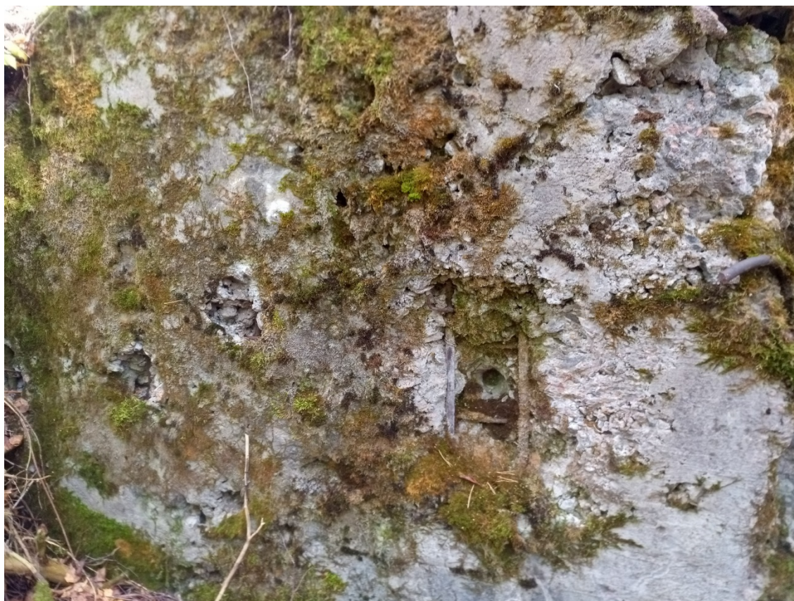
След попадания танкового снаряда и некачественная отливка бетона на стене полукапонира на один пулемёт №14 укрепрайона Мялкёля
