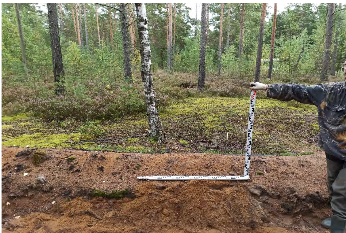
Рис.128. Ленинградская область, объект «Строительство кабельной волоконно-оптической линии связи мультисервисной транспортной сети связи Балтийского флота в направлении: УС 571-Д – объект 81809». Зачистка №6. Общий вид после рекультивации. Вид с запада.
