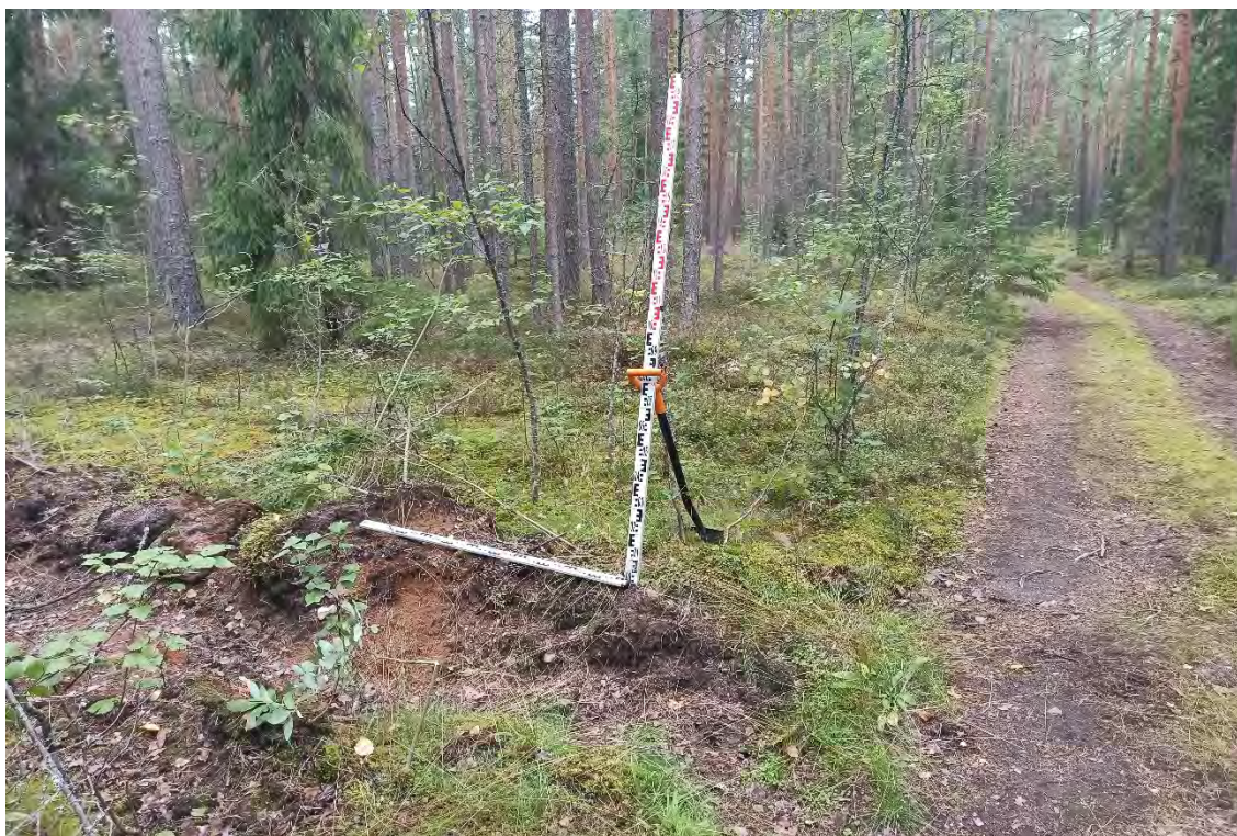
Рис.79. Ленинградская область, объект «Строительство кабельной волоконно-оптической линии связи мультисервисной транспортной сети связи Балтийского флота в направлении: УС 571-Д – объект 81809». Зачистка №2. Общий вид перед началом работ. Вид с востока.
