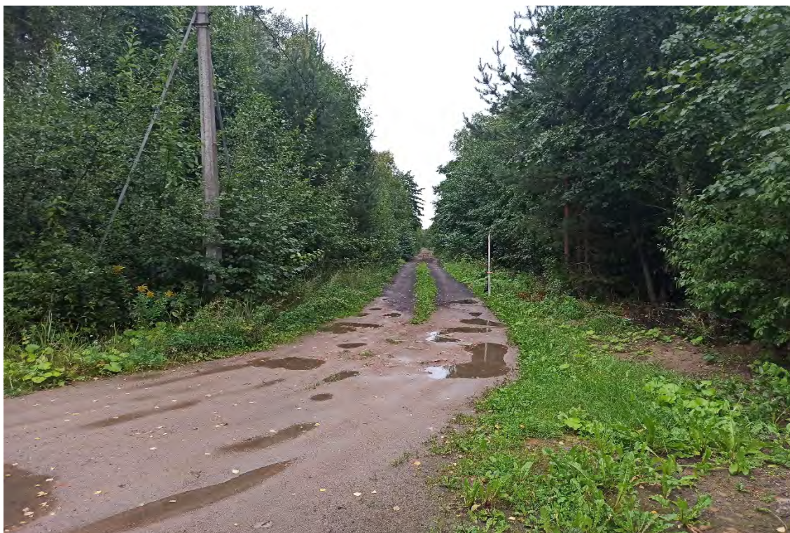
Рис.91. Ленинградская область, объект «Строительство кабельной волоконно-оптической линии связи мультисервисной транспортной сети связи Балтийского флота в направлении: УС 571-Д – объект 81809». ТФ №9. Проектируемая трасса ВОЛС. Вид с запада.
