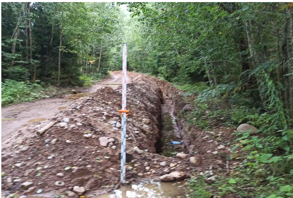
Рис.228. Ленинградская область, объект «Строительство кабельной волоконно-оптической линии связи мультисервисной транспортной сети связи Балтийского флота в направлении: УС 571-Д – объект 81809». ТФ №42. Проектируемая трасса ВОЛС. Участок с уже проложенным кабелем. Вид с севера-северо-запада.
