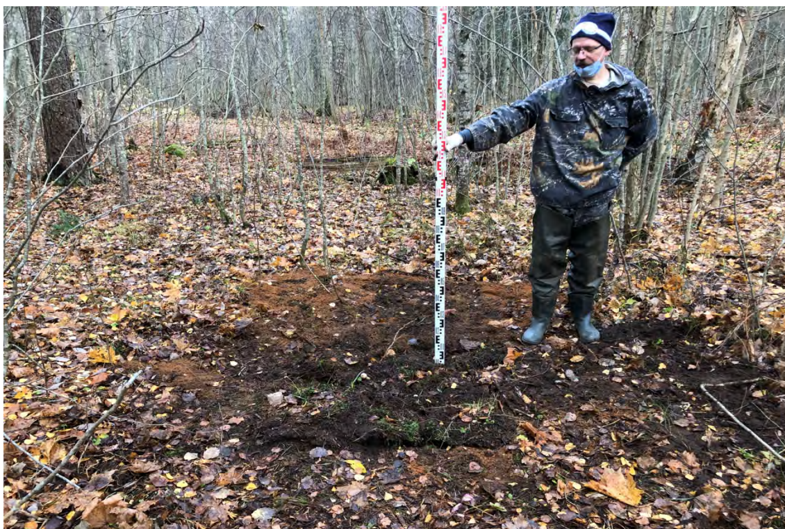
Рис.50. Ленинградская область, объект «Строительство кабельной волоконно-оптической линии связи мультисервисной транспортной сети связи Балтийского флота в направлении: УС 571-Д – объект 81809». Шурф № 2. После рекультивации. Вид с юга.
