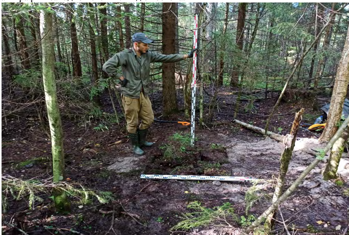
Рис.284. Ленинградская область, объект «Строительство кабельной волоконно-оптической линии связи мультисервисной транспортной сети связи Балтийского флота в направлении: УС 571-Д – объект 81809». Шурф №18. Общий вид шурфа после рекультивации. Вид с юга.
