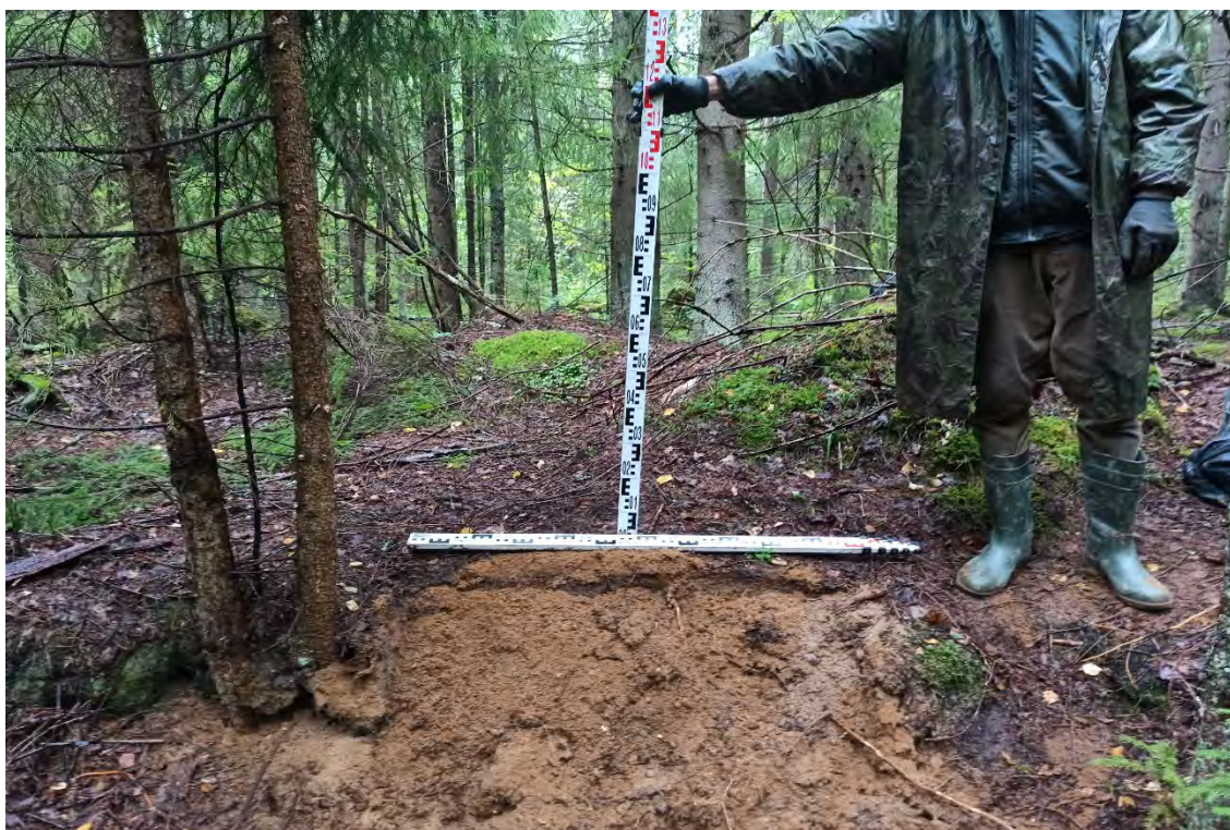
Рис.205. Ленинградская область, объект «Строительство кабельной волоконно-оптической линии связи мультисервисной транспортной сети связи Балтийского флота в направлении: УС 571-Д – объект 81809». Зачистка №11. Общий вид после рекультивации. Вид с востока.
