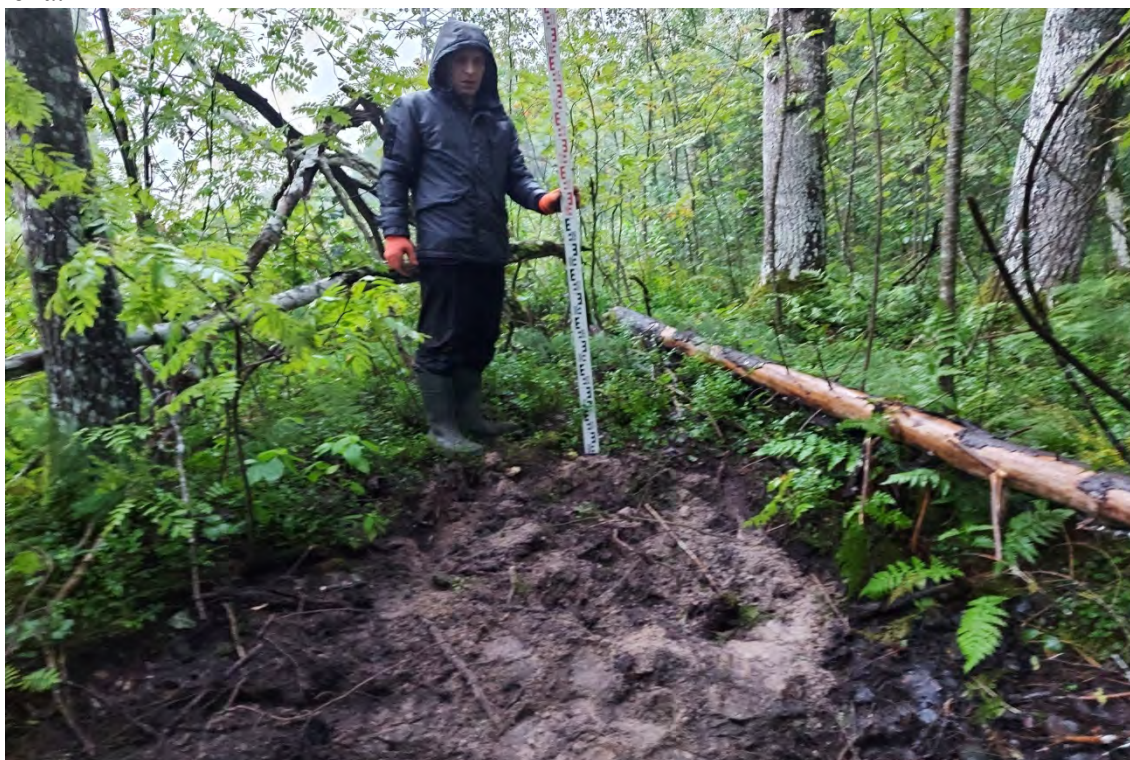
Рис.344. Ленинградская область, объект «Строительство кабельной волоконно-оптической линии связи мультисервисной транспортной сети связи Балтийского флота в направлении: УС 571-Д – объект 81809». Зачистка №25. После рекультивации. Вид с юго-востока.
