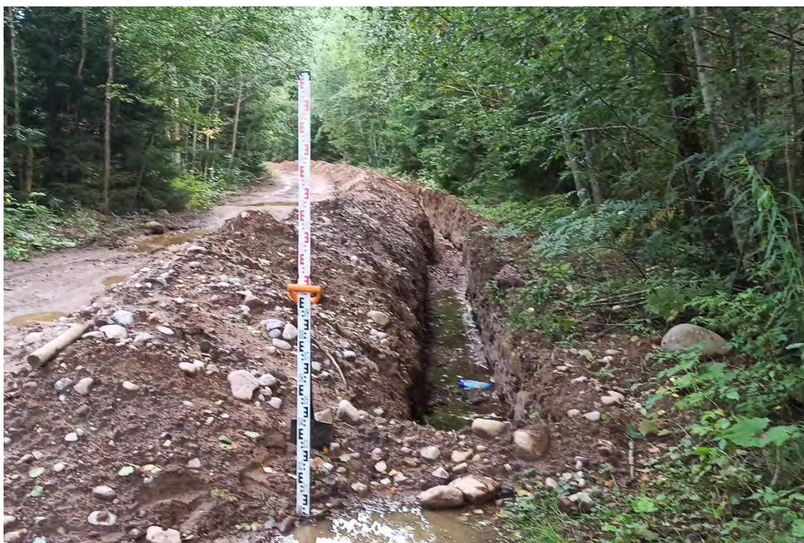
Рис.231. Ленинградская область, объект «Строительство кабельной волоконно-оптической линии связи мультисервисной транспортной сети связи Балтийского флота в направлении: УС 571-Д – объект 81809». Зачистка №18. Месторасположение. Вид с юго-востока.
