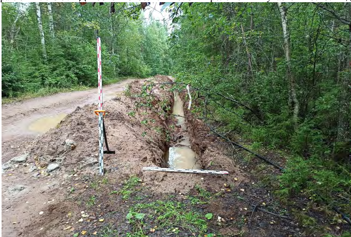
Рис.214. Ленинградская область, объект «Строительство кабельной волоконно-оптической линии связи мультисервисной транспортной сети связи Балтийского флота в направлении: УС 571-Д – объект 81809». ТФ №35. Проектируемая трасса ВОЛС. Участок с уже проложенным кабелем. Вид с северо - северо - запада.
