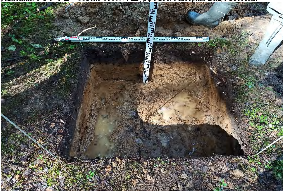
Рис.268. Ленинградская область, объект «Строительство кабельной волоконно-оптической линии связи мультисервисной транспортной сети связи Балтийского флота в направлении: УС 571-Д – объект 81809». Шурф №16. Контрольный прокоп материка. Вид с востока.
