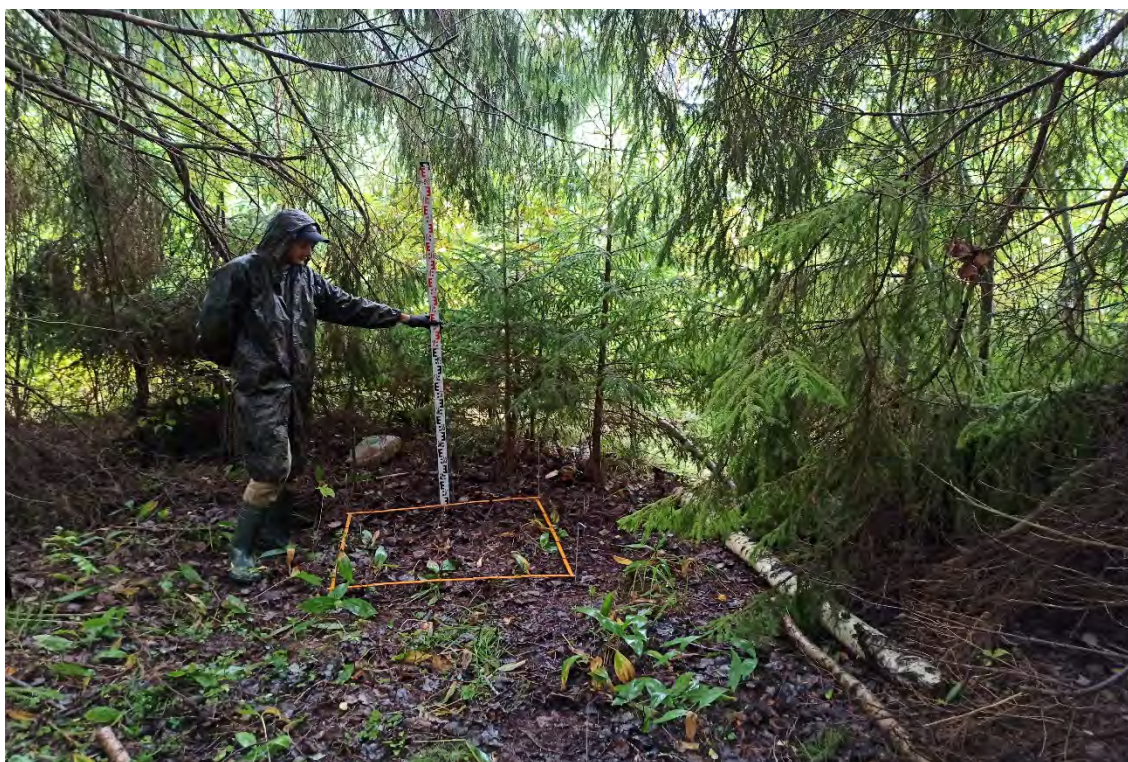
Рис.301. Ленинградская область, объект «Строительство кабельной волоконно-оптической линии связи мультисервисной транспортной сети связи Балтийского флота в направлении: УС 571-Д – объект 81809». Шурф №21. Общий вид перед началом работ. Вид с севера.
