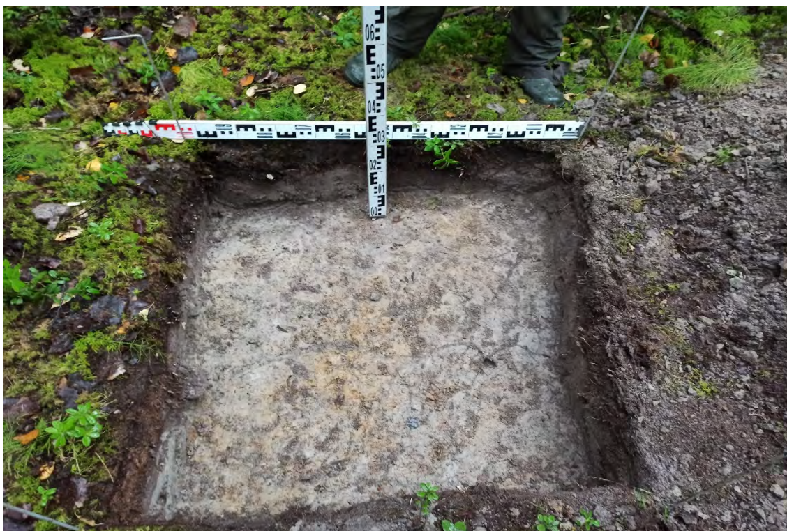
Рис.156. Ленинградская область, объект «Строительство кабельной волоконно-оптической линии связи мультисервисной транспортной сети связи Балтийского флота в направлении: УС 571-Д – объект 81809». Шурф №9. Материк. Вид с запада.
