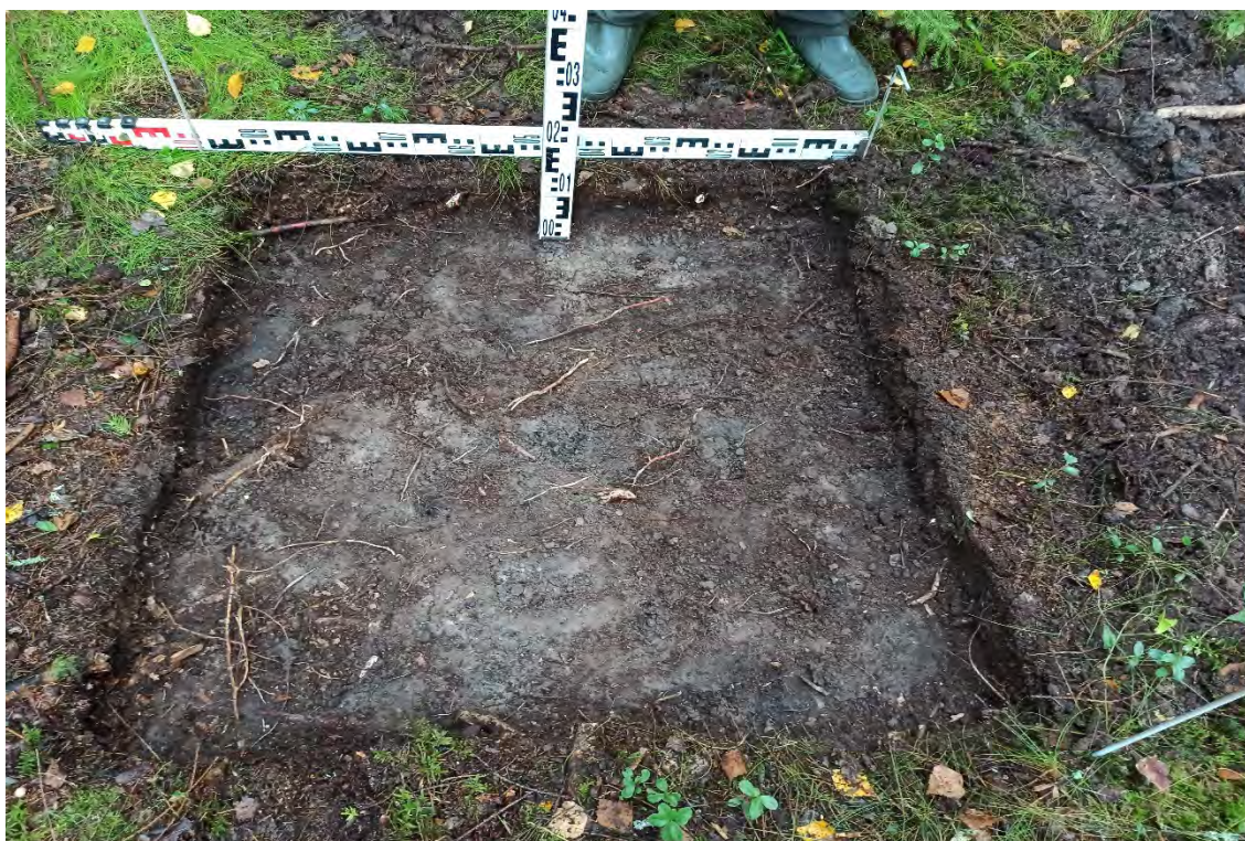
Рис.170. Ленинградская область, объект «Строительство кабельной волоконно-оптической линии связи мультисервисной транспортной сети связи Балтийского флота в направлении: УС 571-Д – объект 81809». Шурф №11. После снятия дерна. Вид с юга.
