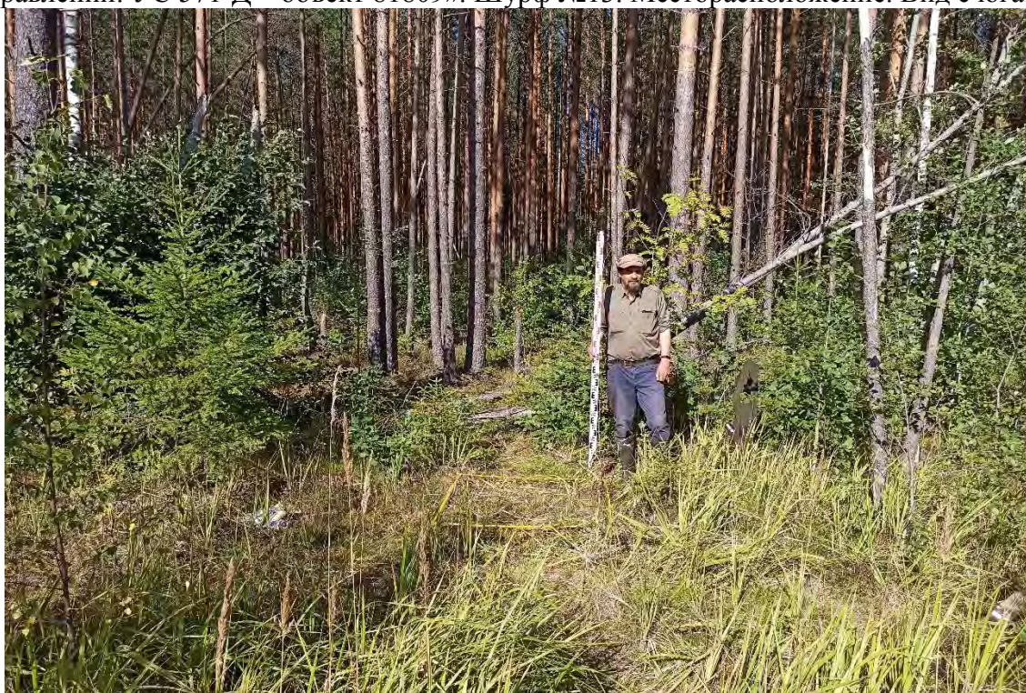
Рис.244. Ленинградская область, объект «Строительство кабельной волоконно-оптической линии связи мультисервисной транспортной сети связи Балтийского флота в направлении: УС 571-Д – объект 81809». Шурф №13. Общий вид перед началом работ. Вид с юга.
