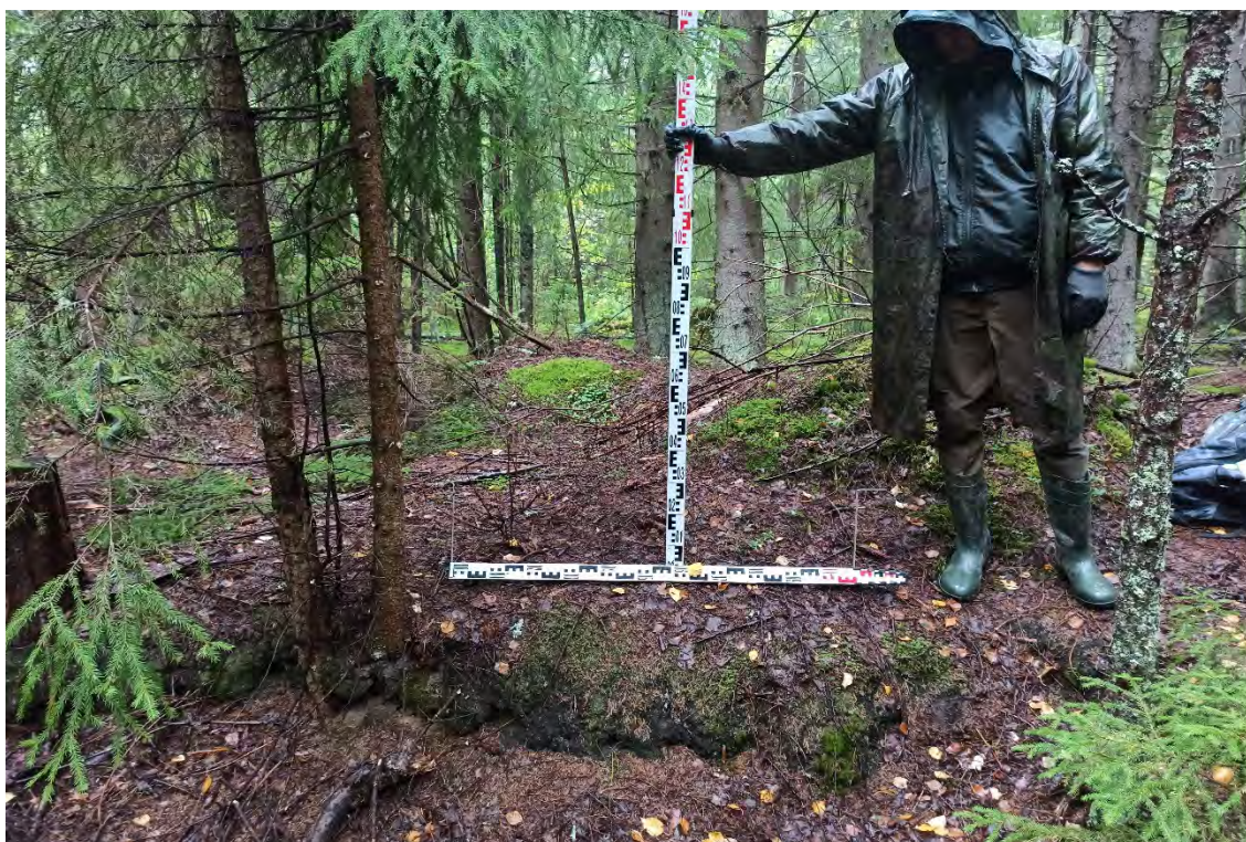
Рис.203. Ленинградская область, объект «Строительство кабельной волоконно-оптической линии связи мультисервисной транспортной сети связи Балтийского флота в направлении: УС 571-Д – объект 81809». Зачистка №11. Общий вид перед началом работ. Вид с востока.
