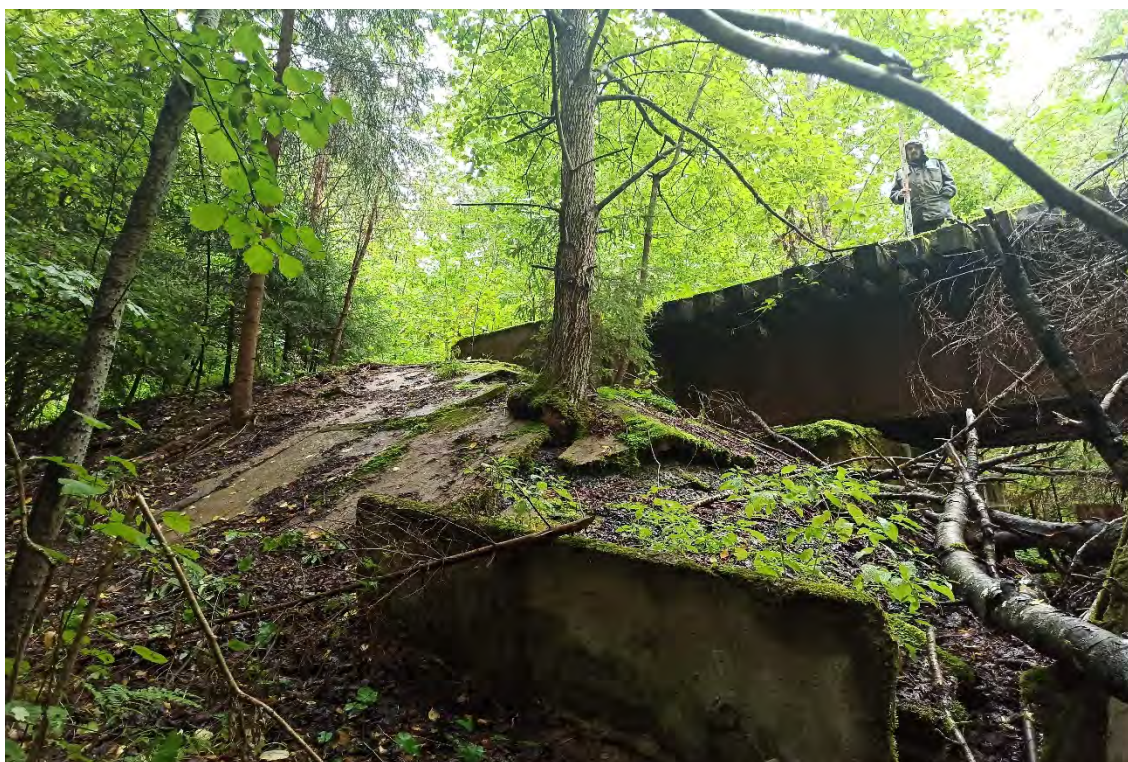
Рис.100. Ленинградская область, объект «Строительство кабельной волоконно-оптической линии связи мультисервисной транспортной сети связи Балтийского флота в направлении: УС 571-Д – объект 81809». ТФ №15. Проектируемая трасса ВОЛС. Вид с северо - запада.
