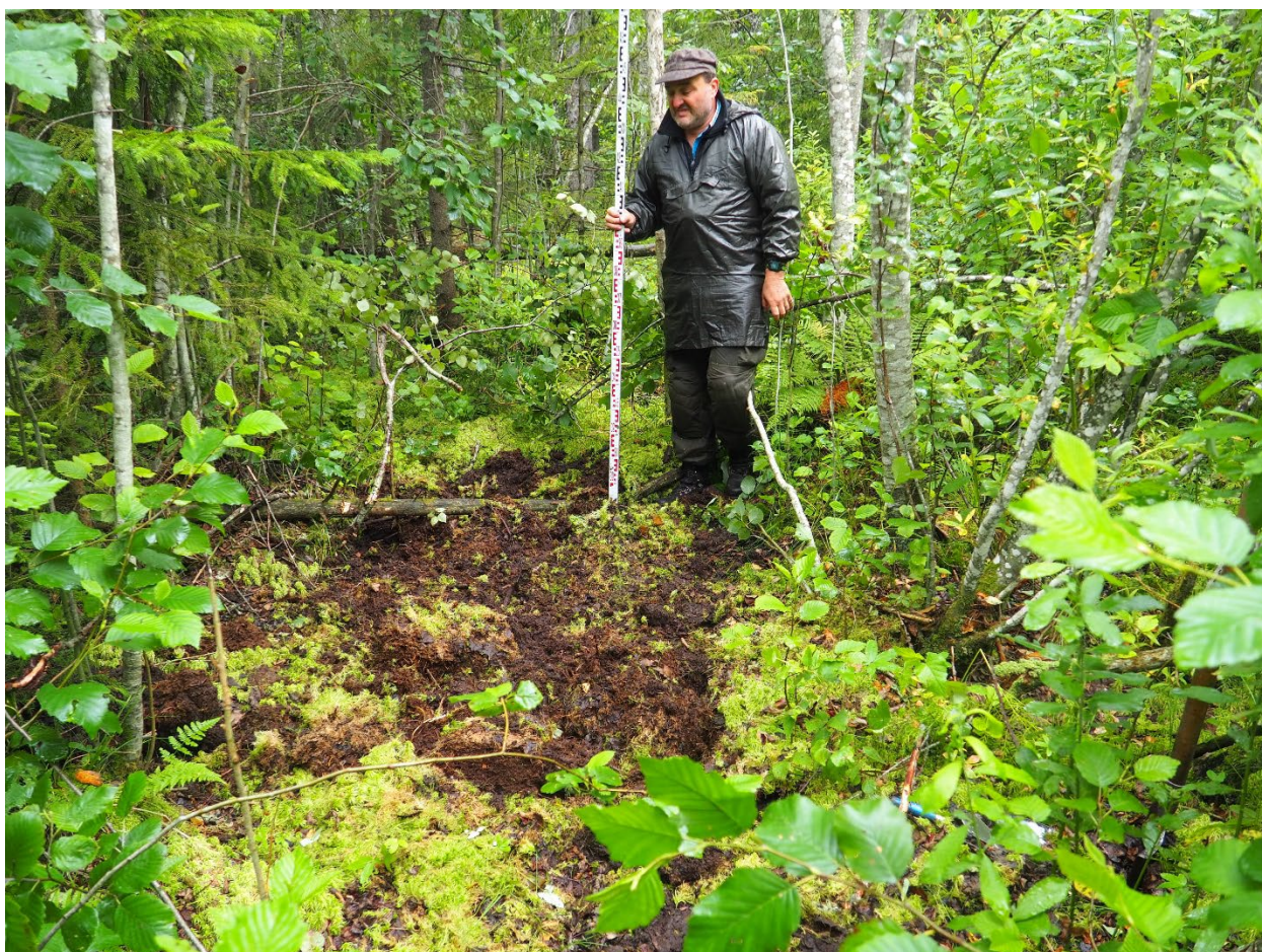
Рис. 30. Ленинградская обл., Волосовский р-н, участок обследования. Шурф 2. Рекультивация. Вид с севера. Для масштаба использована нивелировочная рейка длиной 1 м. 29.07.2019 г.
