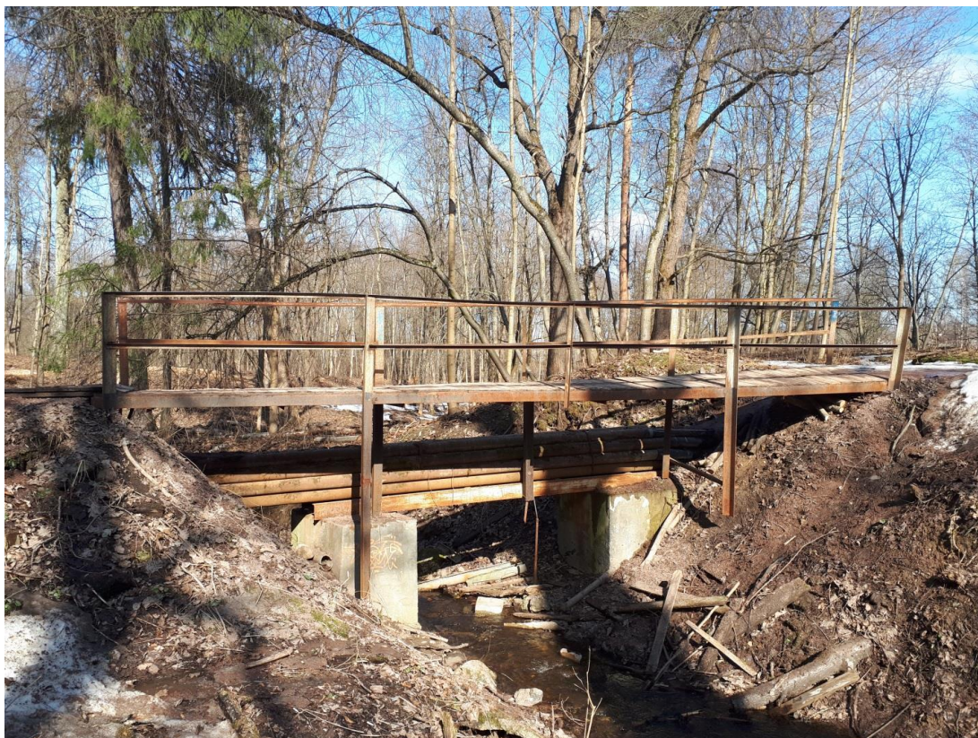
Фото 5. Приоратский парк. Вид на существующий мост и кабели слаботочных сетей. Полетайкин В.В. 24.03.2021.
