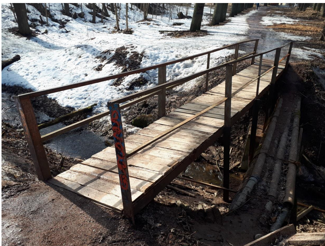
Фото 4. Приоратский парк. Вид на существующий мост и кабели слаботочных сетей, проложенные в металлических гильзах. Полетайкин В.В. 24.03.2021.
