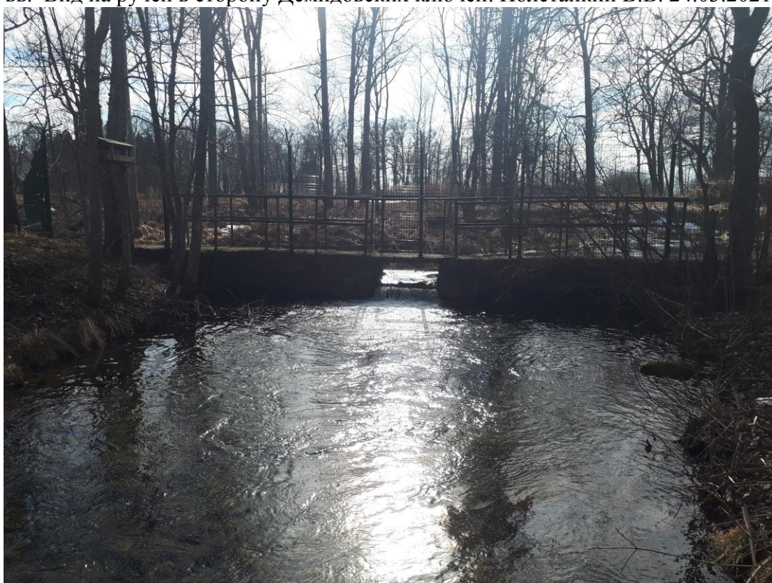
Фото 10. Место устройства переправы (моста) №2 через ручей севернее Горбатого моста. Вид на ручей в сторону Демидовских ключей. Полетайкин В.В. 24.03.2021.
