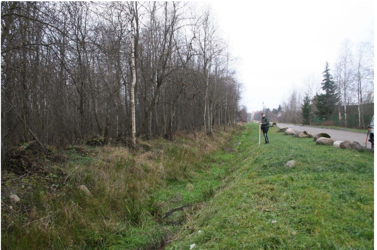
Илл. 23. Ленинградская обл., Кировский р-н, трасса обследования. Точка фотофиксации ф. 4. Общий вид трассы обследования с севера. Для масштаба использована нивелировочная рейка длиной 1 м.
