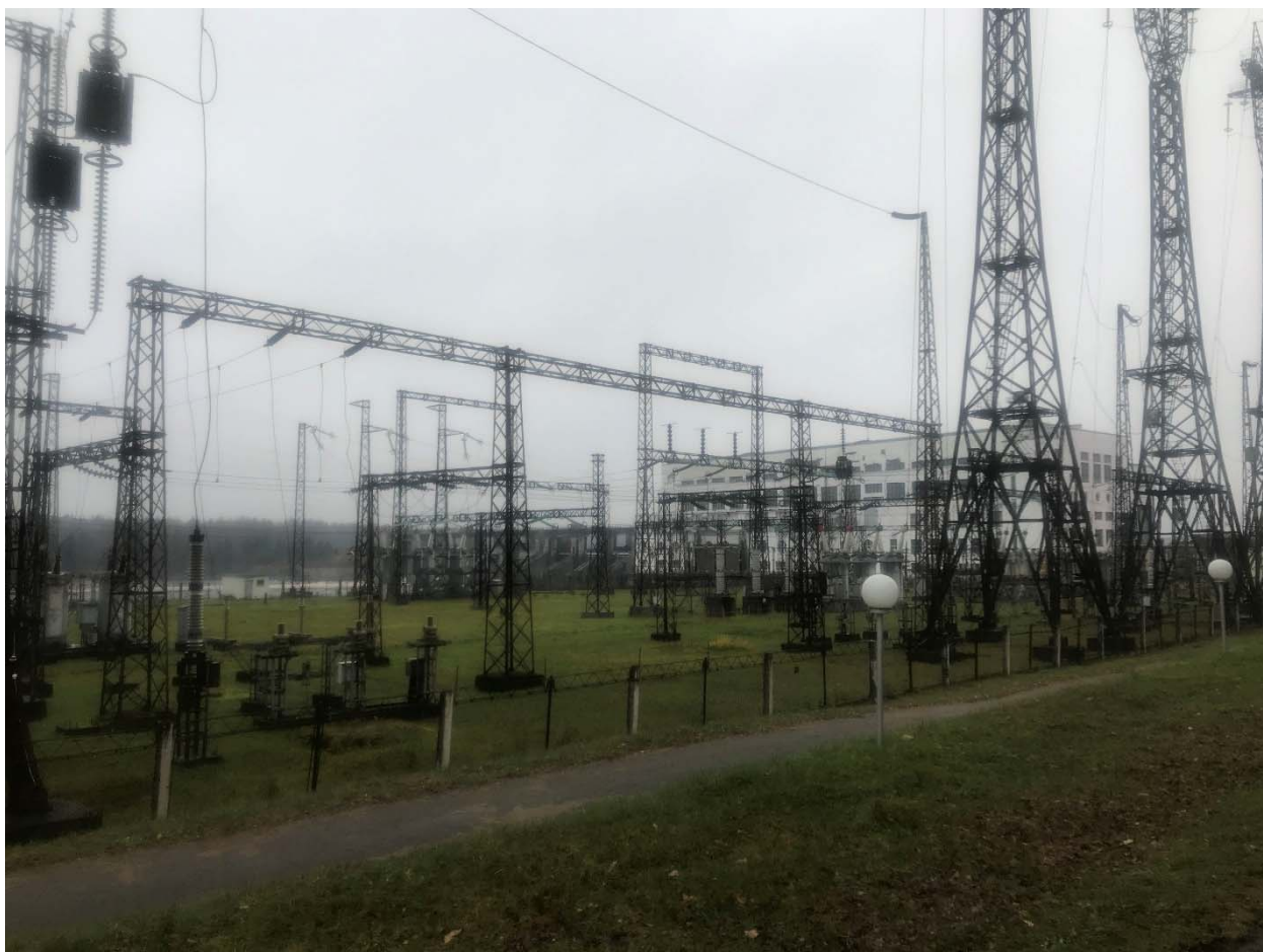
Фото 1. Общий вид на ОРУ и ГЭС с территории острова
