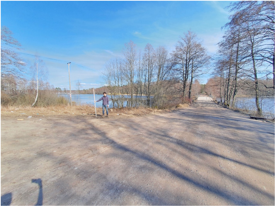
Рис. 16. Ленинградская обл., Выборгский район, «Черничное - Пионерское». Общий вид участка обследования. Точка фотофиксации 4. Вид на восток
