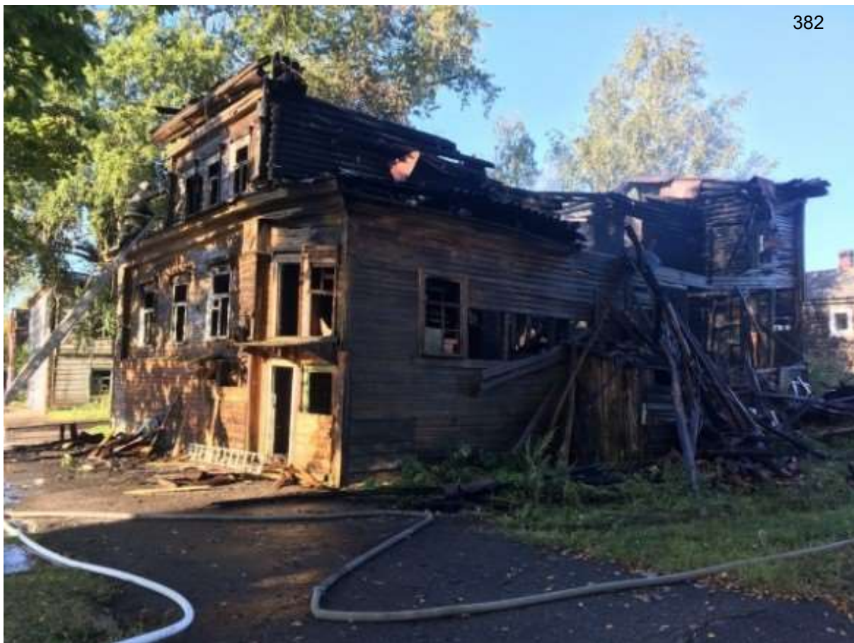
Фото 5.3 Вид после пожара 2018 года
