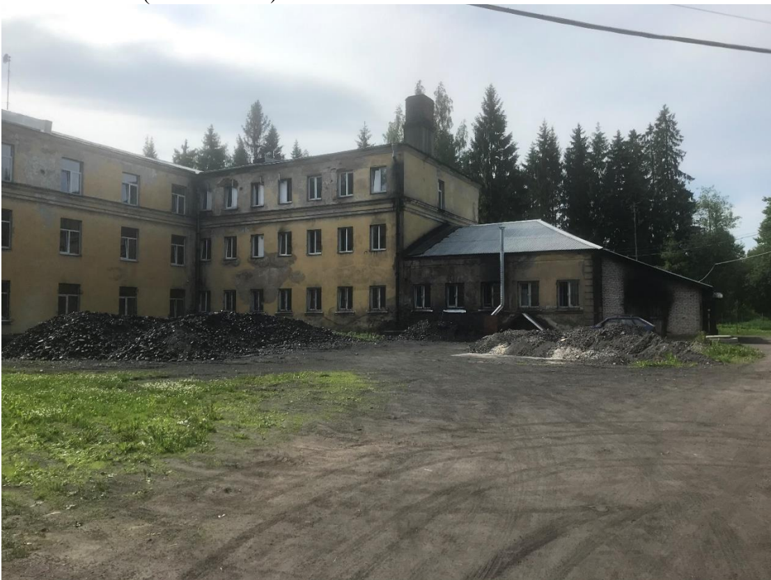
Фото 10. Здание ГКУЗ ЛО «ТБ «Дружноселье», расположенное по адресу: Ленинградская область, Гатчинский район, пос. Дружноселье, ул. Зеленая, д. 1. Вид на дворовой фасад. Фото Рябкова В. А. (июль 2020 г.)
