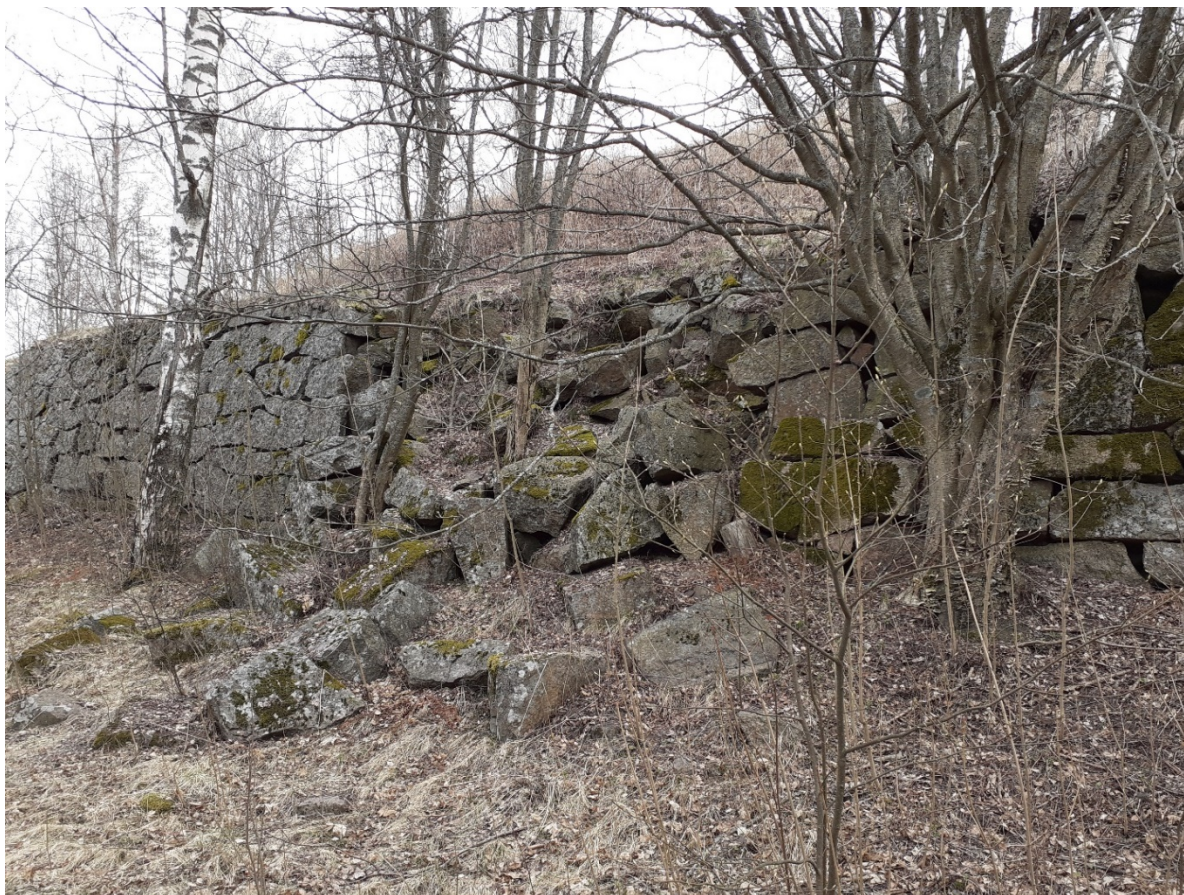
27. Разрушение кладки рва
