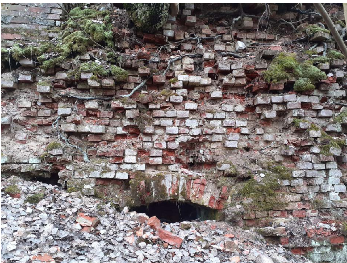
16. Капонир. Вид на сквозное разрушение кирпичной кладки стены
