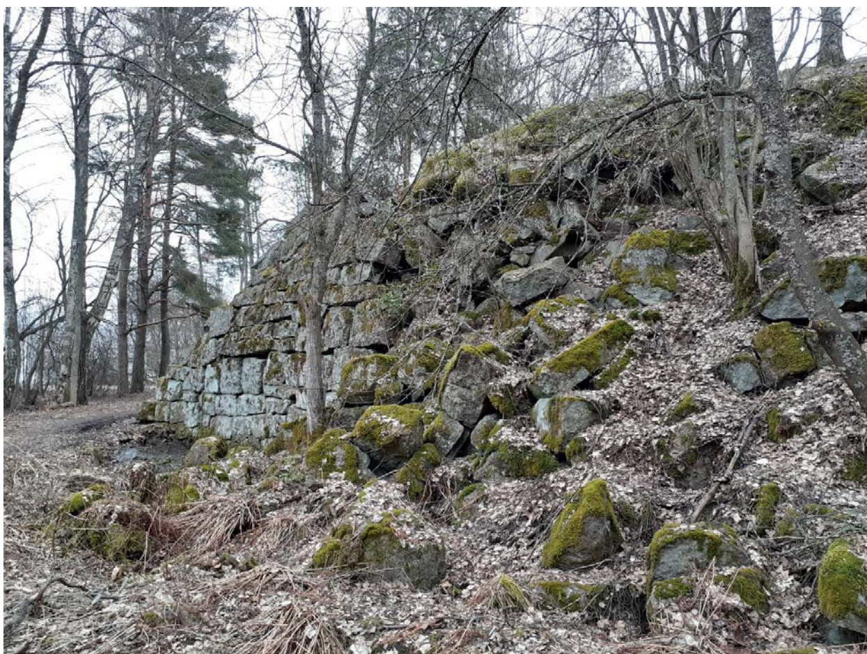
4. Обрушение стены рва
