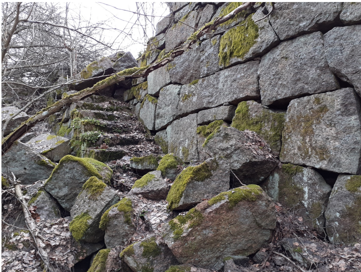
3. Полуразрушенная лестница, ведущая на вал
