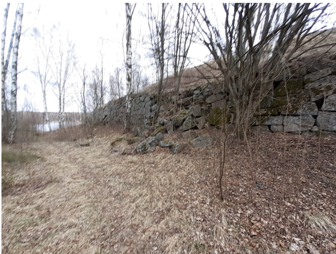
26. Разрушение кладки рва
