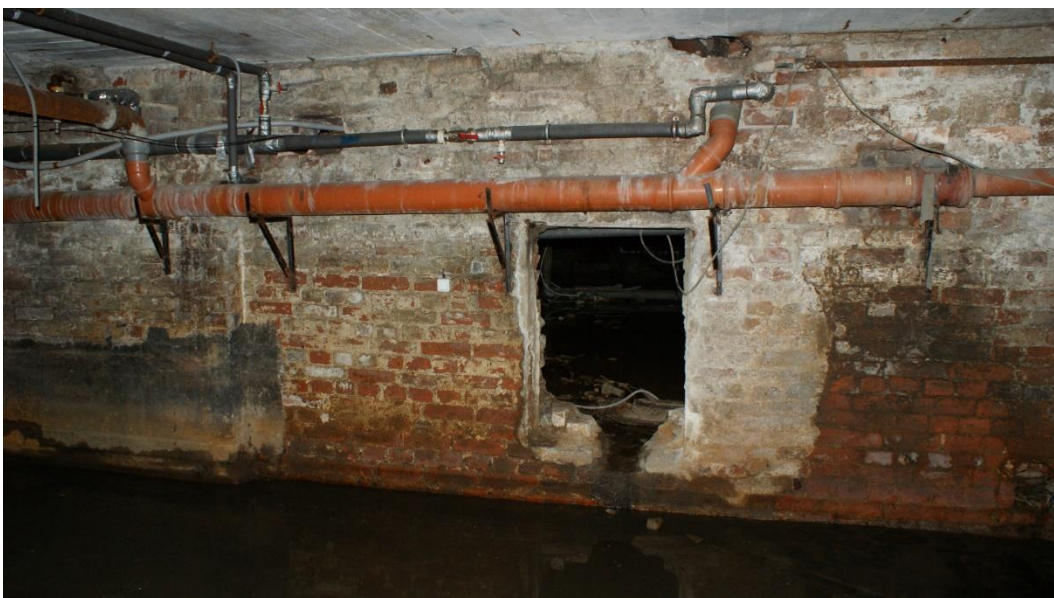
9. «Жилой и торговый дом «Карьяла»». г. Выборг, Ленина пр., д.12/10. Подвал. Фрагмент. Фото 25.05.2021г.
