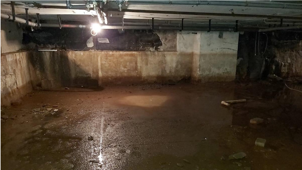
5. «Жилой и торговый дом «Карьяла»». г. Выборг, Ленина пр., д.12/10. Подвал. Общий вид. Фото 25.05.2021г.
