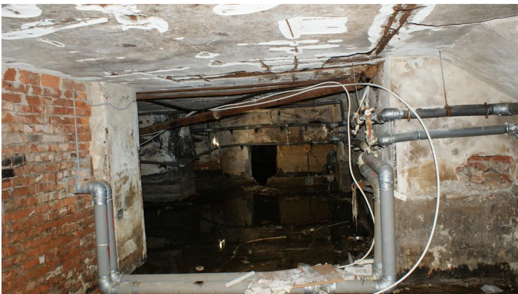
7. «Жилой и торговый дом «Карьяла»». г. Выборг, Ленина пр., д.12/10. Подвал. Общий вид. Фото 25.05.2021г.
