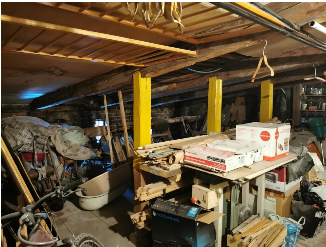
11. «Жилой и торговый дом «Карьяла»». г. Выборг, Ленина пр., д.12/10. Кровля. Общий вид. Фото 25.05.2021г.
