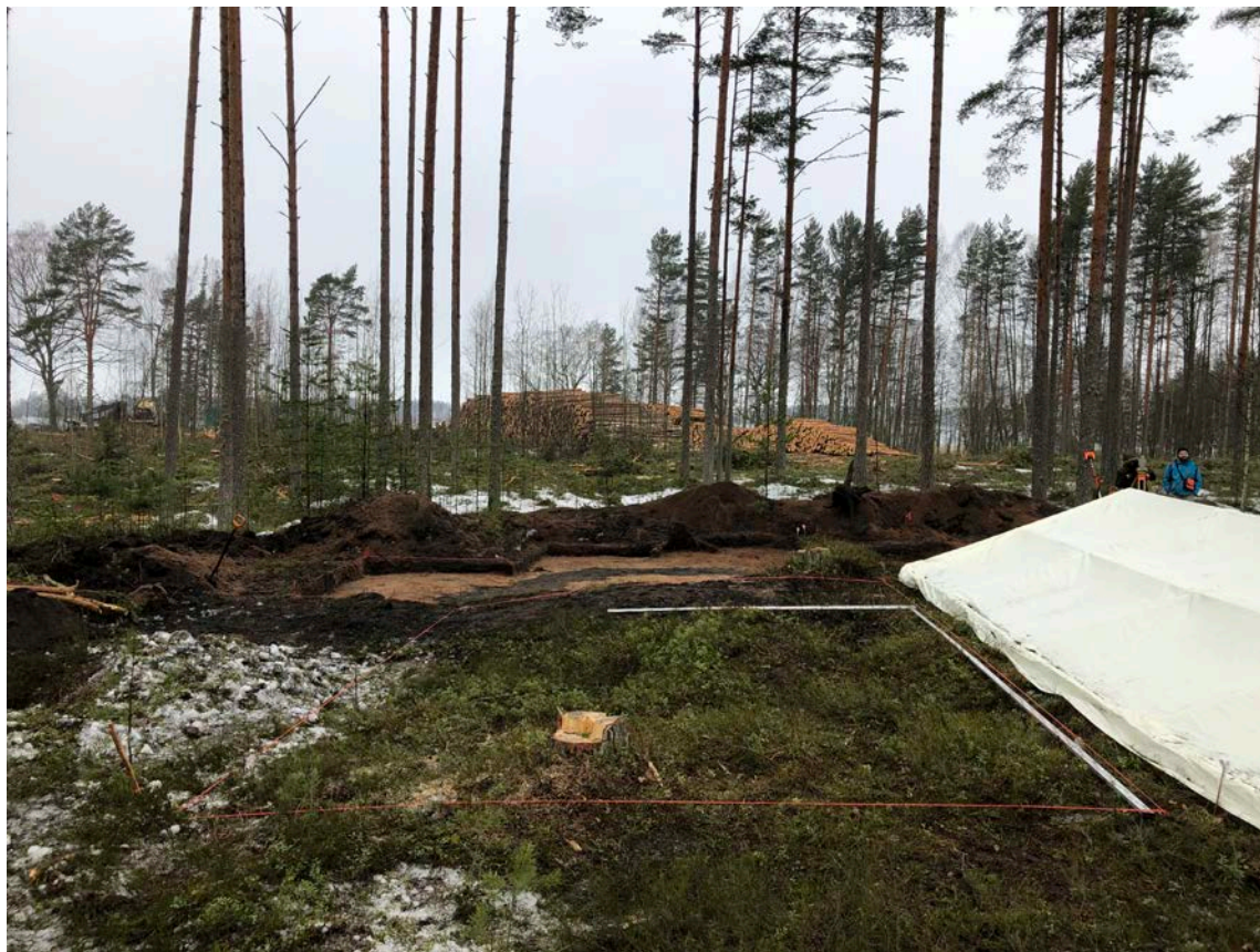
Илл.19. Выборгский район, Порт Высоцкий-1-2021. Сектор 3 перед началом работ. С севера примыкает ангар для отогрева сектора 4. Вид с В.
