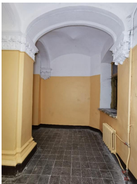
34. «Здание городского музея», г. Выборг, ул. Крепостная, д.2. Подъезд. Общий вид. Фото 25.05.2021г.
