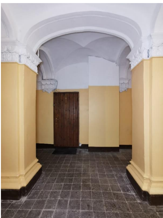
32. «Здание городского музея», г. Выборг, ул. Крепостная, д.2. Подъезд. Общий вид. Фото 25.05.2021г.
