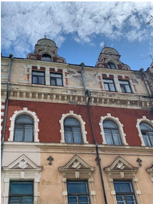
14. «Здание городского музея», г. Выборг, ул. Крепостная, д.2. Северо-западный фасад. Фрагмент. Фото 25.05.2021г.
