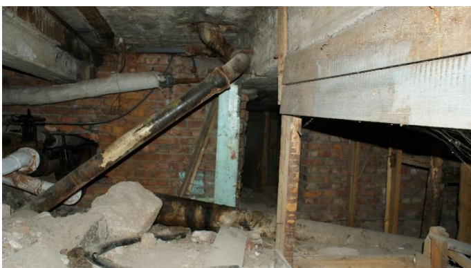
46. «Здание городского музея», г. Выборг, ул. Крепостная, д.2. Подвал. Общий вид. Фото 25.05.2021г.
