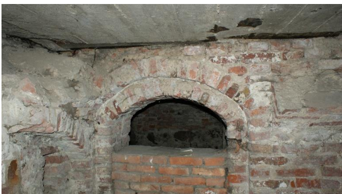
47. «Здание городского музея», г. Выборг, ул. Крепостная, д.2. Подвал. Фрагмент. Фото 25.05.2021г.
