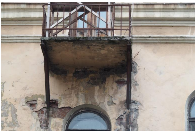
29. «Здание городского музея», г. Выборг, ул. Крепостная, д.2. Дворовый фасад. Фрагмент. Фото 25.05.2021г.
