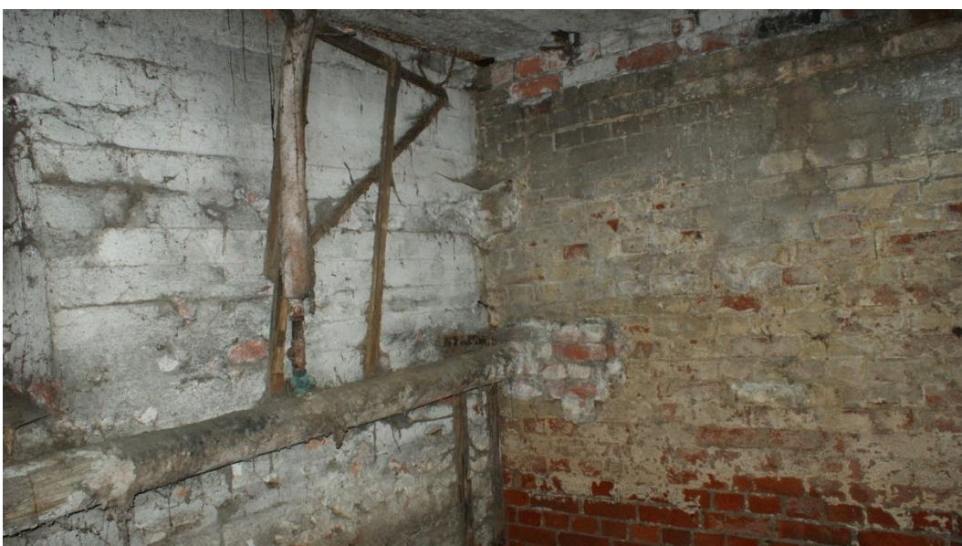
94. «Банк», г. Выборг, пр. Ленина 8А. Подвал. Общий вид. Фото 25.05.2021г.
