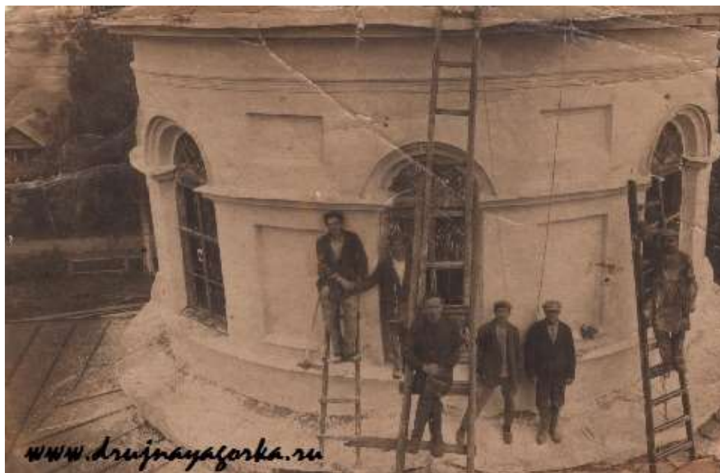
Илл.13. Бригада Дружногорского ремстроя на крыше церкви. Фото периода 1930-х. Источник: www.drujnayagorka.ru
