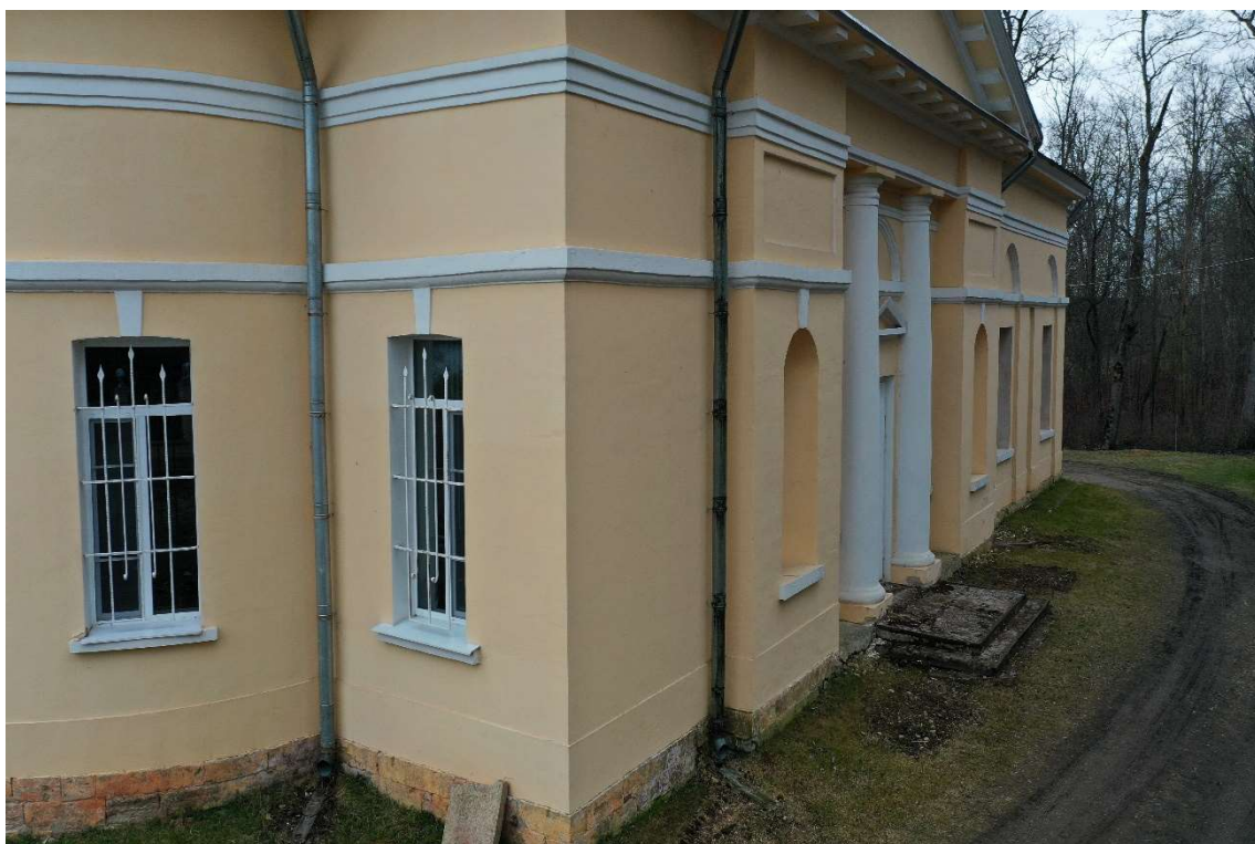
Фото 6. Наземная фотосъемка. Вдоль северного фасада, входы выделены портиками тосканского ордера и колоннами, цоколь отделан путиловским камнем.
