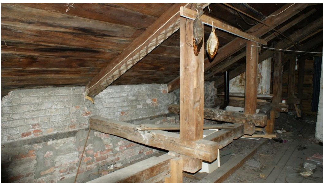
75. «Жилой дом», г. Выборг, ул. Крепостная, д.8. Кровля. Общий вид. Фото 25.05.2021г.
