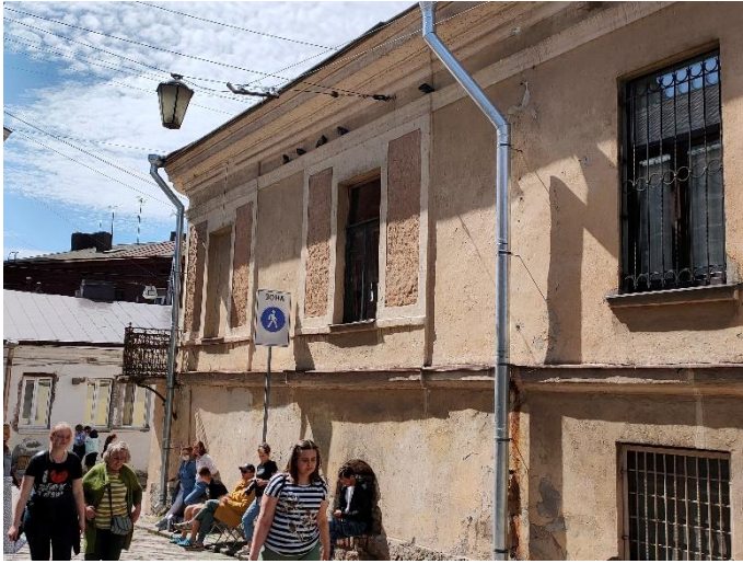
45. «Жилой дом», г. Выборг, ул. Крепостная, д.8. Юго-восточный фасад. Фрагмент. Фото 25.05.2021г.
