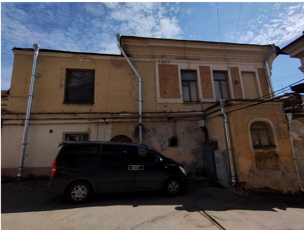
2. «Жилой дом», г. Выборг, ул. Крепостная, д.8. Северо-западный фасад. Общий вид. Фото 25.05.2021г.
