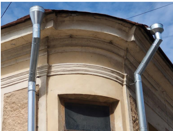
47. «Жилой дом», г. Выборг, ул. Крепостная, д.8. Юго-восточный фасад. Фрагмент. Фото 25.05.2021г.
