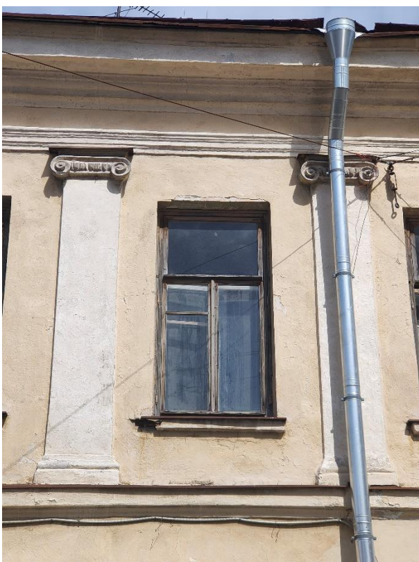
10. «Жилой дом», г. Выборг, ул. Крепостная, д.8. Юго-западный фасад. Фрагмент. Фото 25.05.2021г.
