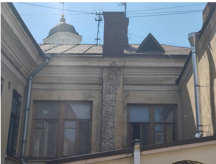
30. «Жилой дом», г. Выборг, ул. Крепостная, д.8. Северо-западный фасад. Фрагмент. Фото 25.05.2021г.
