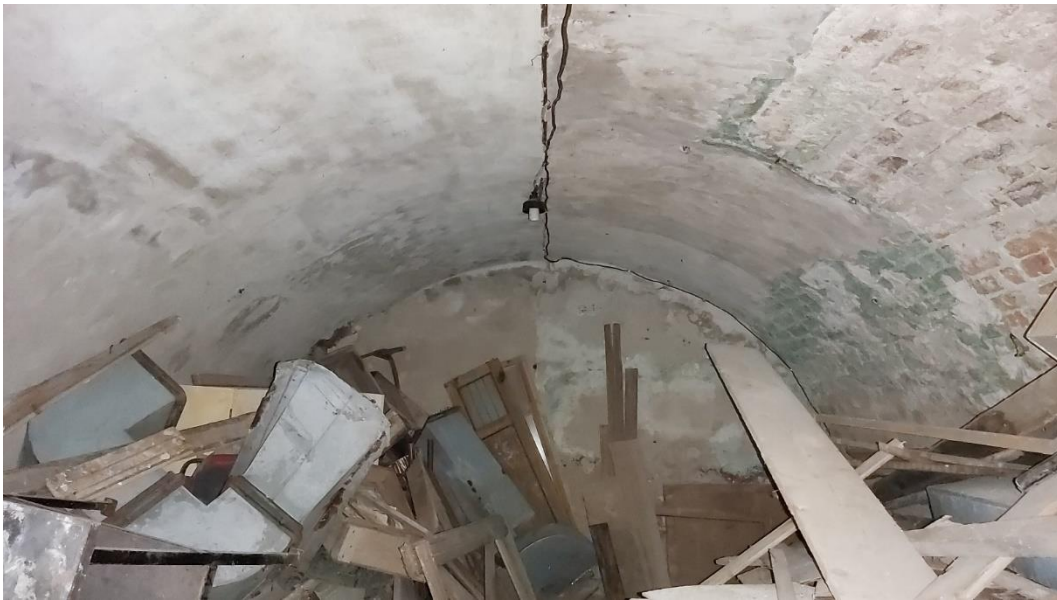
71. «Жилой дом», г. Выборг, ул. Крепостная, д.8. Подвал. Общий вид. Фото 25.05.2021г.
