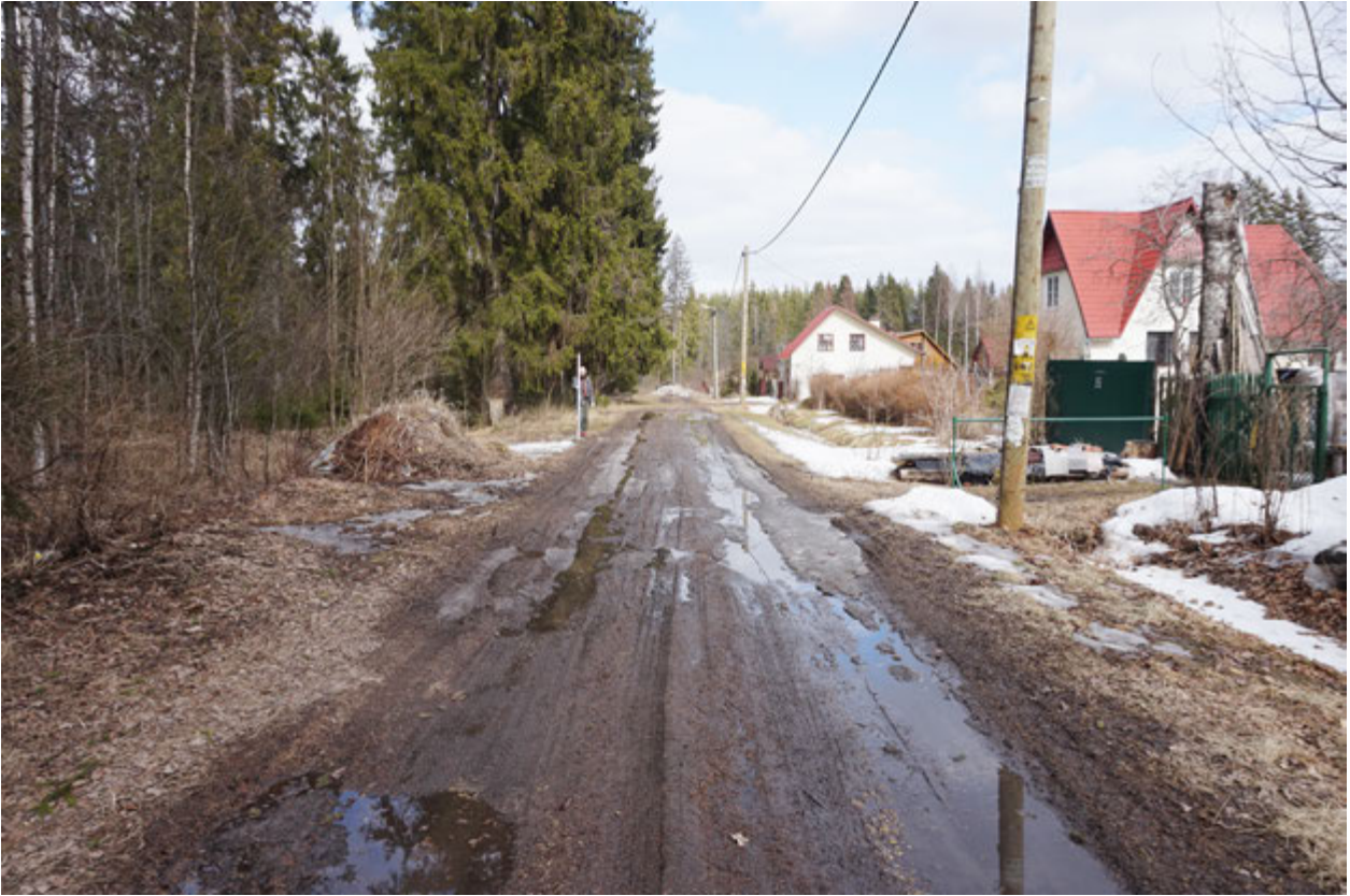
Рис. 36. Ленинградская область, Гатчинский район, п. Прибыtkовo. Прохождение газопровода по ул. Лесной. Вид с Ю
