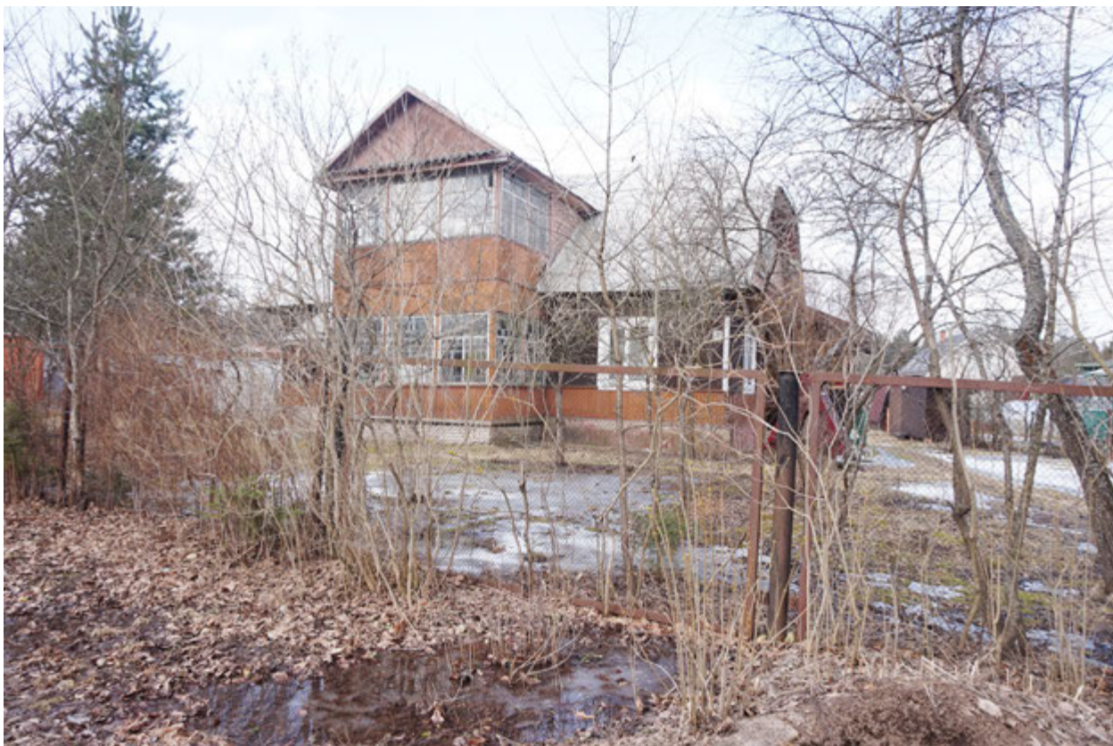
Рис. 21. Ленинградская область, Гатчинский район, п. Прибыtkовo. Дом по адресу ул. Репина – 15. Вид с В
