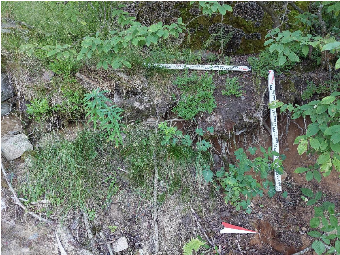
Рис. 57. Ленинградская область, Приозерский район, Кузнечнинское городское поселение, пос. Кузнечное – 2021 г. Зачистка №1. До начала работ. Вид с В-СВ.
