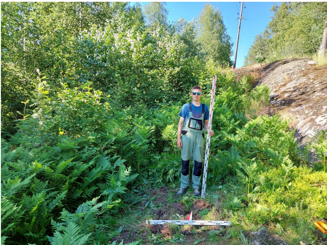
Рис. 50. Ленинградская область, Приозерский район, Кузнечинское городское поселение, пос. Кузнечное – 2021 г. Шурф №2. Засыпка. Вид с Ю.
