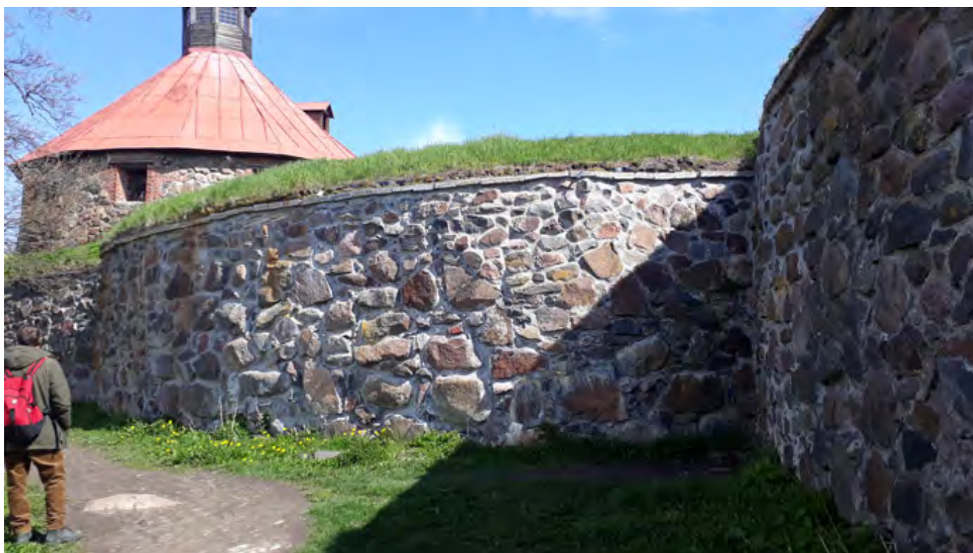
Фото 7.3. Объект культурного наследия федерального значения Крепость "Корела", XIV-XVIII вв., входящий в состав объект культурного наследия федерального значения "Комплекс крепостных сооружений" XIV-XVIII вв.
