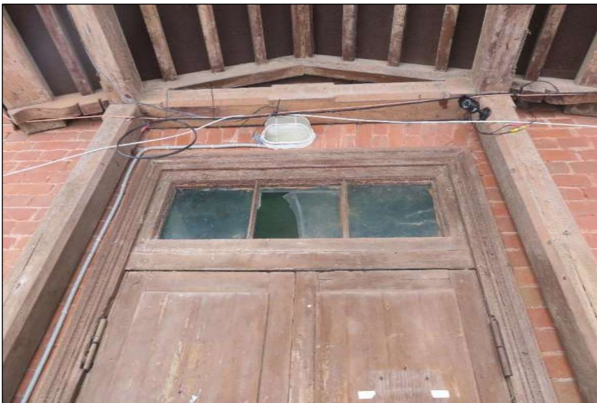
11. Караулка у березовых ворот. Навес над крыльцом и сохранившаяся входная дверь с остекленной фрамугой. Видны конструкции стропил, обрешетка, цветное решение.
