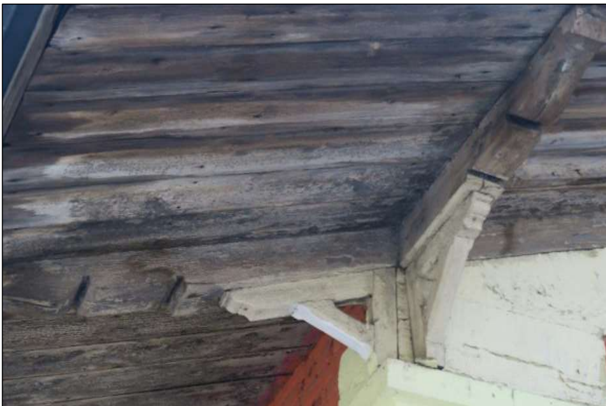
16. Караулка на ул.Хохлова, д.1. Угловая часть кровельного свеса. Декоративное оформление – резные кобылки, кронштейны.
