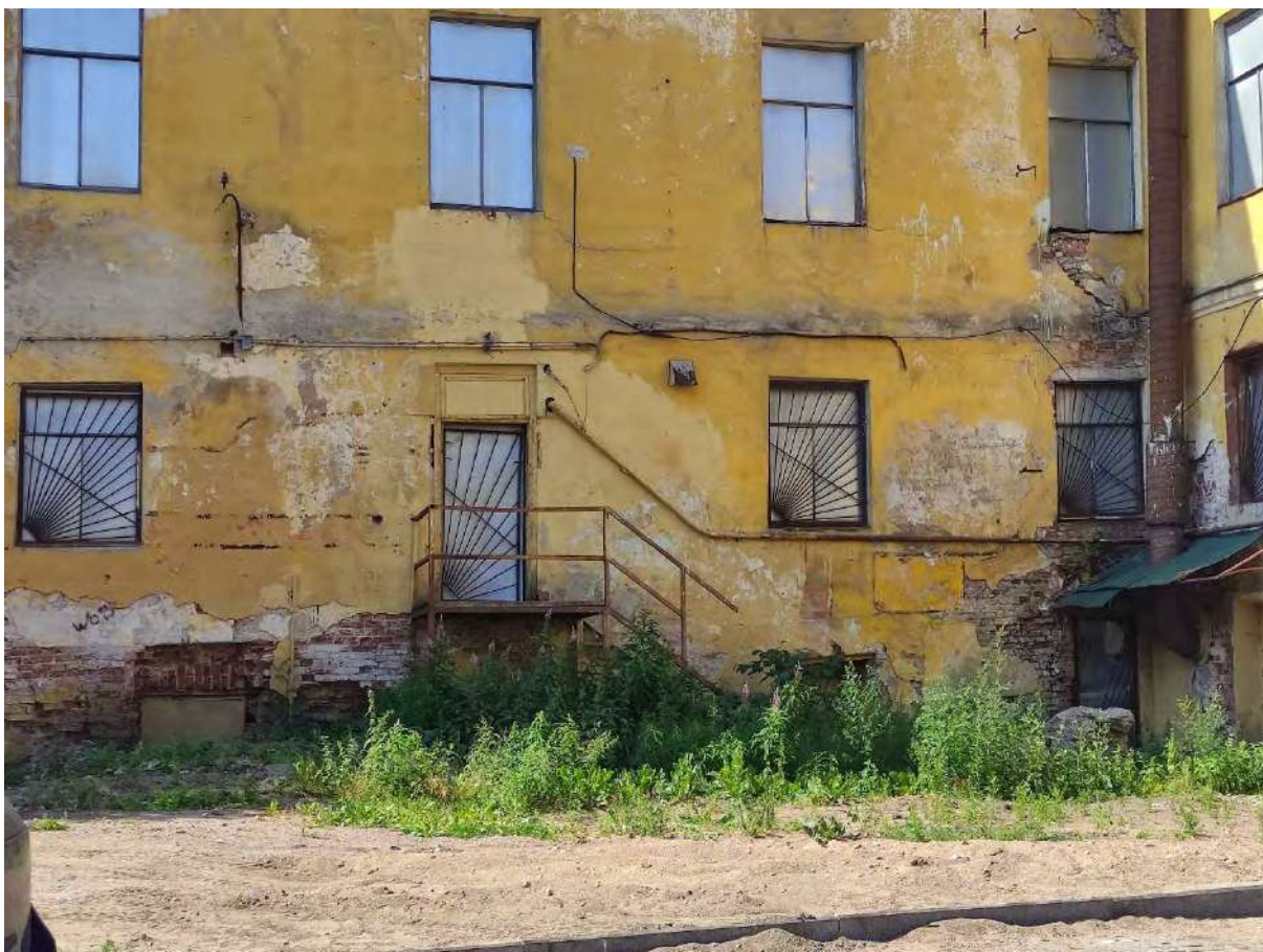
Фото 21. Объект культурного наследия регионального значения «Дом губернского правления», расп. по адресу: Ленинградская обл., г. Выборг, ул. Крепостная, 22. Дворовый северо-восточный фасад основного объема, фрагмент.
