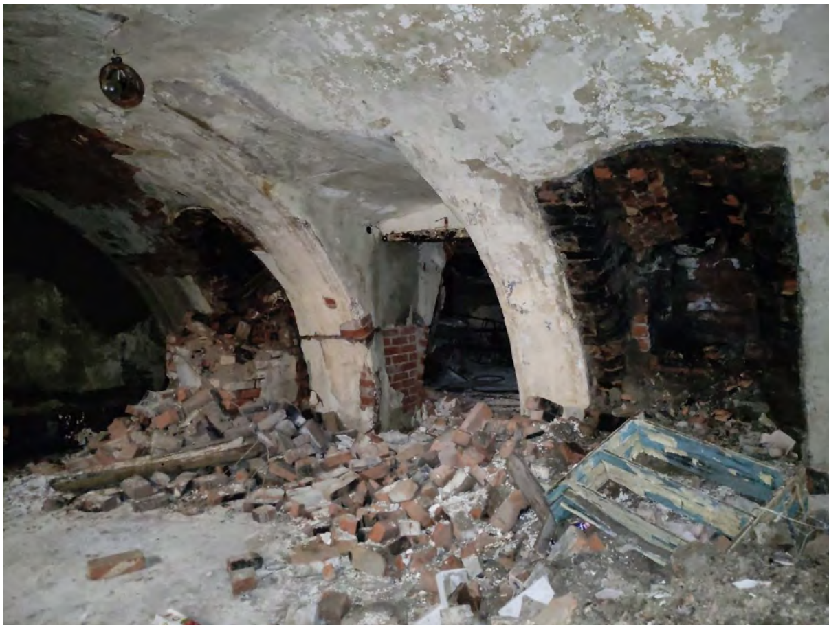
Фото 44. Объект культурного наследия регионального значения «Дом губернского правления», расп. по адресу: Ленинградская обл., г. Выборг, ул. Крепостная, 22. Интерьер пом. № б/н(3) подвальный этаж. Сводчатые перекрытия цокольного этажа; по центру – дверной проем в пом. № б/н(2).
