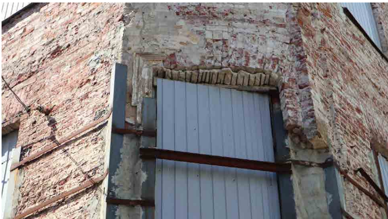
Фото 19. Угол здания, выходящий на пересечение ул. Крепостная и ул. Красноармейская. Сохранившийся фрагмент наличника дверного балконного проёма в уровне второго этажа.
