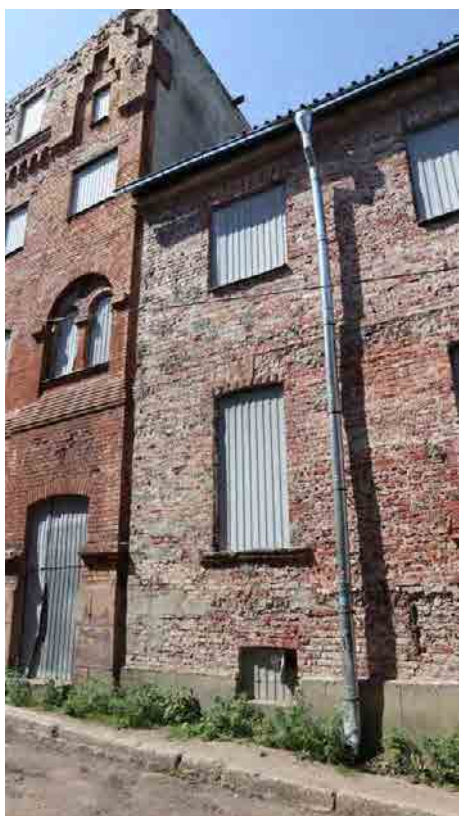
Фото 23. Фрагмент фасада по ул. Красноармейская. Примыкание к зданию по ул. Красноармейская, д. 10.
