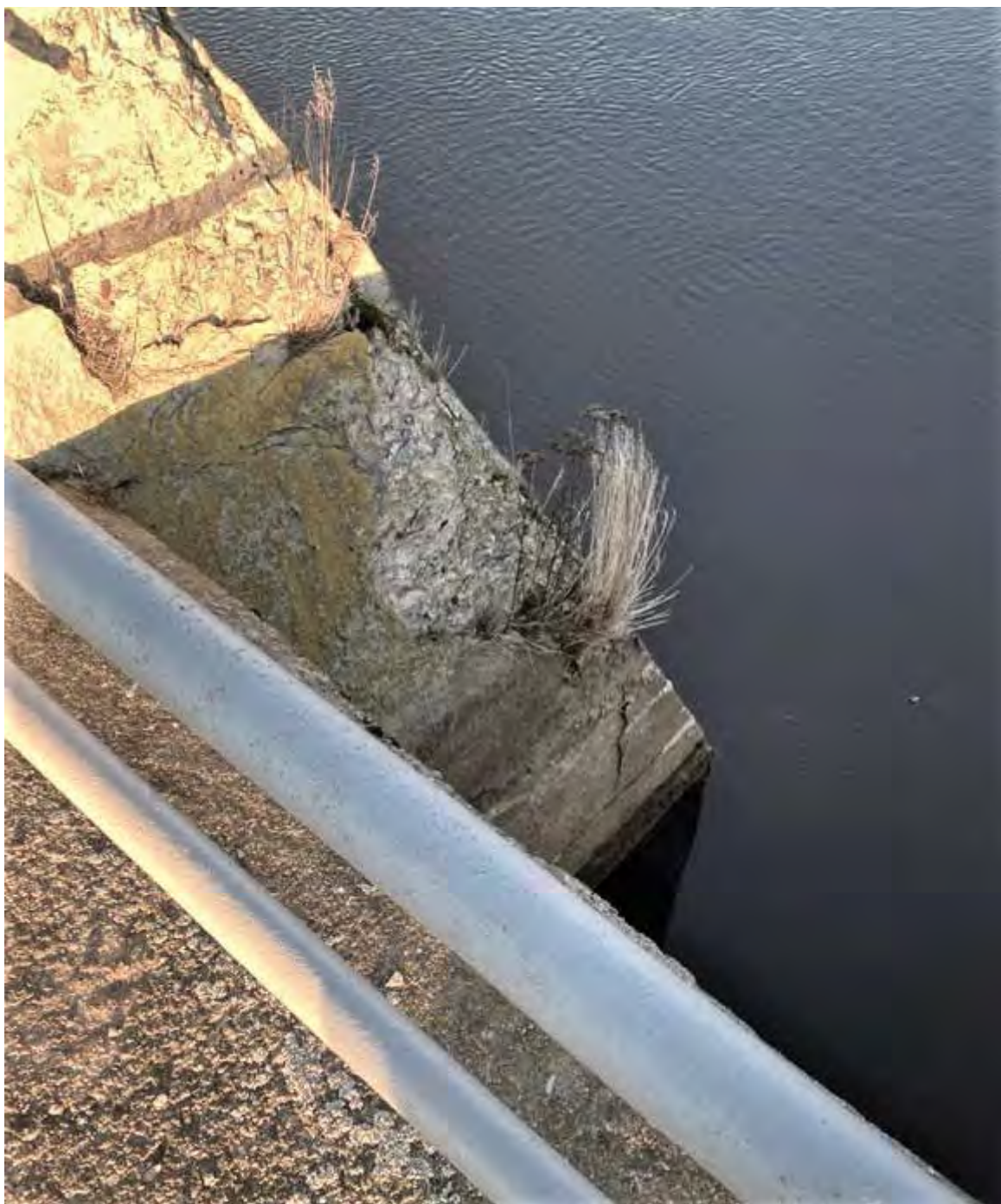
Фото 7. Ледозащитная стенка Волховской ГЭС. Разрушения бетонного защитного слоя.
