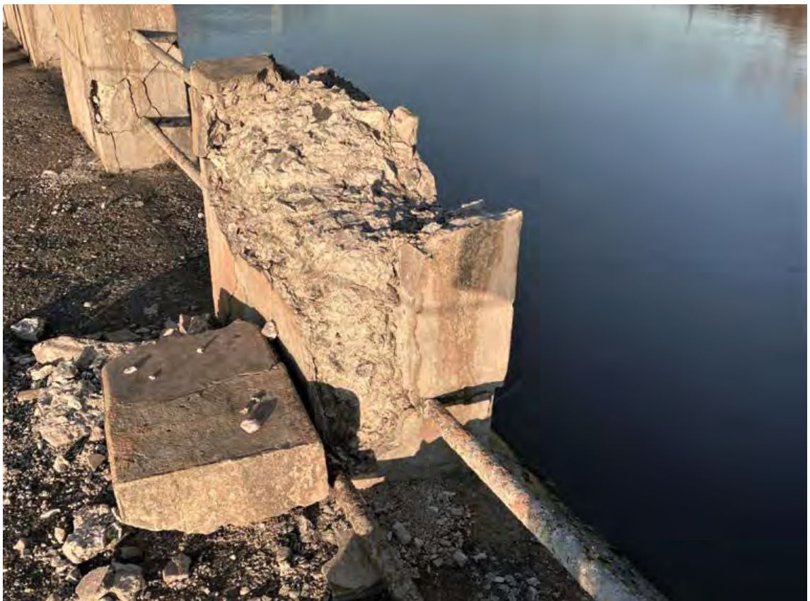
Фото 6. Разрушения тумбы парапета Ледозащитной стенки Волховской ГЭС.
