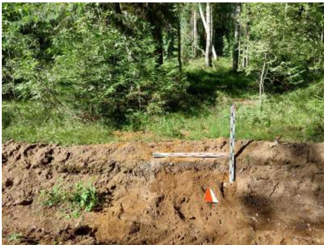
Рис. 130. Ленинградская обл., Всеволожский район, Рахьинское городское поселение -2019 г. Зачистка №1. Засыпка. Вид с Ю.
