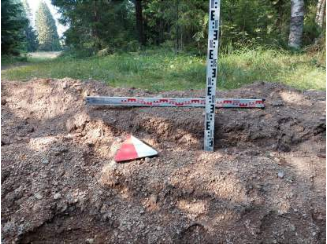
Рис. 132. Ленинградская обл., Всеволожский район, Рахьинское городское поселение -2019 г. Зачистка №2. До начала работ. Вид с Ю-ЮЗ.
