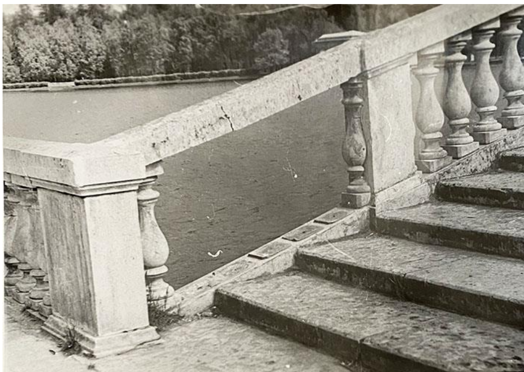
Илл.79. Горбатый мост. Состояние балюстрады ограждения с северо-восточной стороны моста. Фотография.1950-е гг. ГМЗ «Гатчина»
