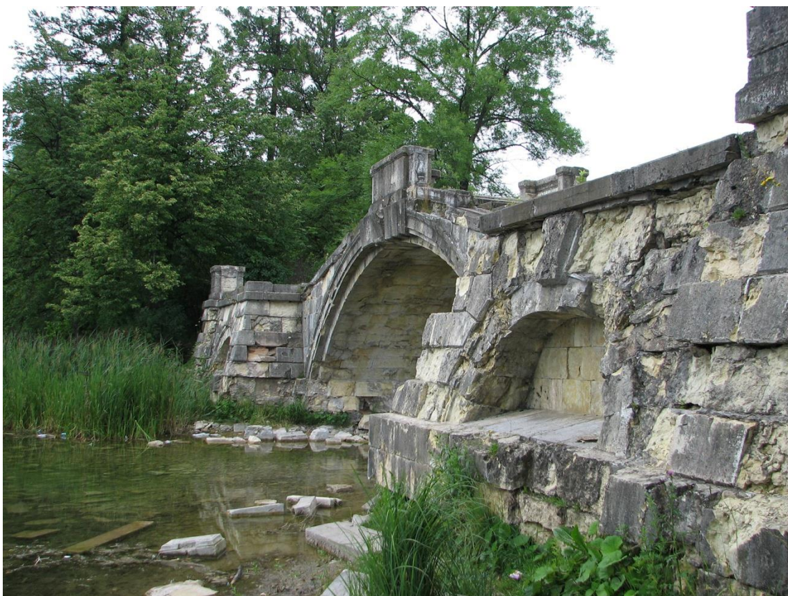
Илл.130. Горбатый мост. Состояние фасада со стороны Серебряного пруда. Фотография. Частный архив. 2008 г.
