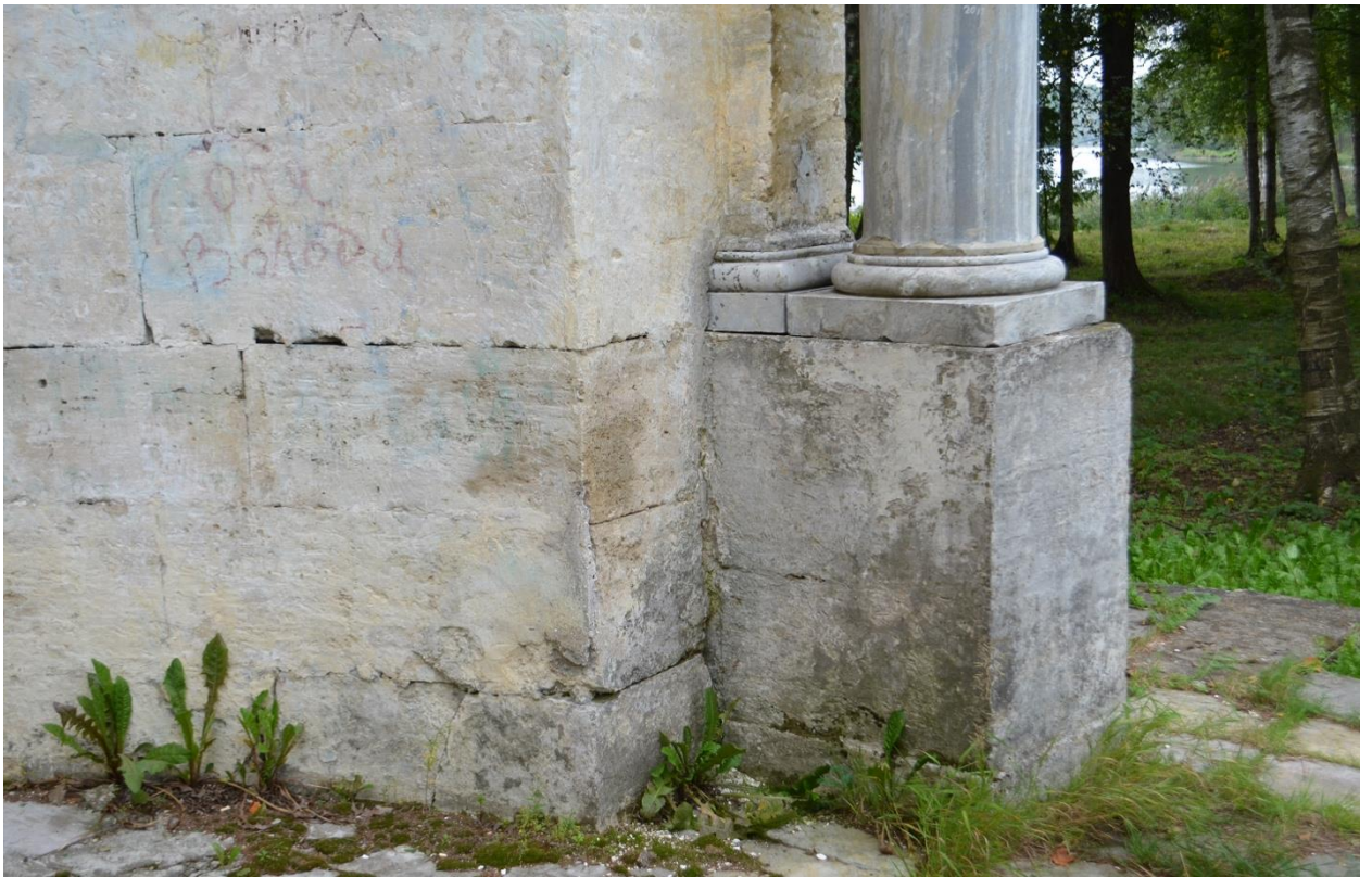
Фото 26. ОКН федерального значения «Павильон «Орла», 1790-е гг. в составе ОКН федерального значения «Ансамбль Гатчинского дворца и парка». Стена павильона, база и постамент колонн, вид с северо-запада. Фрагмент. Съёмка 23.08.2021г.
