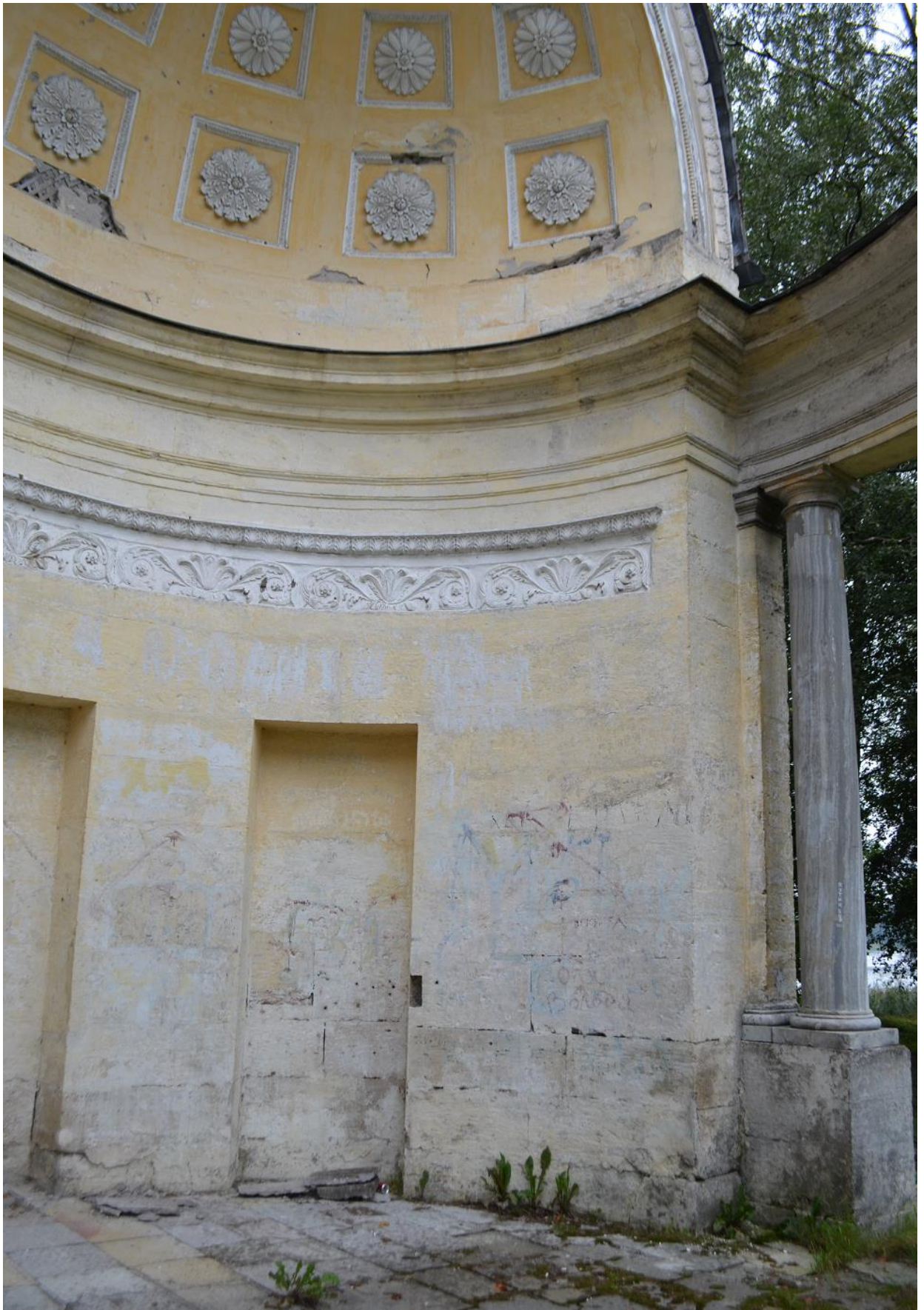
Фото 25. ОКН федерального значения «Павильон «Орла», 1790-е гг. в составе ОКН федерального значения «Ансамбль Гатчинского дворца и парка». Стена павильона и полукупольный свод, вид с северо-запада. Фрагмент. Съёмка 23.08.2021г.
