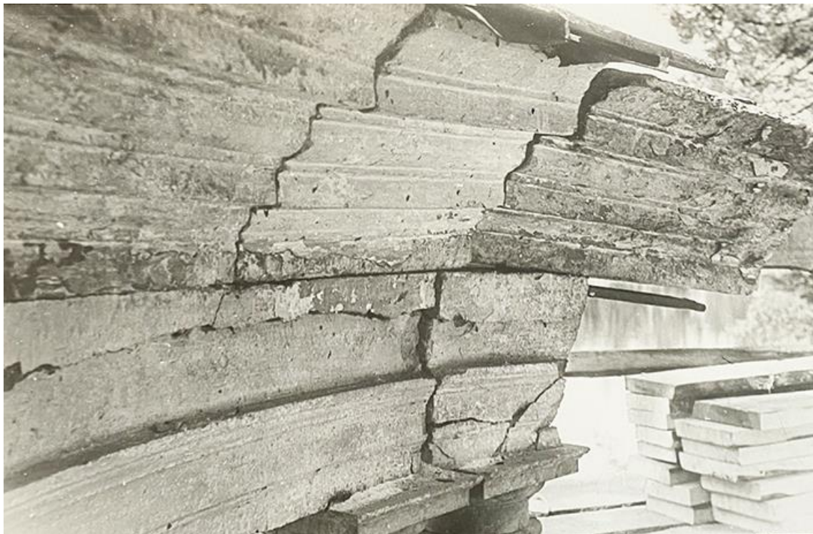
Илл. 96 Павильон Орла. Состояние антаблемента до реставрации. Фотография. 1972 г. СНРПИМ. ГМЗ «Гатчина»
