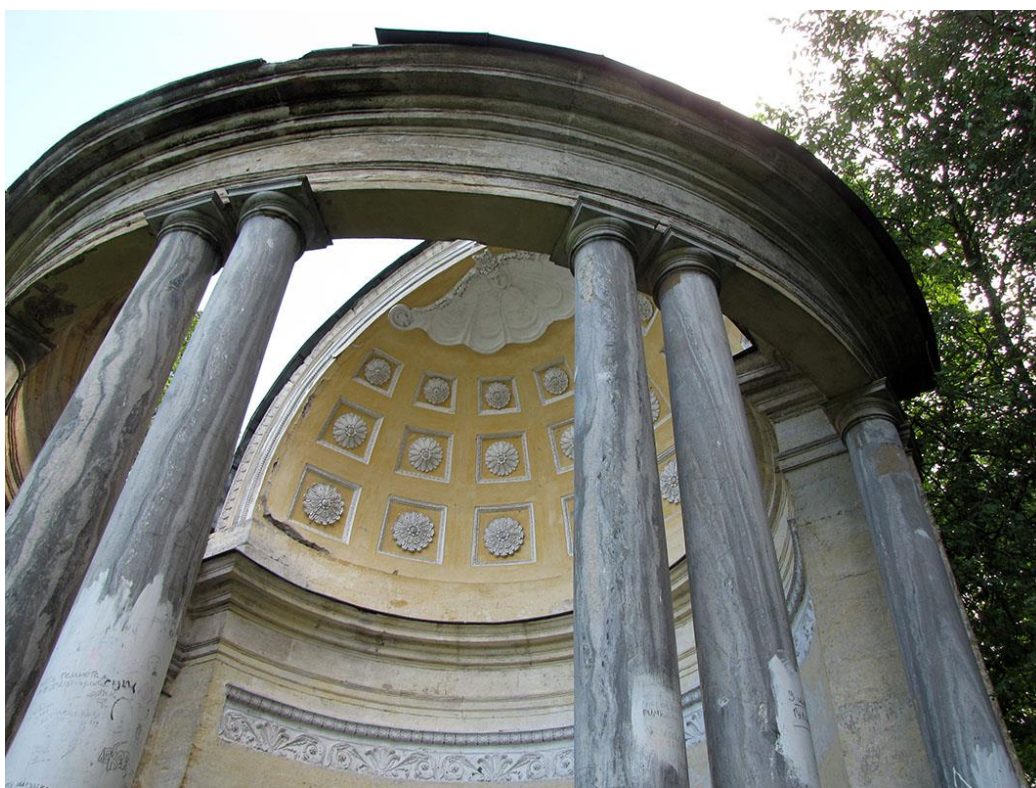
Илл.114 Павильон Орла. Состояние колонн и антаблемента по юго-восточной четверти с наружной стороны. Фотография Т.Н. Ладыгиной. 2011 г.
