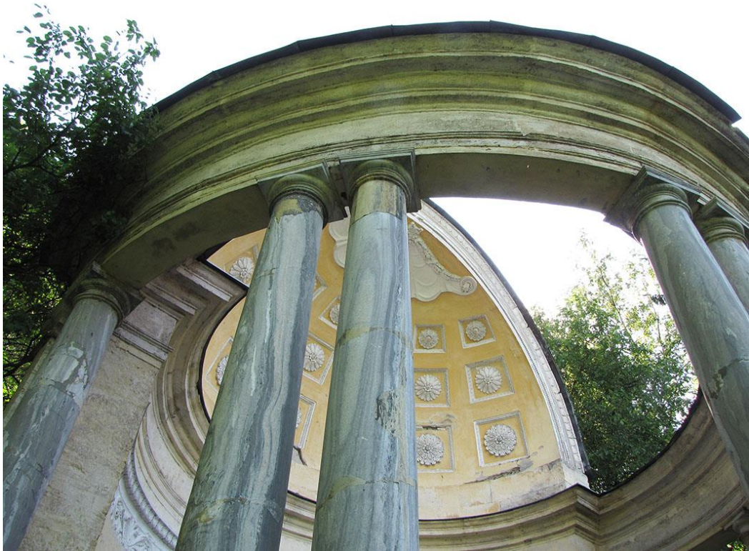
Илл.115 Павильон Орла. Состояние колонн и антаблемента по северо-западной четверти с наружной стороны. Фотография Т.Н. Ладыгиной. 2011 г.
