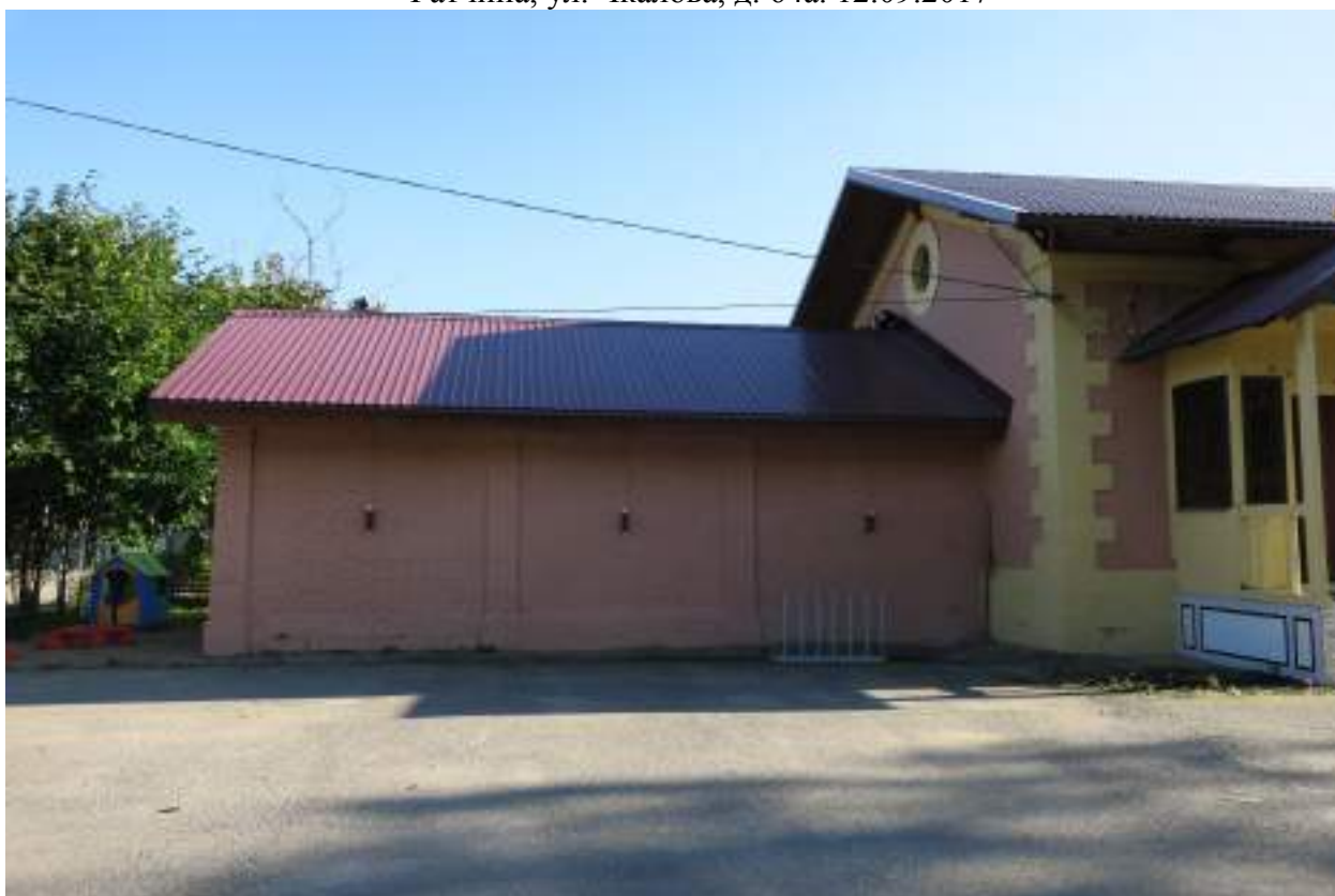
6. Северо-западные фасады здания «Караулки №3», расположенного по адресу: г. Гатчина, ул. Чкалова, д. 64а. Фрагмент. 12.09.2017
