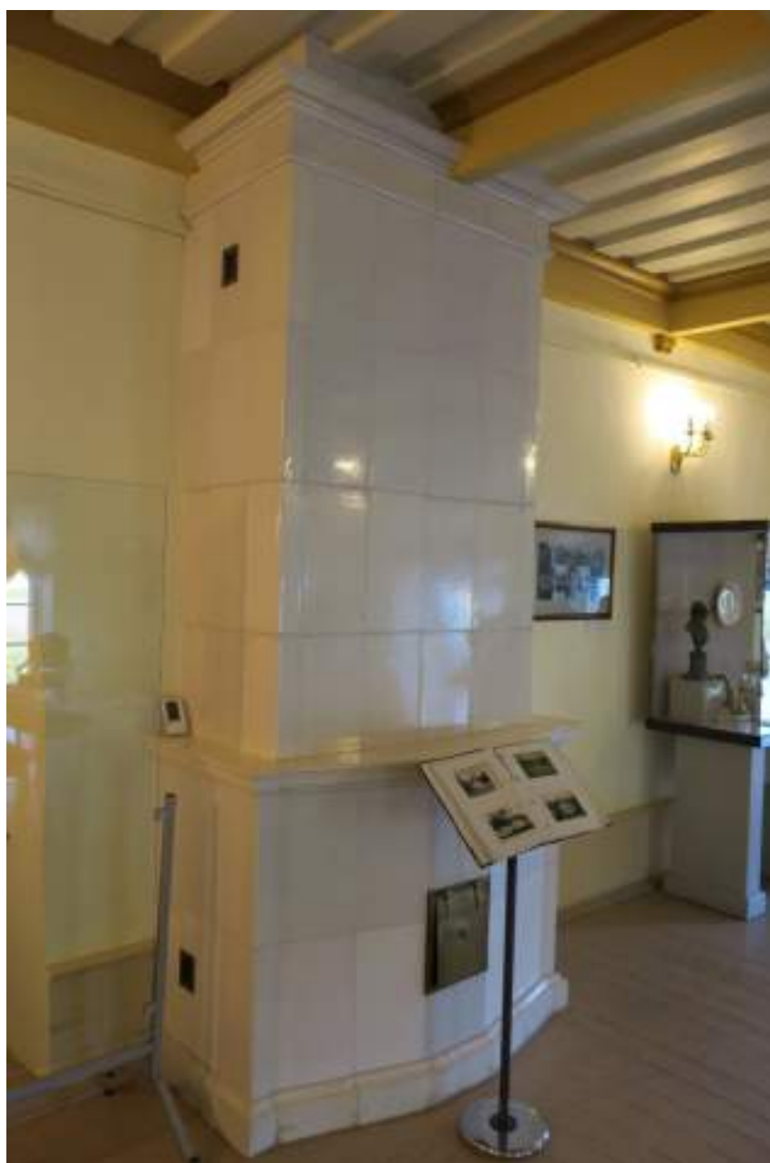
117. «Голландская» печь в помещении №16 (1-Н) в уровне 2-го этажа. 12.09.2017
