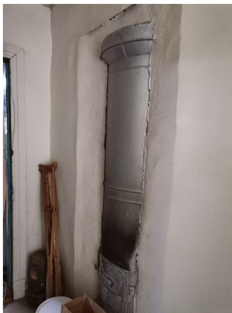
32. «В этом доме в 1941-43 гг. находился штаб автомобилистов, осуществляющих автоперевозки через Ладожское озеро по «Дороге жизни». На доме установлена памятная доска», Ленинградская обл., Всеволожский район, д. Коккорено, д. 27. Интерьер. Фрагмент. Фото 11.08.2021 г.
