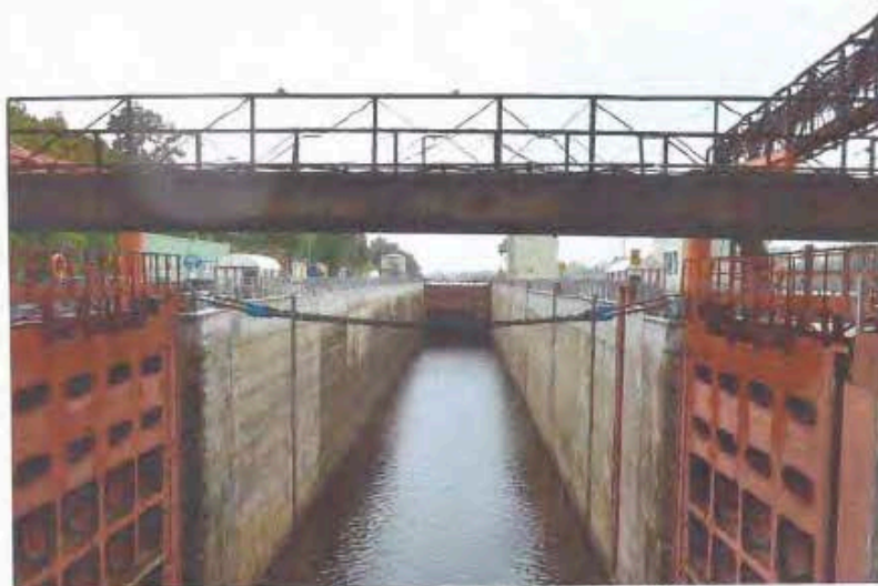
Фото 6. Ленинградская область, г. Волхов, Волховская ГЭС. Вид с севера на камеру шлюза.
