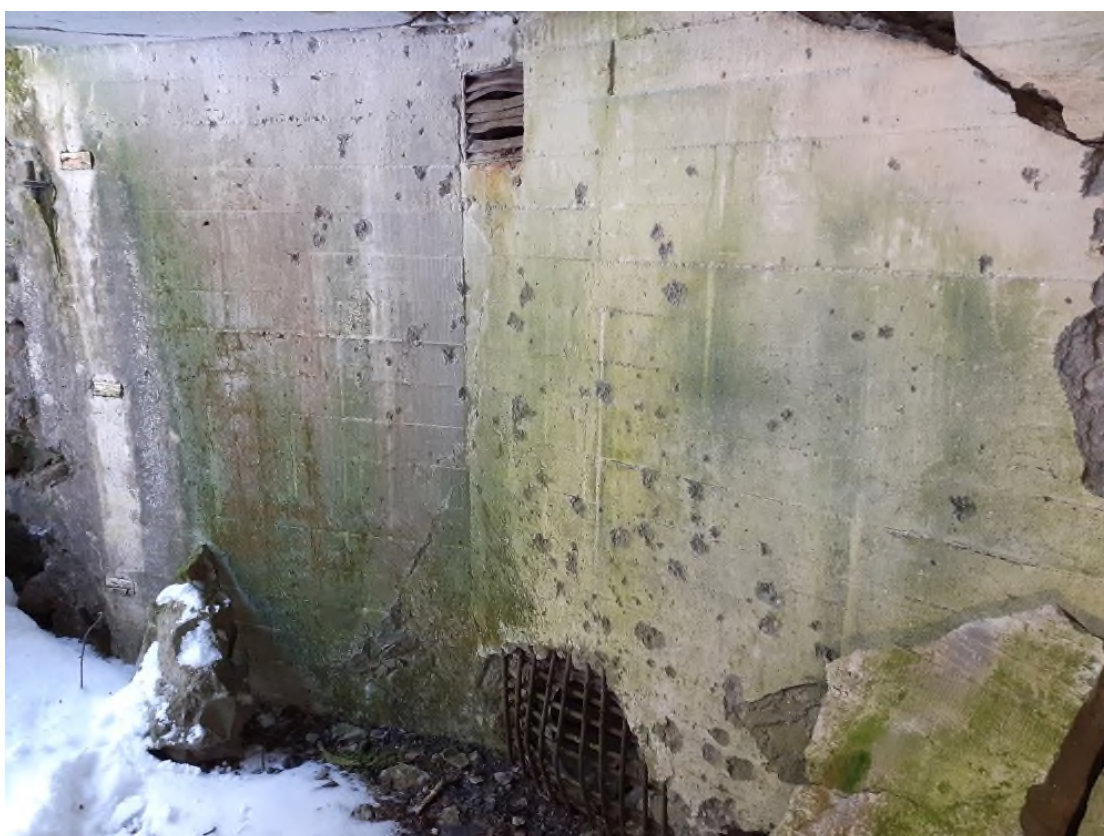
6. Повреждённая подрывом система вентиляции ДОТ.
