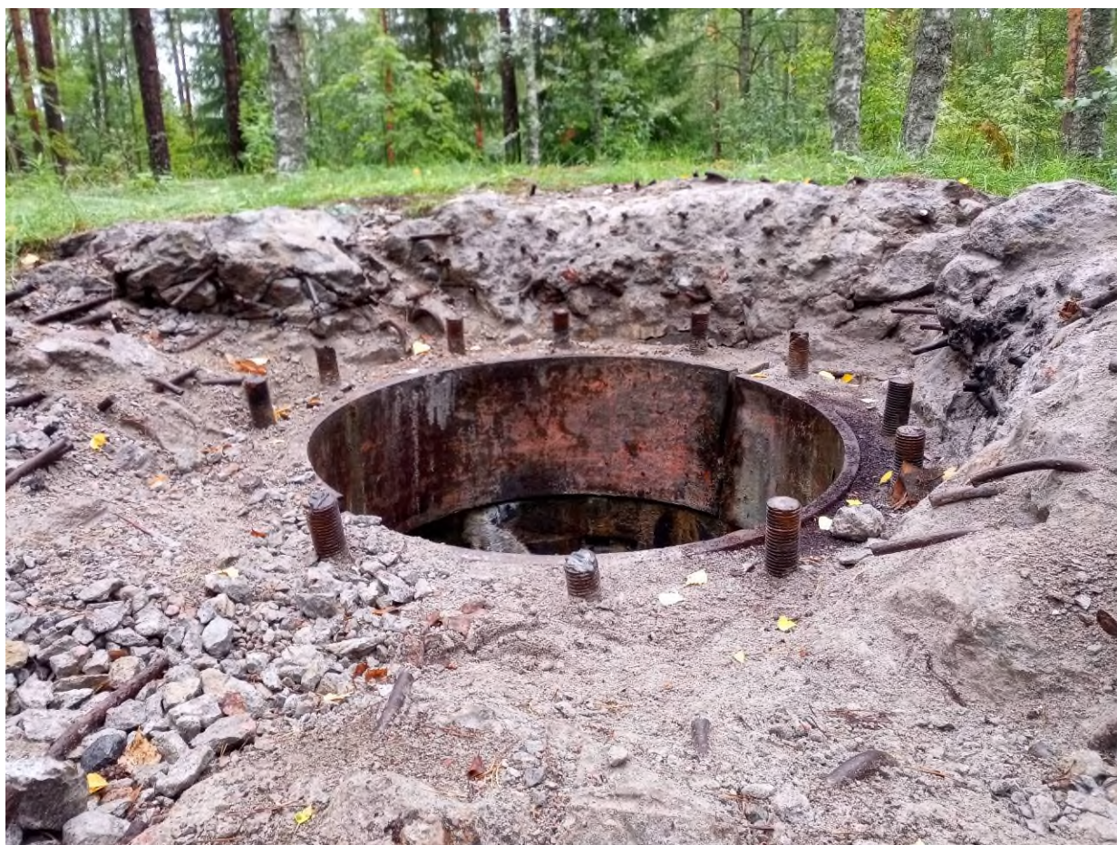
Рисунок 26. То же сооружение в конце августа 2020 года. Бронекупол демонтирован вандалами для сдачи в металлолом, арматура срезана.
