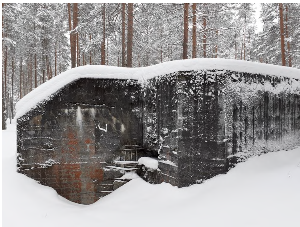
2. Повреждённая подрывом амбразура
