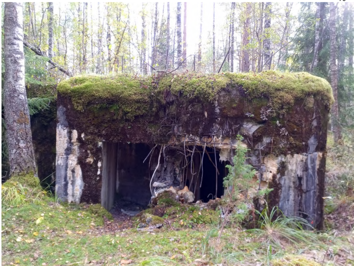
Типовое убежище №51, укрепленный район Мьялкёля. Правый вход и подорванная амбразура. Арматура была срезана вандалами в 2020 году в период самоизоляции.
