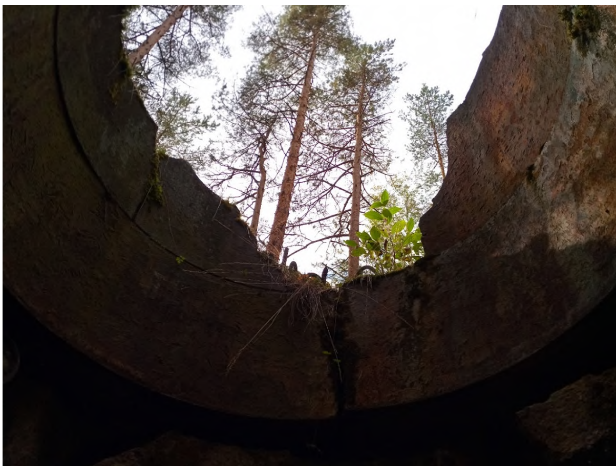
Фрагменты бронекупола полукапонира на один пулемёт №25 укрепрайона Мьялкёля были демонтированы и вывезены вандалами в период самоизоляции в 2020 году.
