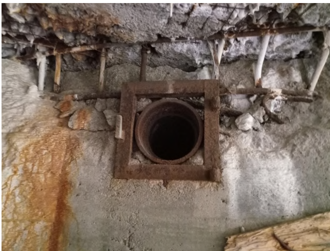
Сохранившаяся труба для выброса ручных гранат внутри капонира №28 на два пулемёта, укреплённый район Мялкёля.
