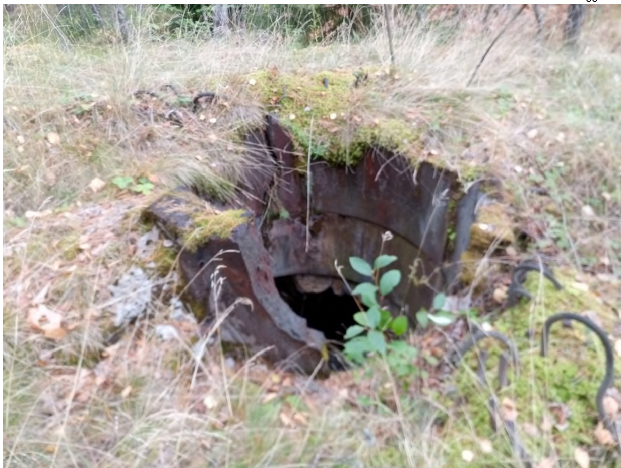
Фрагменты бронекупола полукапонира на один пулемёт №25 укрепрайона Мялкёля были демонтированы и вывезены вандалами в период самоизоляции в 2020 году.
