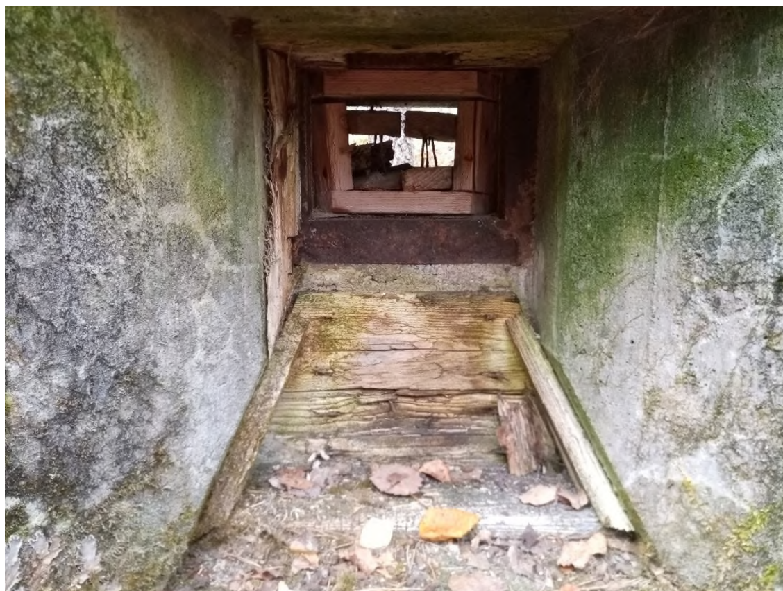
Сохранившаяся опалубка отливки амбразуры под ручной пулемет, недостроенное типовое убежище №51, укрепленный район Мьякеля. Вид изнутри.
