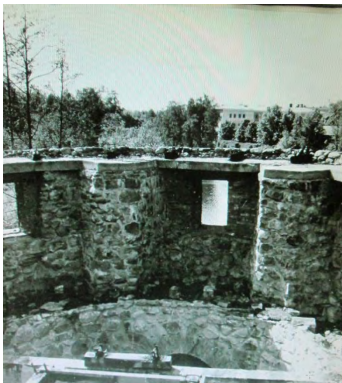
98. Круглая башня. Жел-бет. пояс реставрационных работ 1963г. Вид с востока. Министерство Культуры РСФСР. Трест «Росреставрация». Ленинградская Областная СНРПМ. Материалы исследований. Фотофиксация. Крепость Корела. Круглая башня в г. Приозерск. Т.Ш. Ленинград. 1977г.
