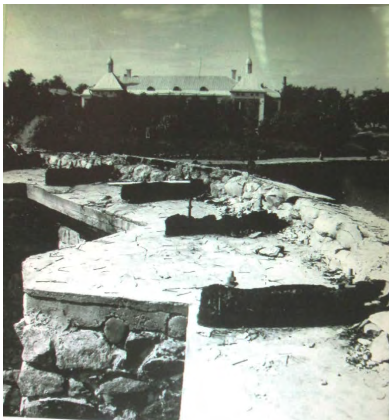
100. Круглая башня. Остатки конструкций шатра. Министерство Культуры РСФСР. Трест «Росреставрация». Ленинградская Областная СНРПМ. Материалы исследований. Фотофиксация. Крепость Корела. Круглая башня в г. Приозерск. Т.Ш. Ленинград. 1977г.
