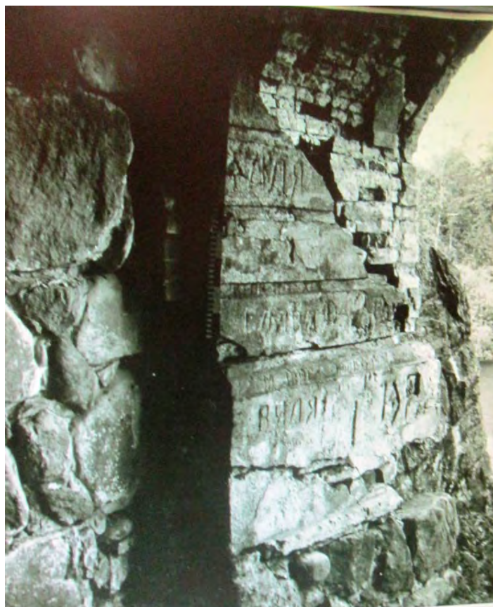
104. Круглая башня. Портал. Состояние южной стены. Министерство Культуры РСФСР. Трест «Росреставрация». Ленинградская Областная СНРПМ. Материалы исследований. Фотофиксация. Крепость Корела. Круглая башня в г. Приозерск. Т.Ш. Ленинград. 1977г.
