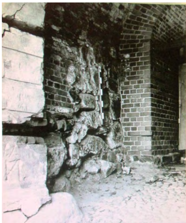
103. Круглая башня. Портал. Состояние северной стены. Министерство Культуры РСФСР. Трест «Росреставрация». Ленинградская Областная СНРПМ. Материалы исследований. Фотофиксация. Крепость Корела. Круглая башня в г. Приозерск. Т.Ш. Ленинград, 1977г.
