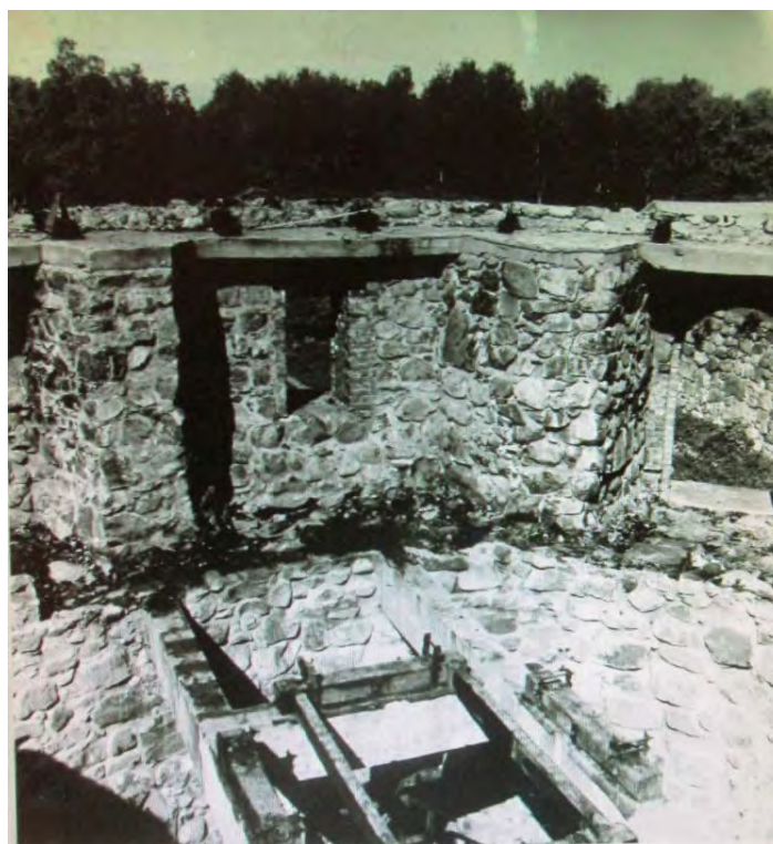
99. Круглая башня. Жел-бет. пояс реставрационных работ 1963г. Вид с юга. Министерство Культуры РСФСР. Трест «Росреставрация». Ленинградская Областная СНРПМ. Материалы исследований. Фотофиксация. Крепость Корела. Круглая башня в г. Приозерск. Т.Ш. Ленинград. 1977г.
