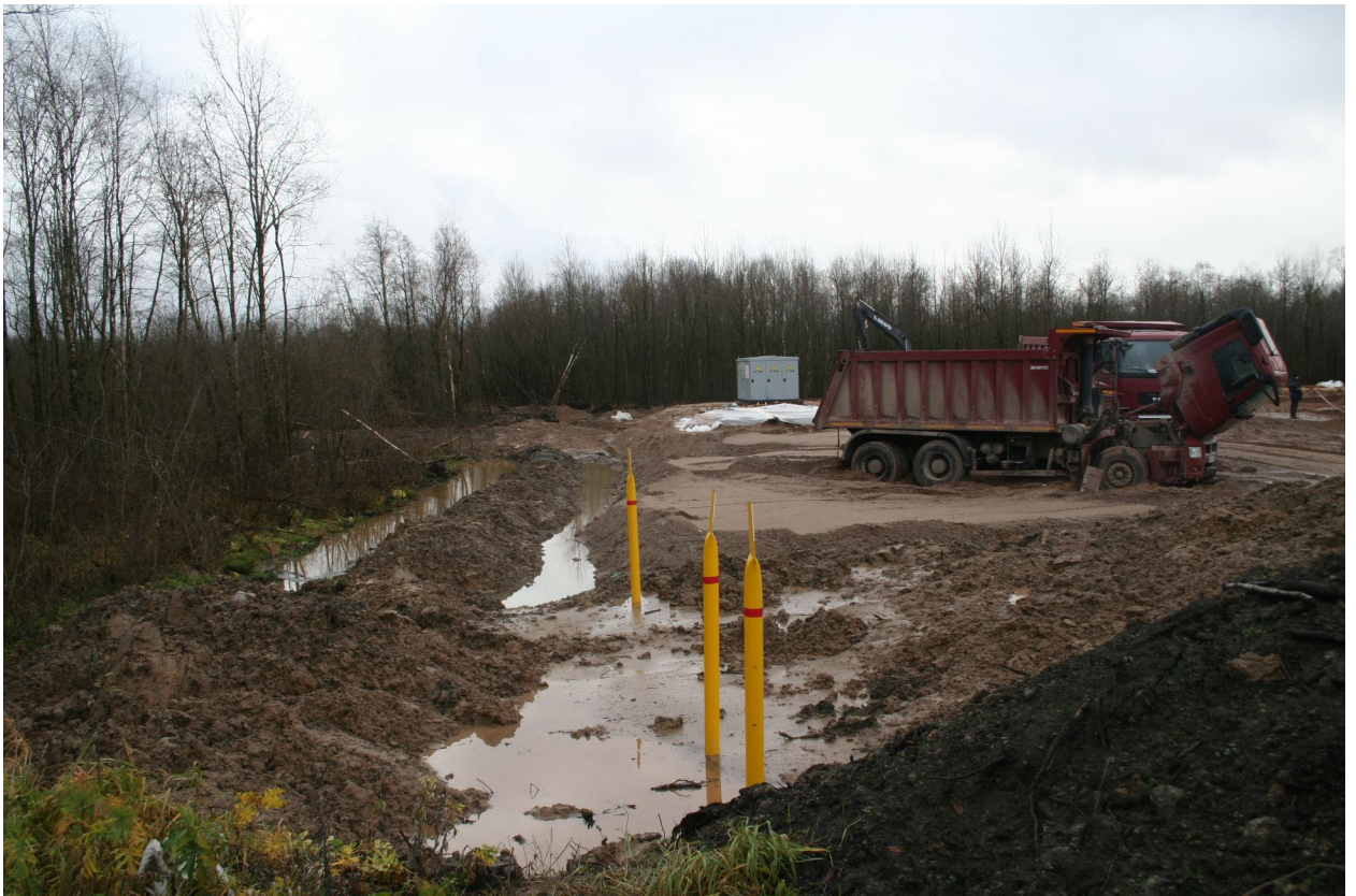
Илл. 15. Ленинградская обл., г. Волхов, участок обследования. Водоотводные канавы и газопровод на западной границе участка обследования. Вид с севера. Деталь. 29.09.2021 г.
