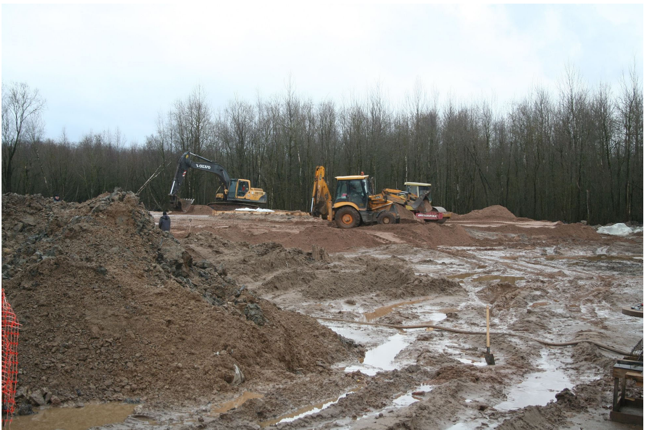
Илл. 13. Ленинградская обл., г. Волхов, участок обследования. Точка фотофиксации 2. Вид с северо-запада. Снятый почвенно-растительный слой и подсыпка территории участка. 29.09.2021 г.
