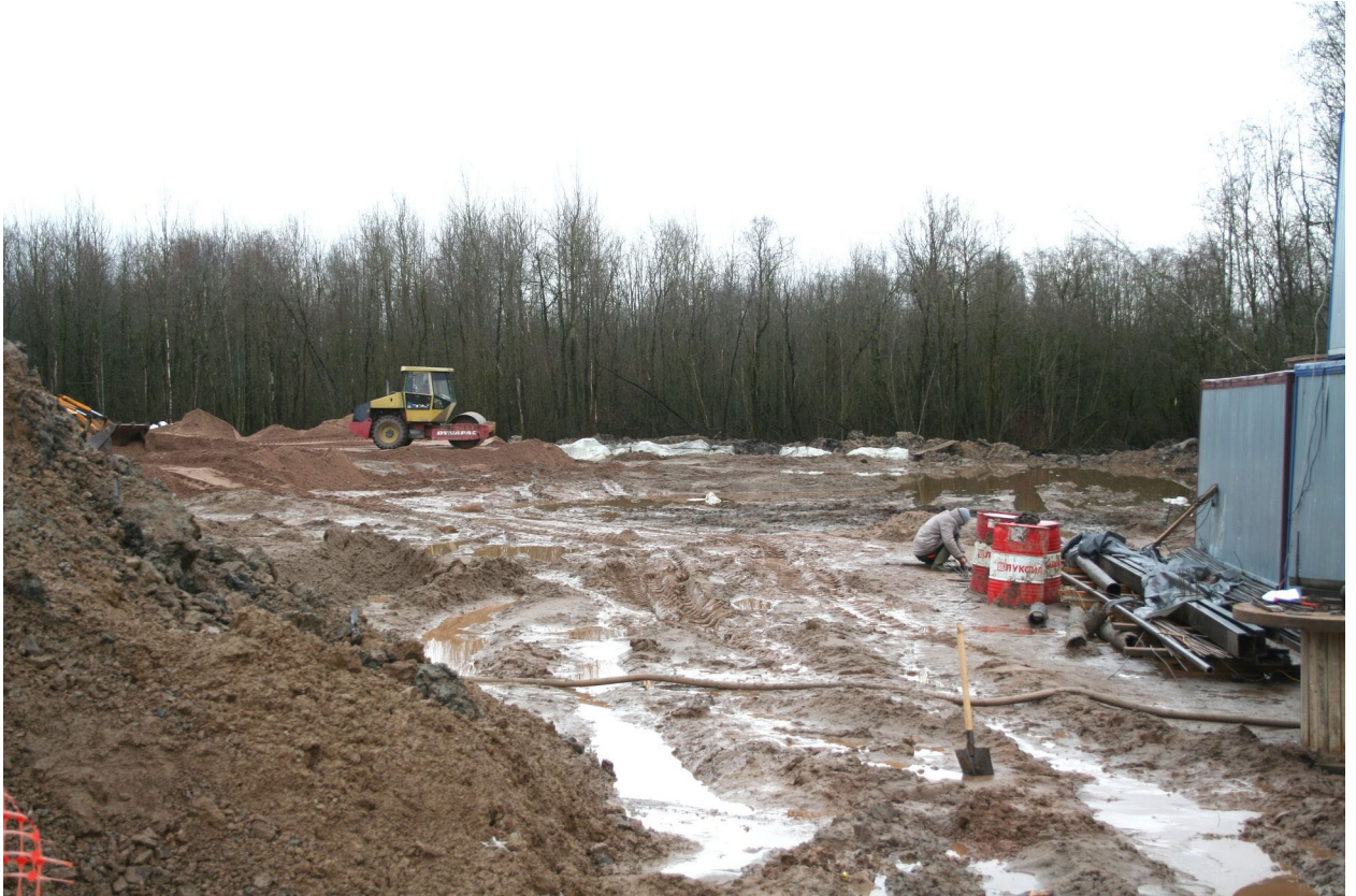
Илл. 14. Ленинградская обл., г. Волхов, участок обследования. Точка фотофиксации 2. Вид с севера. Снятый почвенно-растительный слой и подсыпка территории участка. 29.09.2021 г.
