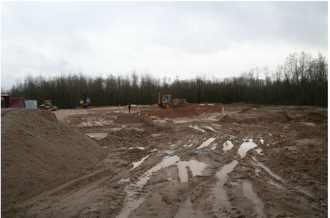
Илл. 11. Ленинградская обл., г. Волхов, участок обследования. Точка фотофиксации 1. Участок обследования. Вид с северо-востока. Подсыпка территории участка. 29.09.2021 г.
