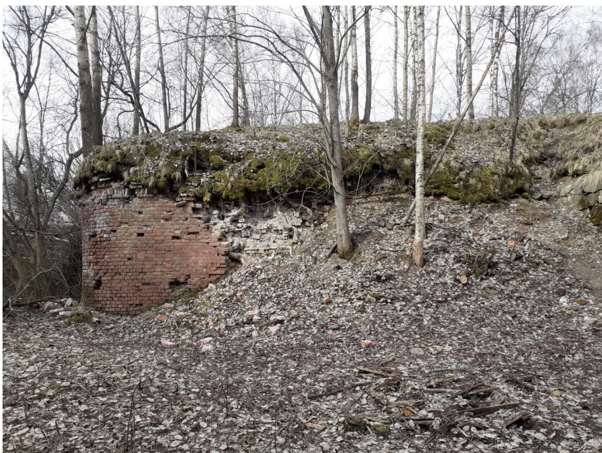
6. Полуразрушенная восточная стена капонира. Амбразуры для единорогов завалены грунтом и осыпавшейся кирпичной кладкой.
