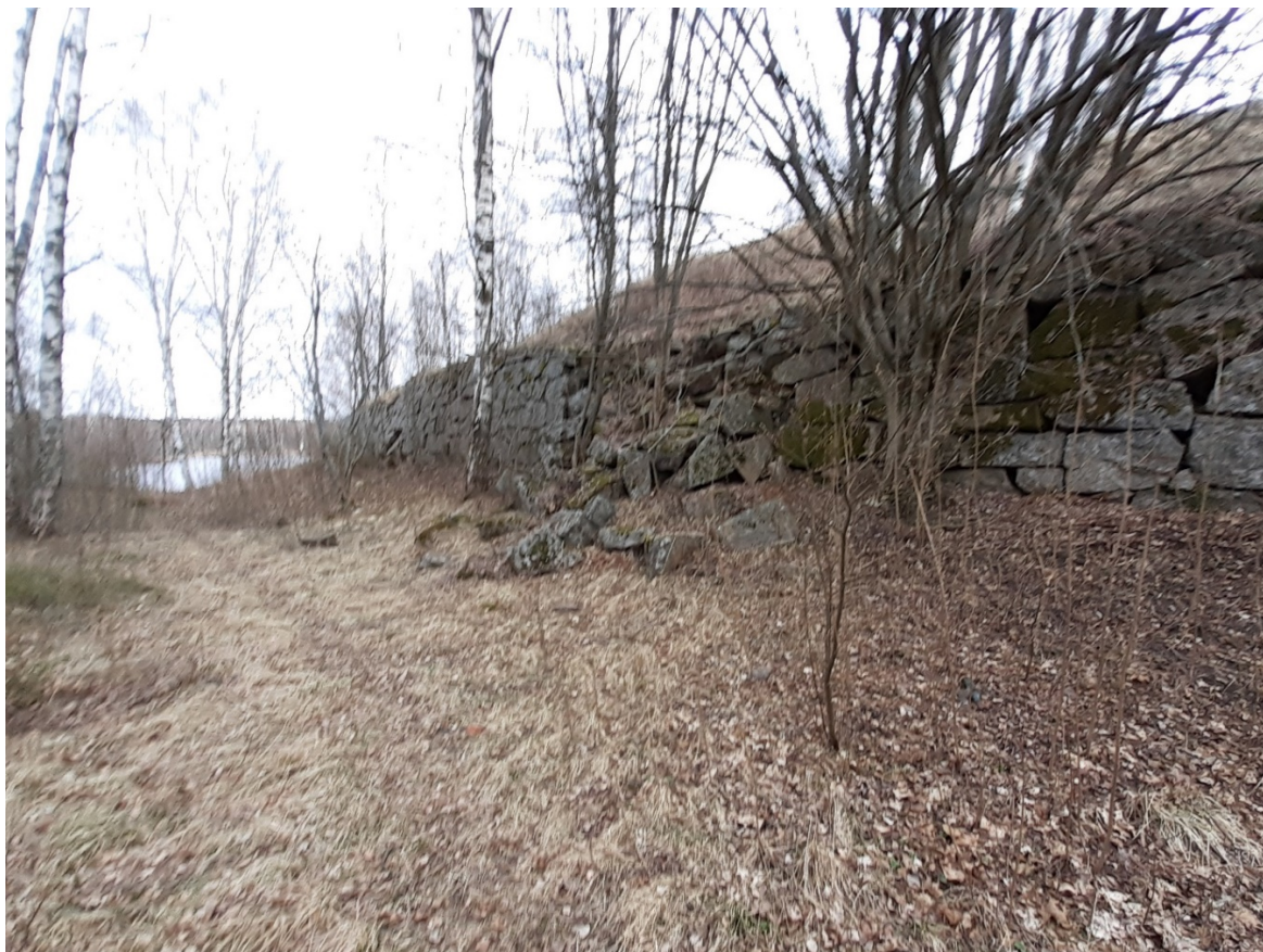
26. Разрушение кладки рва
