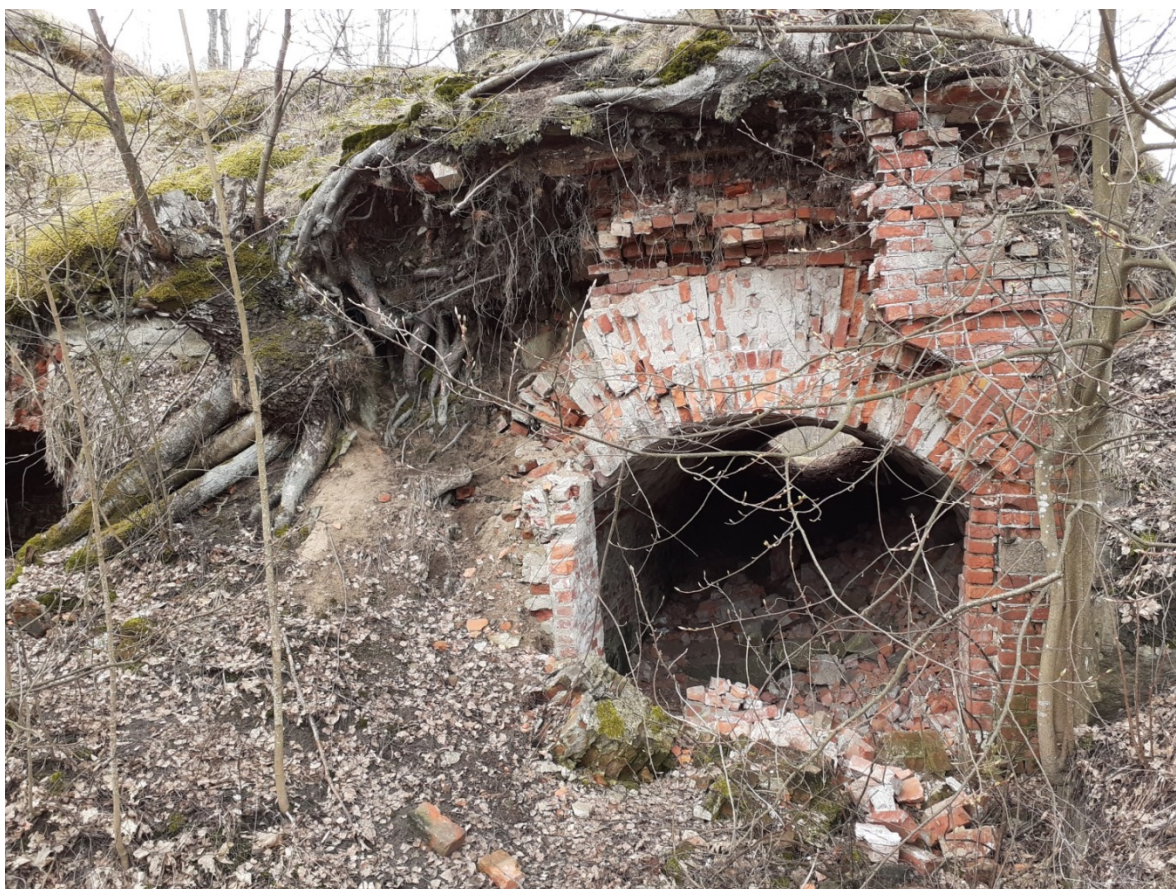
10. Разрушение кладки сводов и стен сортии 1878 года
