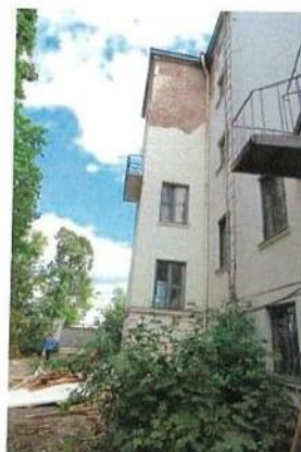
Ю-З фасад дворового ризалита
