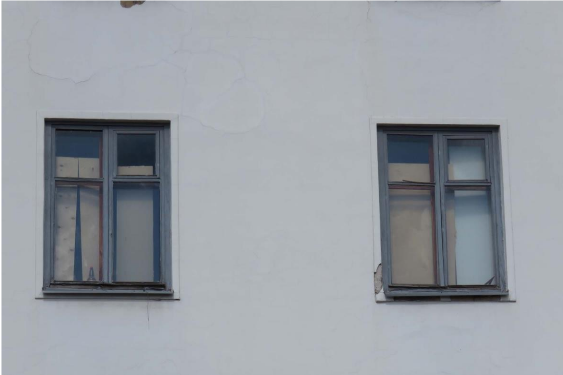
Фото 6. Оконные проемы 3-го и 4-го этажей лицевого Ю-В фасада. Дата съемки: 23.09.2021 г.
