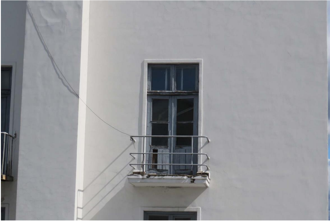
Фото 10. Дверной проем балкона уличного Ю-3 фасада основного объема здания. Дата съемки: 23.09.2021 г.
