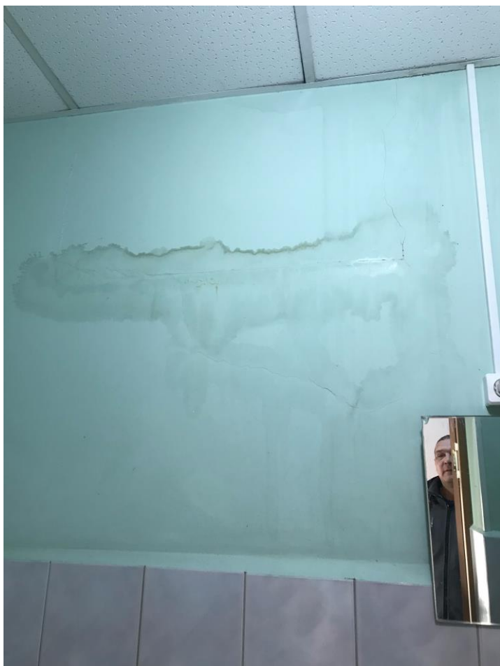
Фото 22. Следы протечек на стене санузла. 2 этаж.
