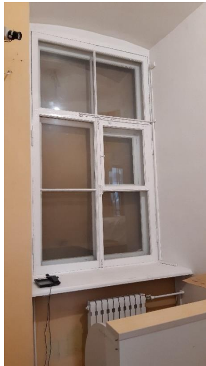
22. «Гатчинский дворец (с Арсенальным и Кухонным каре)», Ленинградская область, Гатчинский муниципальный район, г. Гатчина, Красноармейский пр., д. 1. Центральный корпус. Помещение №1. Фрагмент. Фото 29.11.2021г.
