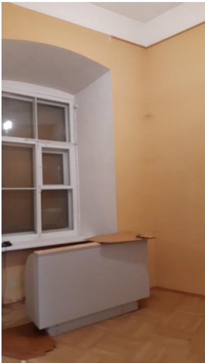
24. «Гатчинский дворец (с Арсенальным и Кухонным каре)», Ленинградская область, Гатчинский муниципальный район, г. Гатчина, Красноармейский пр., д. 1. Центральный корпус. Помещение №1. Фрагмент. Фото 29.11.2021г.
