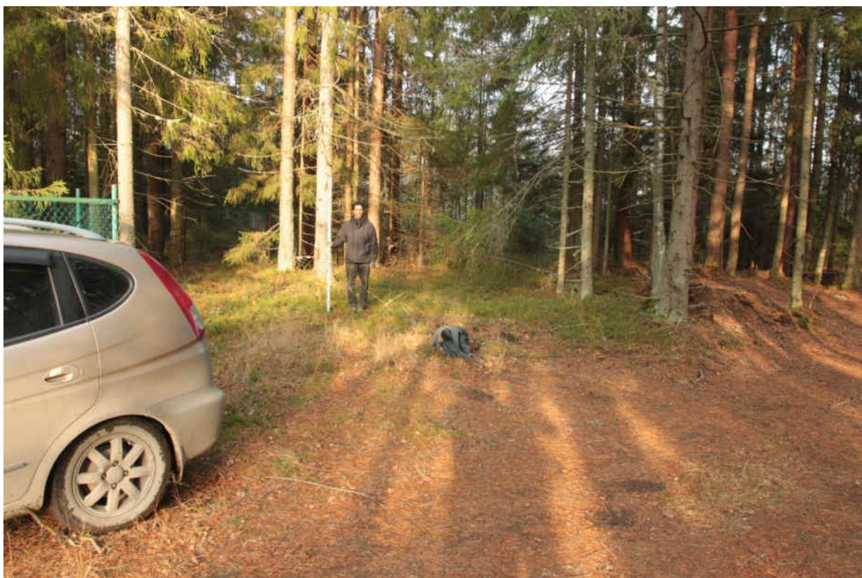
Рис. 335. «Распределительный газопровод по г.п. Свирьстрой Лодейнопольского района Ленинградской обл.» Шурф 59. Общий вид до начала работ. Вид на запад.
