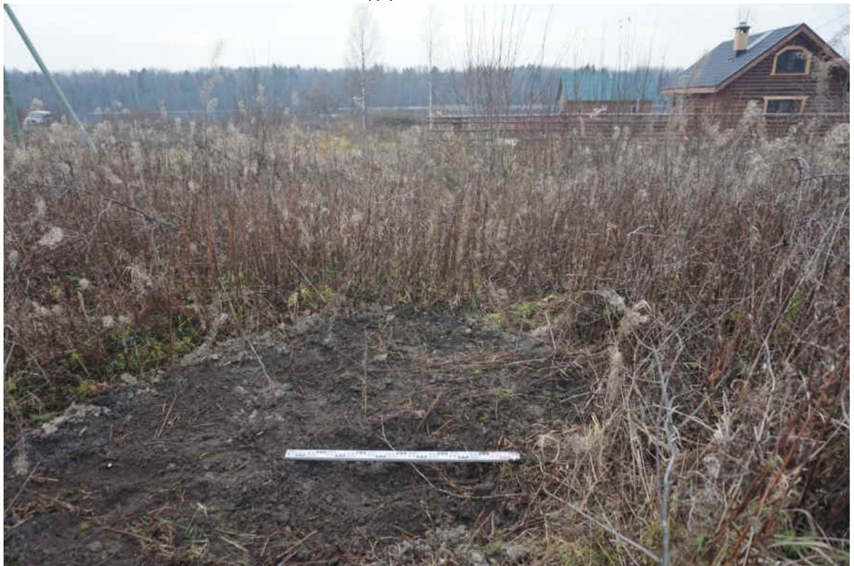
Рис. 49. «Распределительный газопровод по г.п. Свирьстрой Лодейнопольского района Ленинградской обл.» Шурф 1. Рекультивация. Вид на запад.
