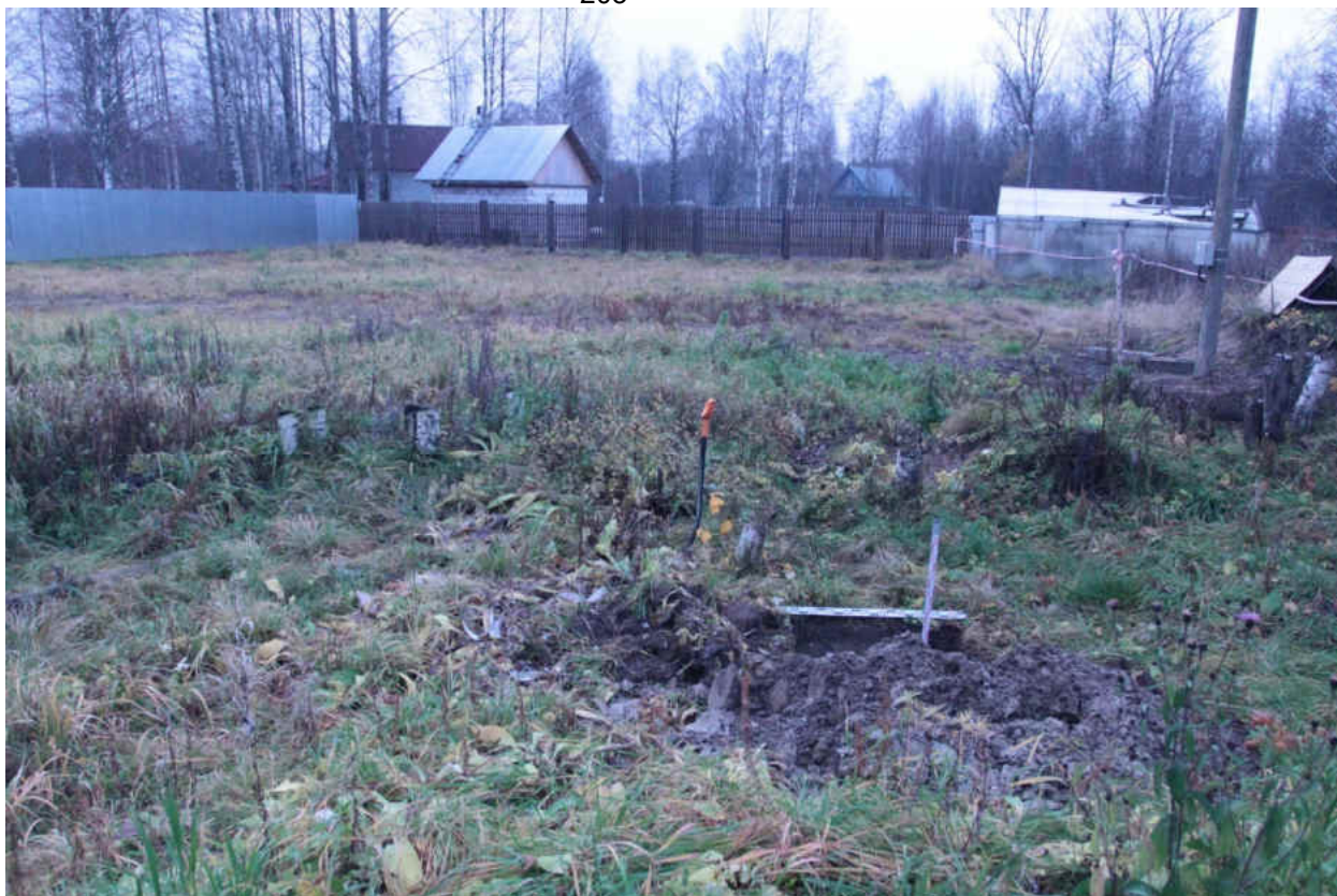
Рис. 113. «Распределительный газопровод по г.п. Свирьстрой Лодейнопольского района Ленинградской обл.» Шурф 14. Общий вид. Вид на запад.
