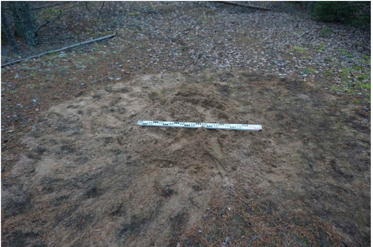
Рис. 172. «Распределительный газопровод по г.п. Свирьстрой Лодейнопольского района Ленинградской обл.» Шурф 25. Рекультивация. Вид на запад.
