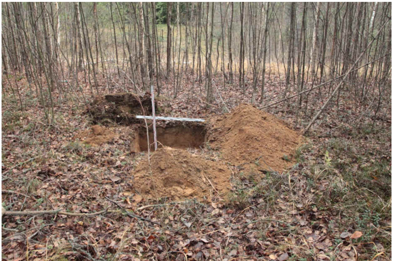
Рис. 205. «Распределительный газопровод по г.п. Свирьстрой Лодейнопольского района Ленинградской обл.» Шурф 32. Общий вид. Вид на восток.
