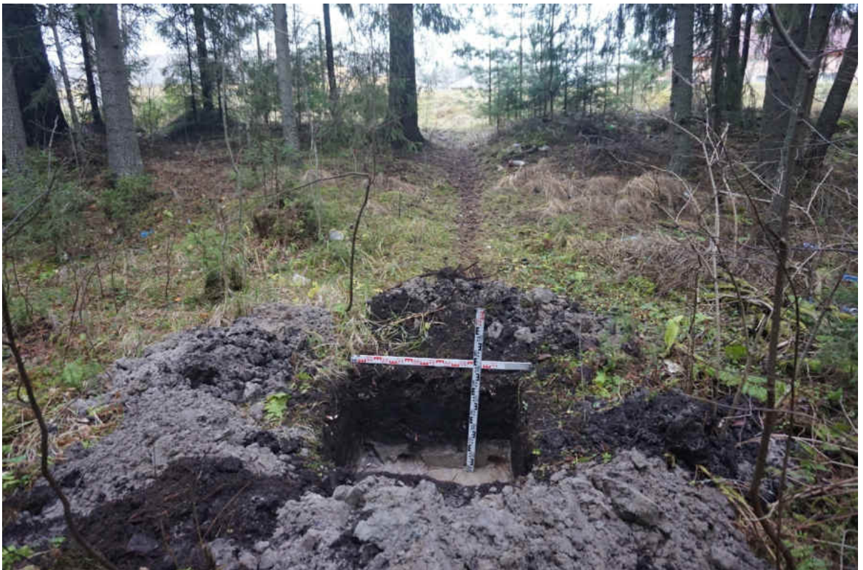
Рис. 263. «Распределительный газопровод по г.п. Свирьстрой Лодейнопольского района Ленинградской обл.» Шурф 44. Общий вид. Вид на запад.
