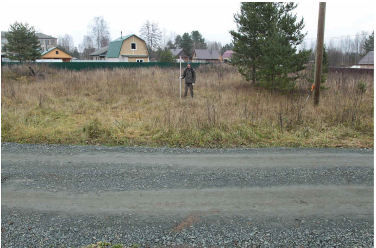
Рис. 173. «Распределительный газопровод по г.п. Свирьстрой Лодейнопольского района Ленинградской обл.» Шурф 26. Общий вид до начала работ. Вид на восток.
