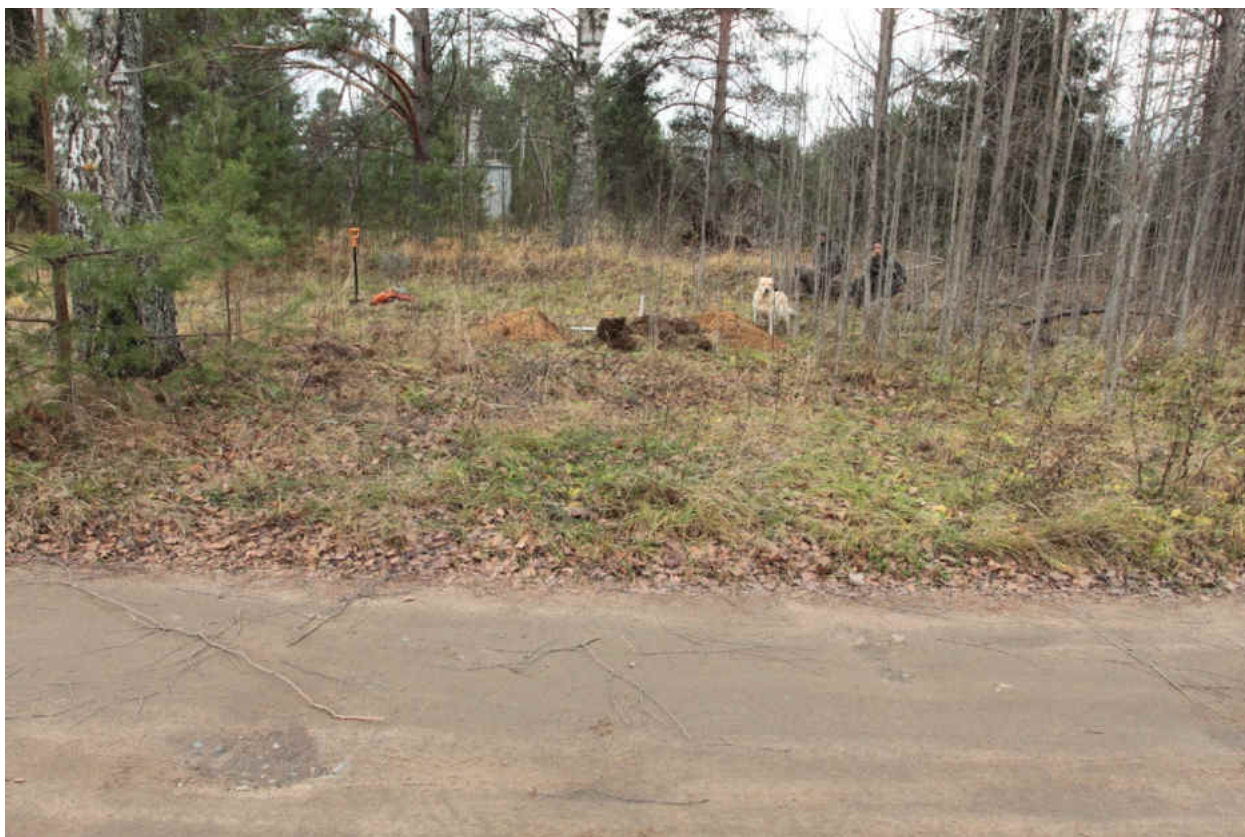
Рис. 225. «Распределительный газопровод по г.п. Свирьстрой Лодейнопольского района Ленинградской обл.» Шурф 36. Общий вид. Вид на север.
