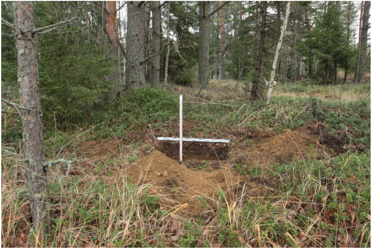
Рис. 220. «Распределительный газопровод по г.п. Свирьстрой Лодейнопольского района Ленинградской обл.» Шурф 35. Общий вид. Вид на восток.
