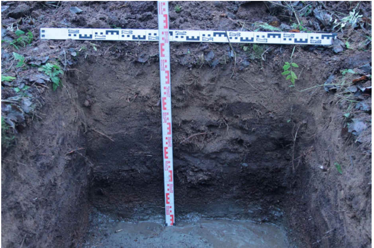
Рис. 109. «Распределительный газопровод по г.п. Свирьстрой Лодейнопольского района Ленинградской обл.» Шурф 13. Западная стенка. Вид на запад.
