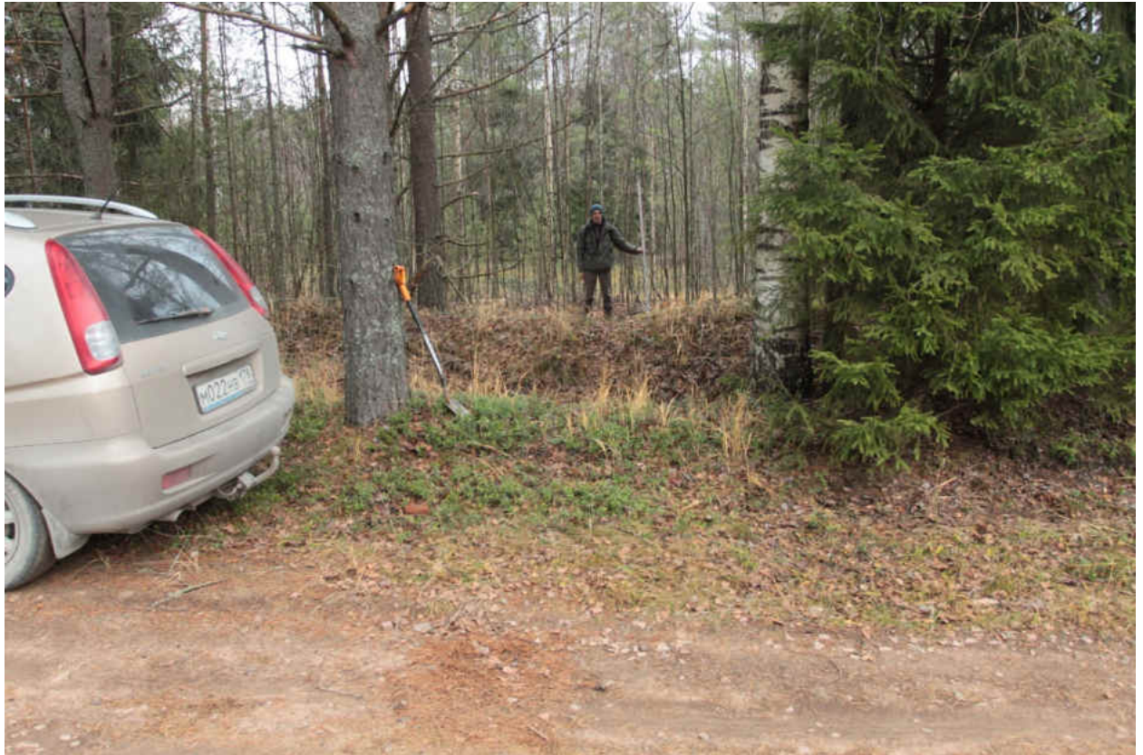
Рис. 204. «Распределительный газопровод по г.п. Свирьстрой Лодейнопольского района Ленинградской обл.» Шурф 32. Общий вид до начала работ. Вид на восток.
