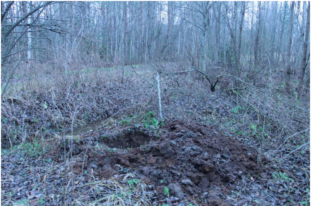
Рис. 106. «Распределительный газопровод по г.п. Свирьстрой Лодейнопольского района Ленинградской обл.» Шурф 13. Общий вид. Вид на юго-восток.
