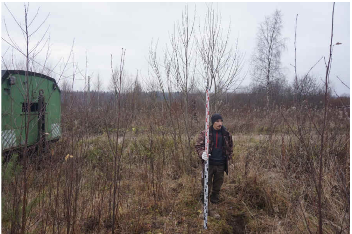
Рис. 50. «Распределительный газопровод по г.п. Свирьстрой Лодейнопольского района Ленинградской обл.» Шурф 2. Общий вид до начала работ. Вид на запад.
