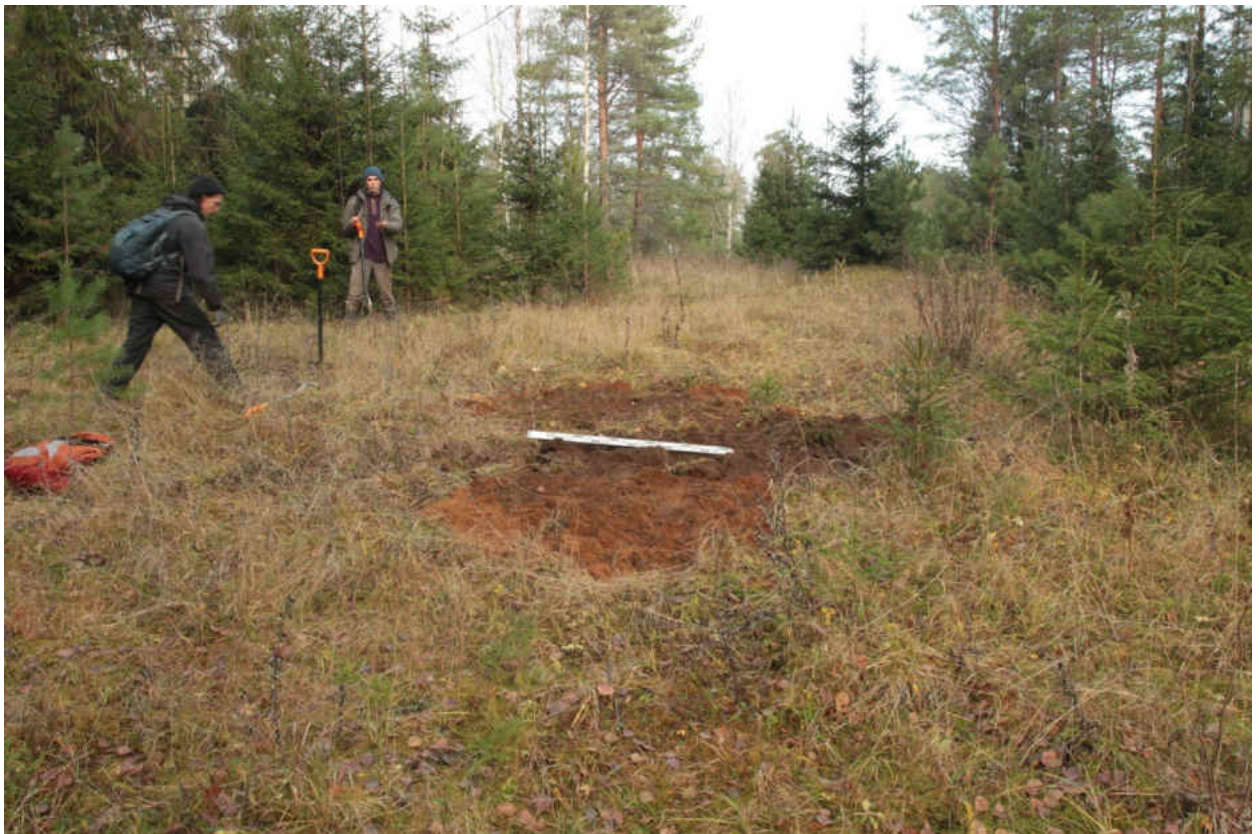
Рис. 261. «Распределительный газопровод по г.п. Свирьстрой Лодейнопольского района Ленинградской обл.» Шурф 43. Рекультивация. Вид на север.
