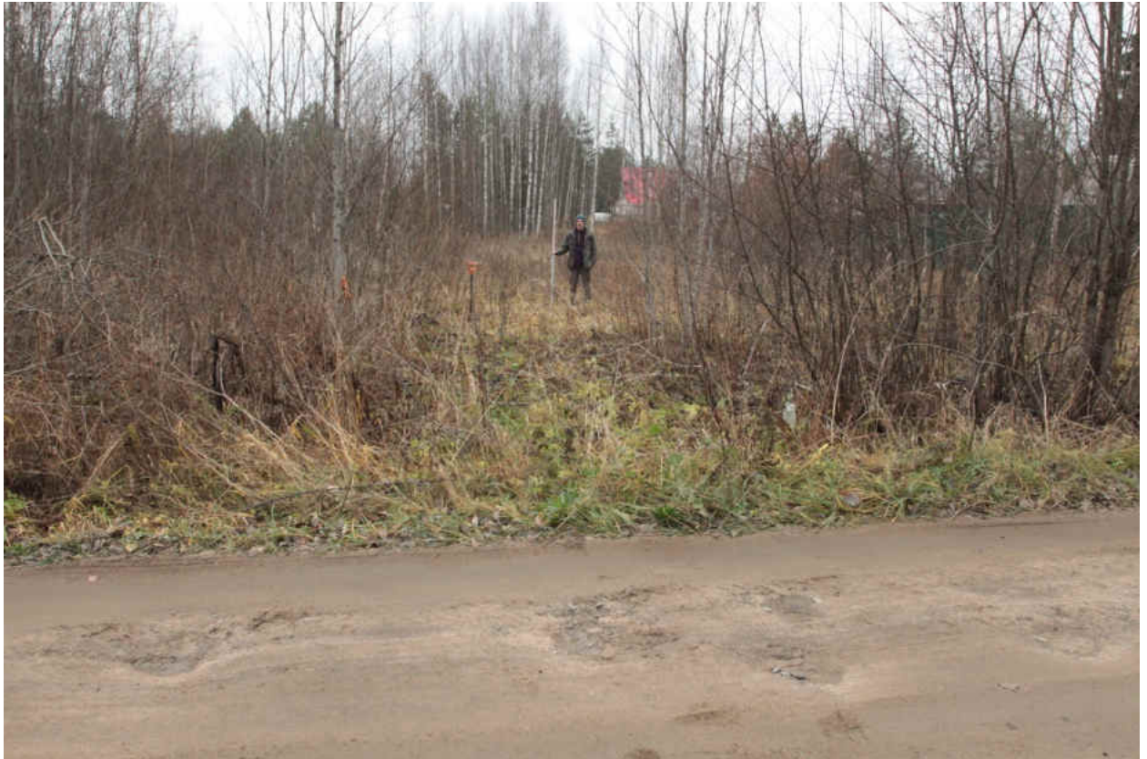
Рис. 194. «Распределительный газопровод по г.п. Свирьстрой Лодейнопольского района Ленинградской обл.» Шурф 30. Общий вид до начала работ. Вид на северо-запад.
