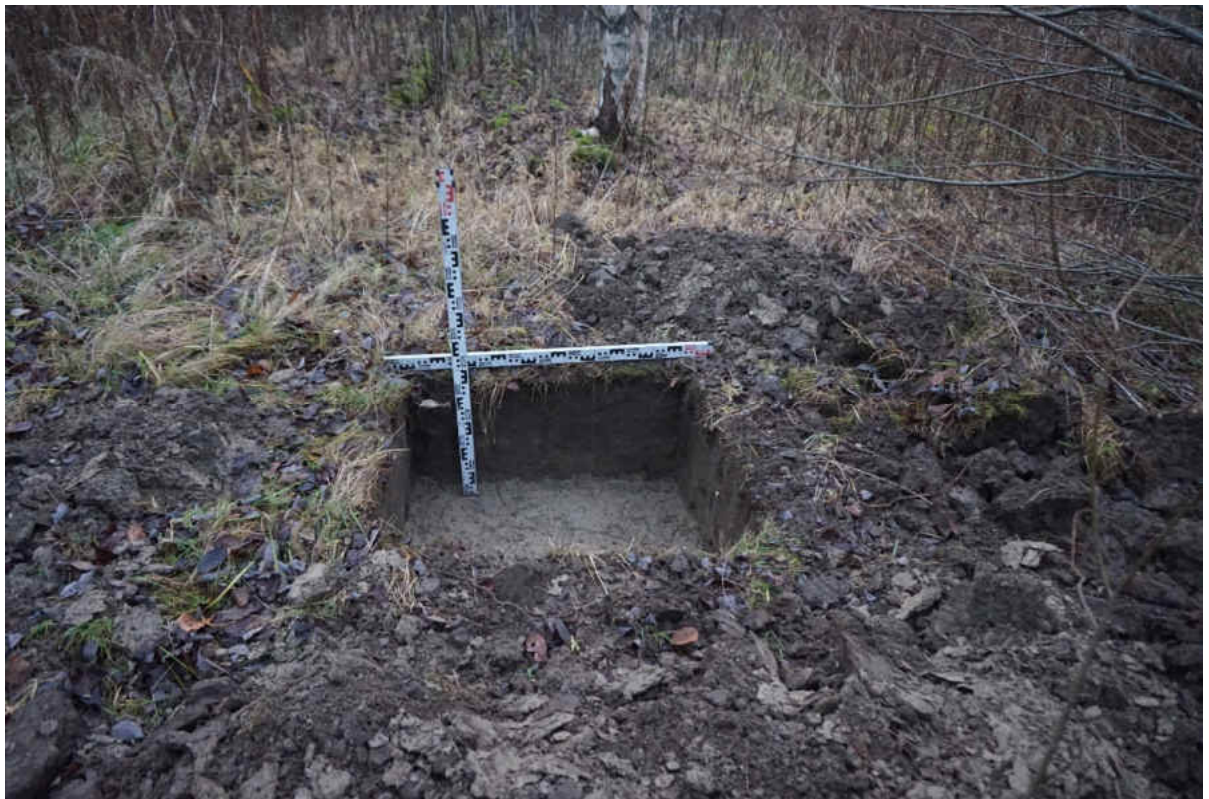
Рис. 96. «Распределительный газопровод по г.п. Свирьстрой Лодейнопольского района Ленинградской обл.» Шурф 11. Общий вид. Вид на запад.
