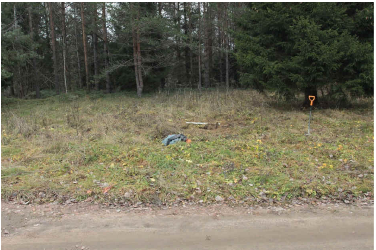
Рис. 213. «Распределительный газопровод по г.п. Свирьстрой Лодейнопольского района Ленинградской обл.» Шурф 33. Рекультивация. Вид на восток.
