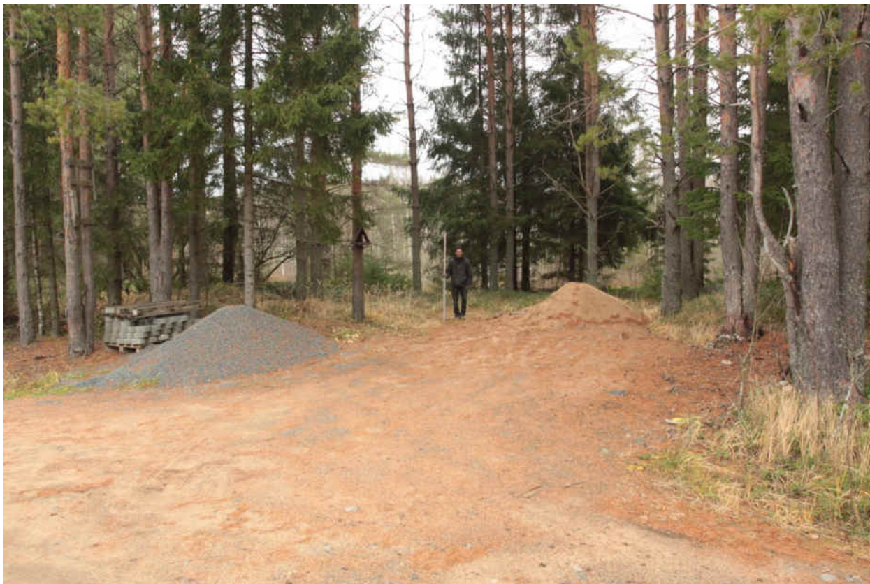
Рис. 214. «Распределительный газопровод по г.п. Свирьстрой Лодейнопольского района Ленинградской обл.» Шурф 34. Общий вид до начала работ. Вид на восток.
