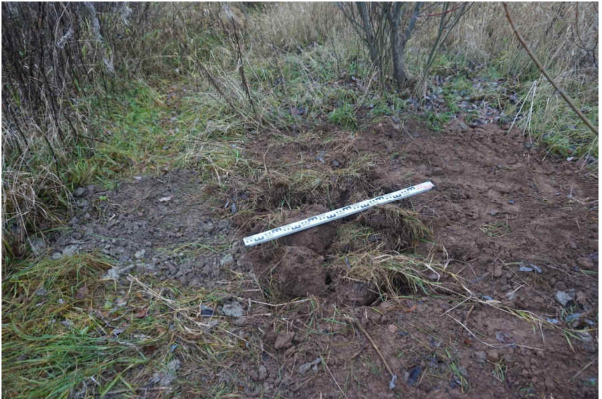
Рис. 131. «Распределительный газопровод по г.п. Свирьстрой Лодейнопольского района Ленинградской обл.» Шурф 17. Рекультивация. Вид на запад.
