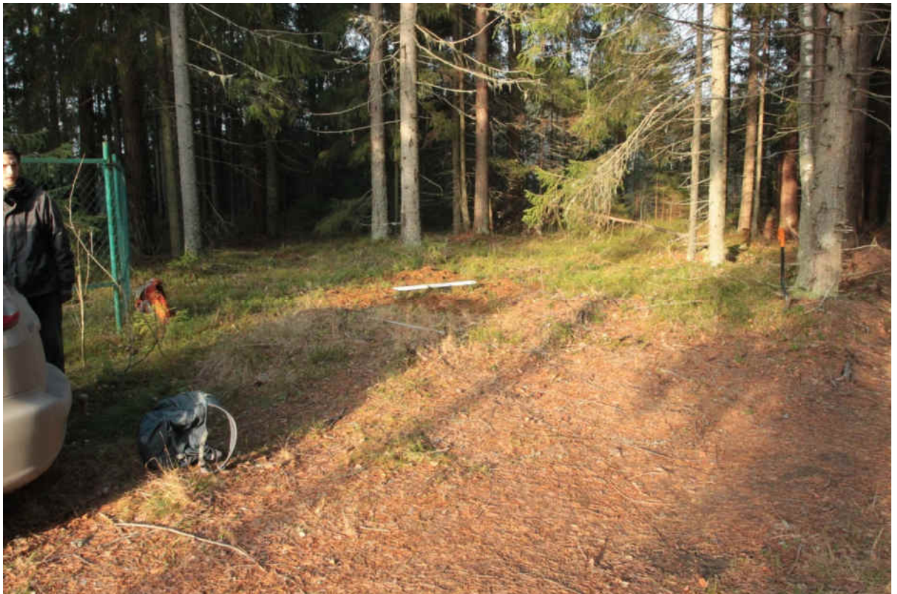
Рис. 339. «Распределительный газопровод по г.п. Свирьстрой Лодейнопольского района Ленинградской обл.» Шурф 59. Рекультивация. Вид на запад.
