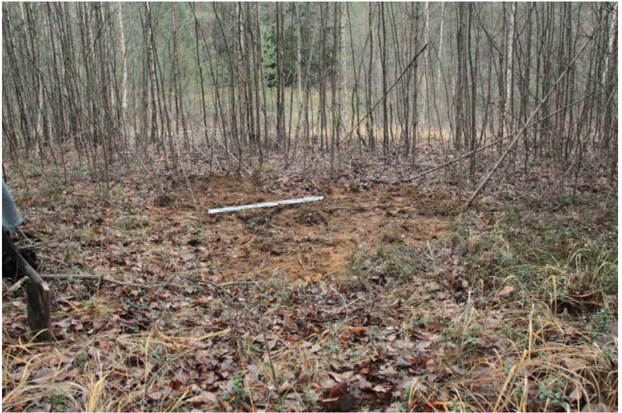
Рис. 208. «Распределительный газопровод по г.п. Свирьстрой Лодейнопольского района Ленинградской обл.» Шурф 32. Рекультивация. Вид на запад.
