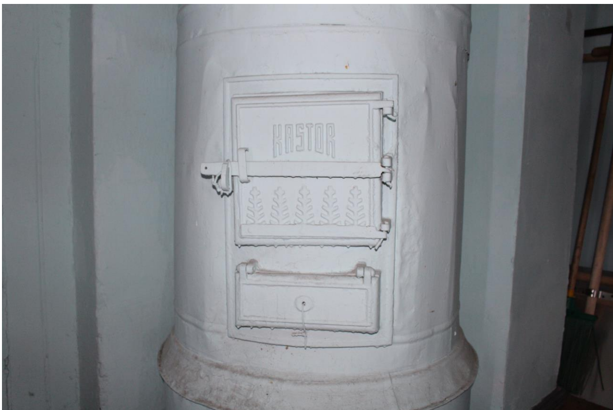
Фото 11. Вид на фурнитуру печи.
