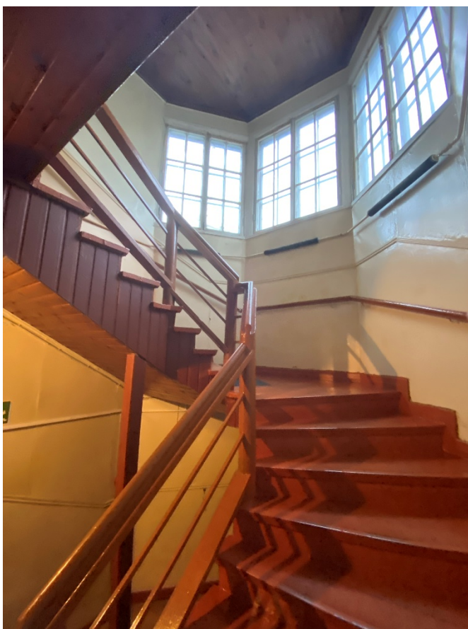
Фото 14. Деревянная лестница в уровне между 1-м и 2-м этажами. Вид с юга.
