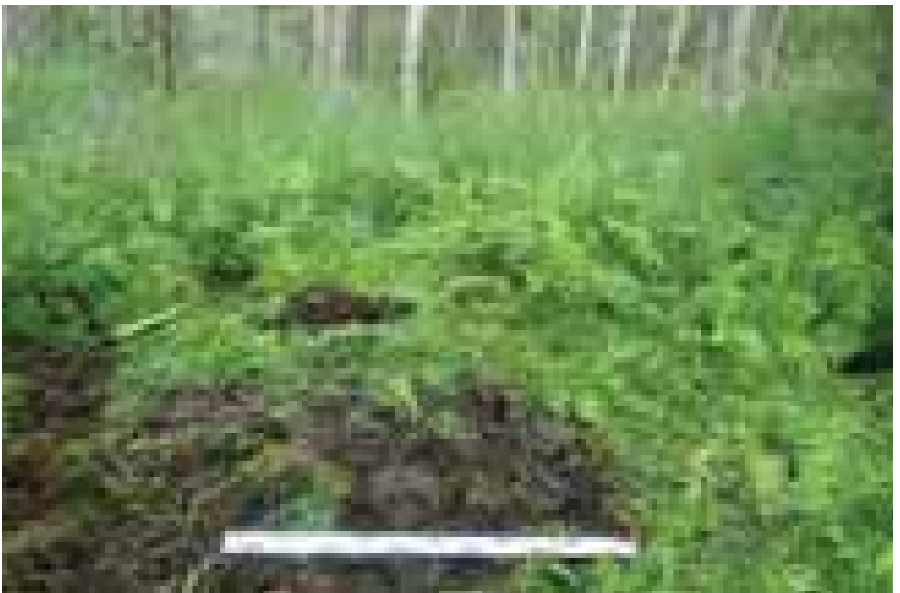
Илл. 236. Ленинградская область. Кингисеппский муниципальный район. «Проектируемое строительство трубопровода метанола от промышленной площадки ООО «ПГ «Фосфорит» до терминала «ЕвроХим терминал Усть-Луга». Шурф №25. Рекультивация. Вид с юга. 417
