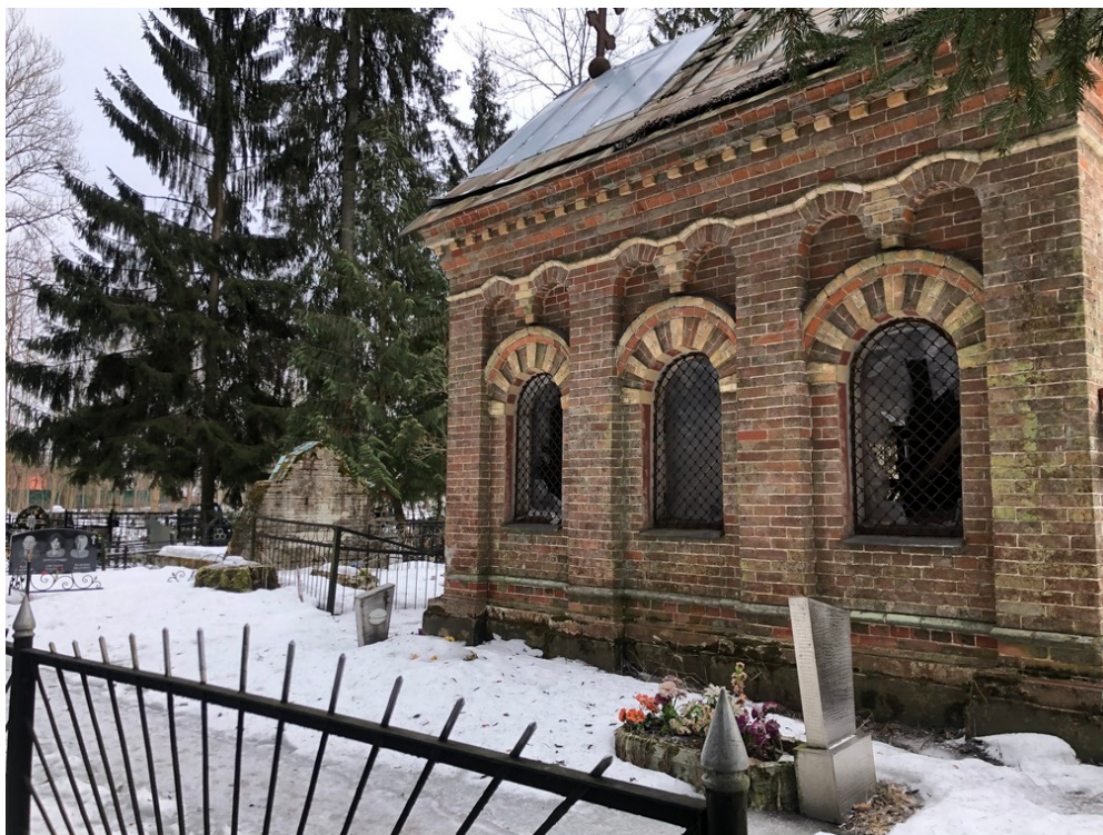
22. Село Рождествено. Вид на склеп перед церковью в сторону юго-востока. 15.03.2021. Фото:Петухова Н.М.
