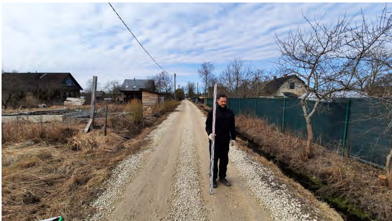
Илл.92. Ленинградская обл, Гатчинский р-н, д. Мыза-Ивановка-2021. Точка фотофиксации 44. Вид с В.
