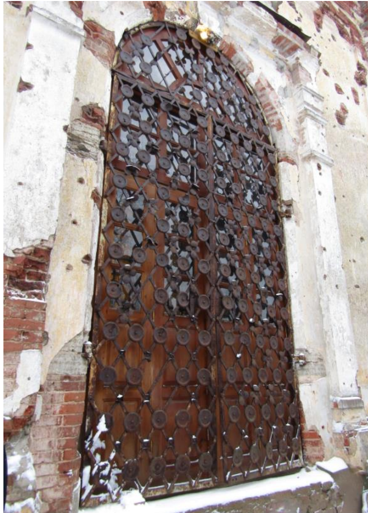
Фото.9. Церковь Иова Многострадального. Северный фасад, ставни металлические северного входа. Фрагмент.
