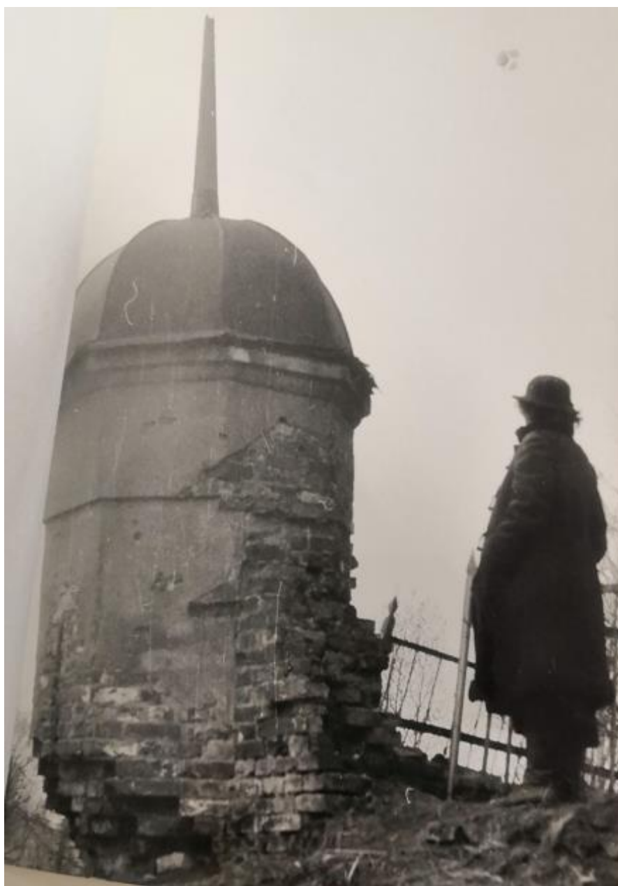
Илл.36. Историческое кладбище. Юго-восточная башня ограды. Утрата опорной части башни. 1989 г. // Архив Комитета по сохранению культурного наследия Ленинградской области. Д. 699-3.
