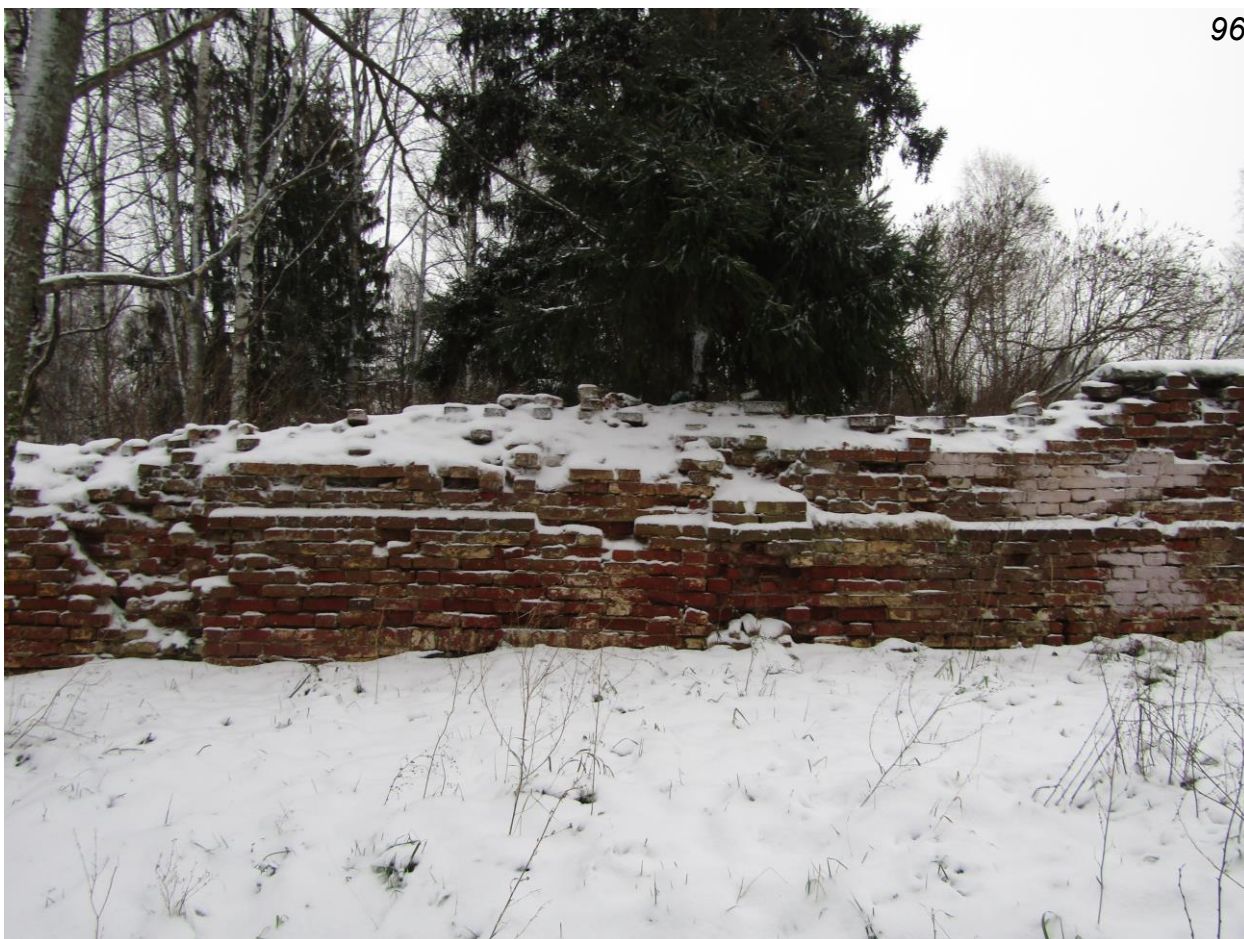
Фото.38. Вид на ограду кладбища. Стена.
