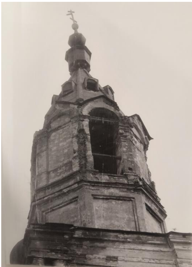
Илл.28. Церковь Иова Многострадального. Колокольня, вид с запада. 1989 г. // Архив Комитета по сохранению культурного наследия Ленинградской области. Д. 699-3.
