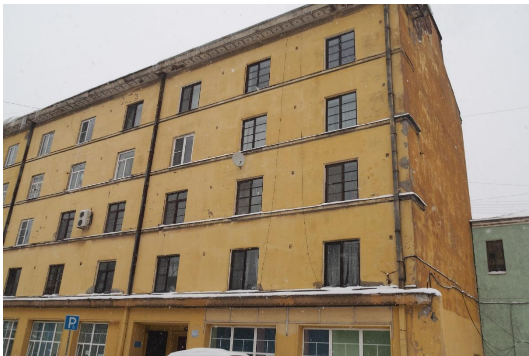
1. «Жилой дом», Ленинградская область, Выборгский район, г. Выборг, ул. Куйбышева, д. 7. Северо-западный фасад. Общий вид. Фото 14.01.2022г.
