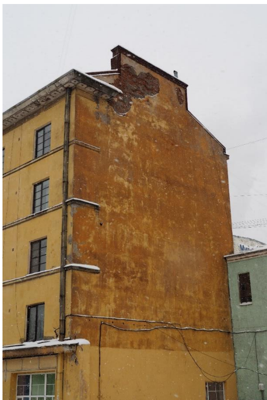
5. «Жилой дом», Ленинградская область, Выборгский район, г. Выборг, ул. Куйбышева, д. 7. Южный фасад. Фрагмент. Фото 14.01.2022г.
