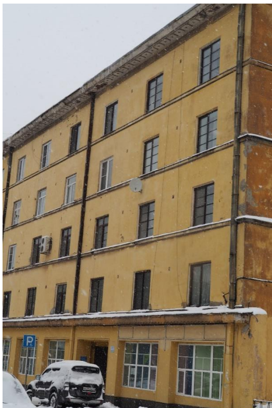
6. «Жилой дом», Ленинградская область, Выборгский район, г. Выборг, ул. Куйбышева, д. 7. Северо-западный фасад. Фрагмент. Фото 14.01.2022г.
