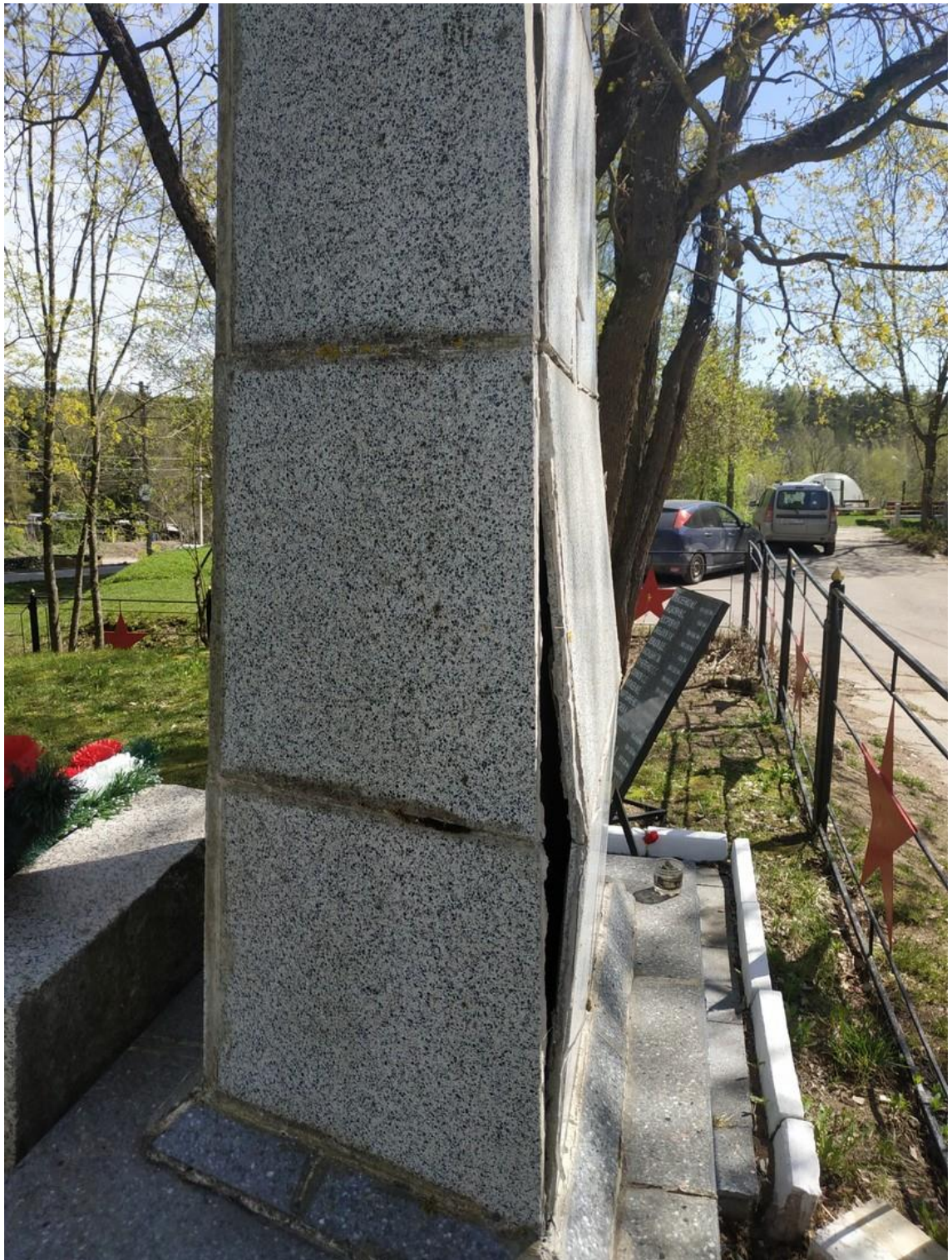
12. Отслоение поздней гранитной облицовки обелиска, разрушение бордюра (вид с севера).
