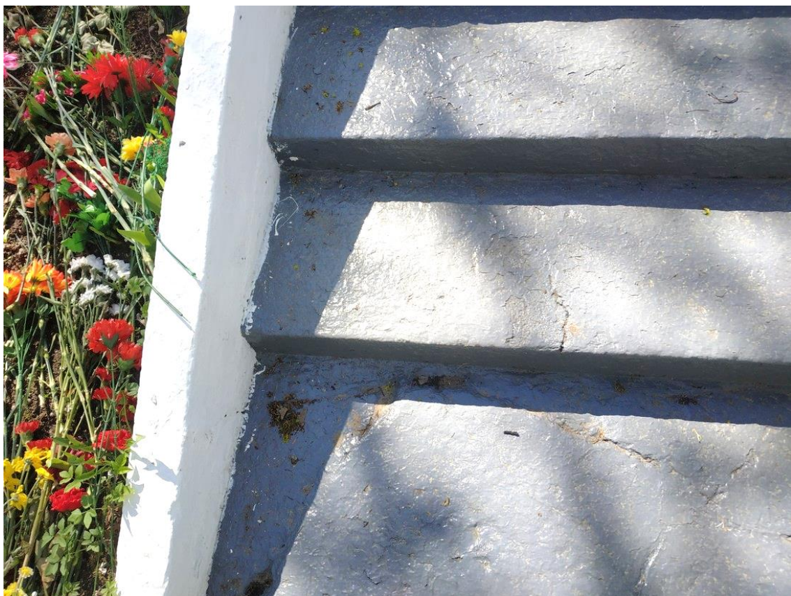
15. Ступени бетонных лестниц имеют трещины, выбоины, биопоражения; многослойно окрашены.
